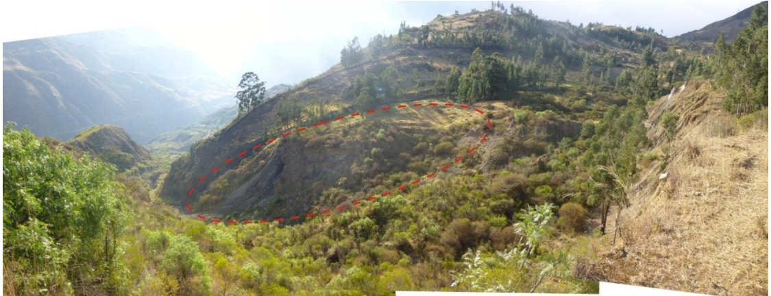
Foto 31. Parte inferior extrema, zona inestable. En la zona enmarcada de color rojo, se están formando agrietamientos del terreno.
