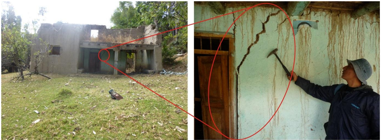
Fotos 27 y 28. Reactivaciones en el sector de Rosagagra, viviendas afectadas.
