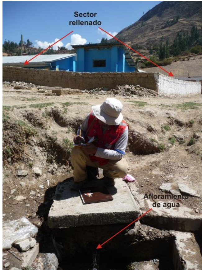
Foto 18. Filtraciones de agua en el sector de Musga.
