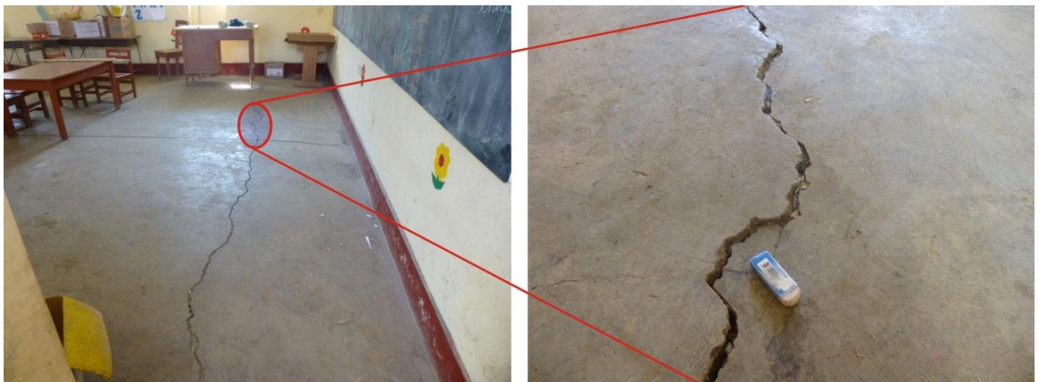
Foto 29 y 30. En la vista de la izquierda se aprecia el agrietamiento del piso. En la izquierda los desplazamientos milimétricos.
