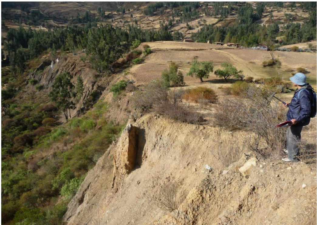
Foto 32. Pared formada por el desplazamiento del deslizamiento, zona inestable.
