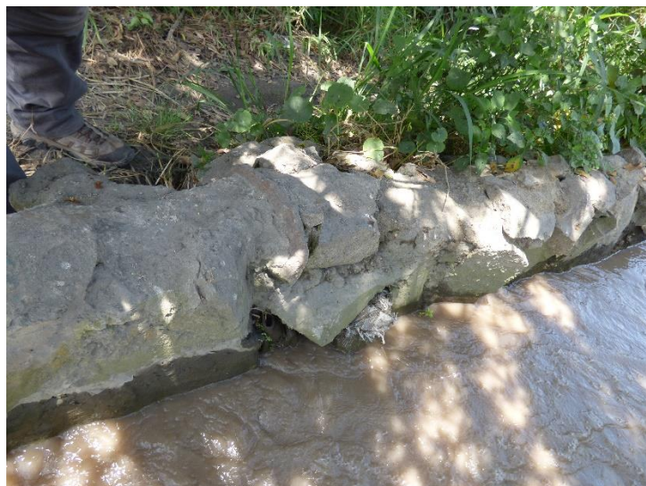
Fotografía 6: Detalle del estado en que se encuentran algunos sectores del canal de mampostería, con grietas que producen la fuga de agua.
