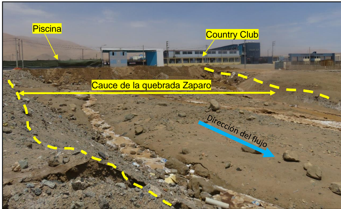
Figura 12. Muestra infraestructura urbana construida en la parte baja del cauce de la quebrada Zaparo. Los cuales fueron afectados por el flujo de detritos del 23 de enero del presente año.
