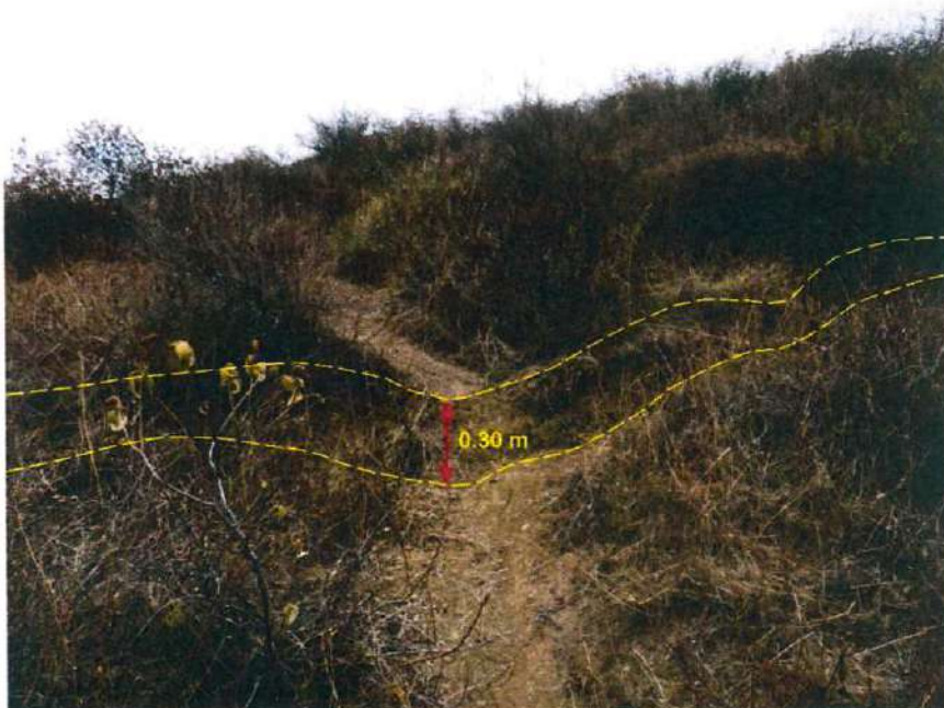
Figura 19: Vista con dirección al noreste donde se puede observar el salto en el terreno del orden de los 0.30 m, por la posible presencia de un deslizamiento con actividad confinada.
