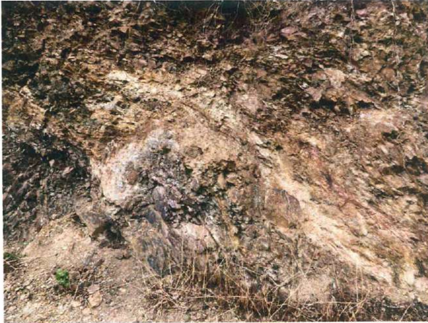
Fotografía 8: En la vista se puede observar el sustrato de arcillitas negras muy fracturado.
