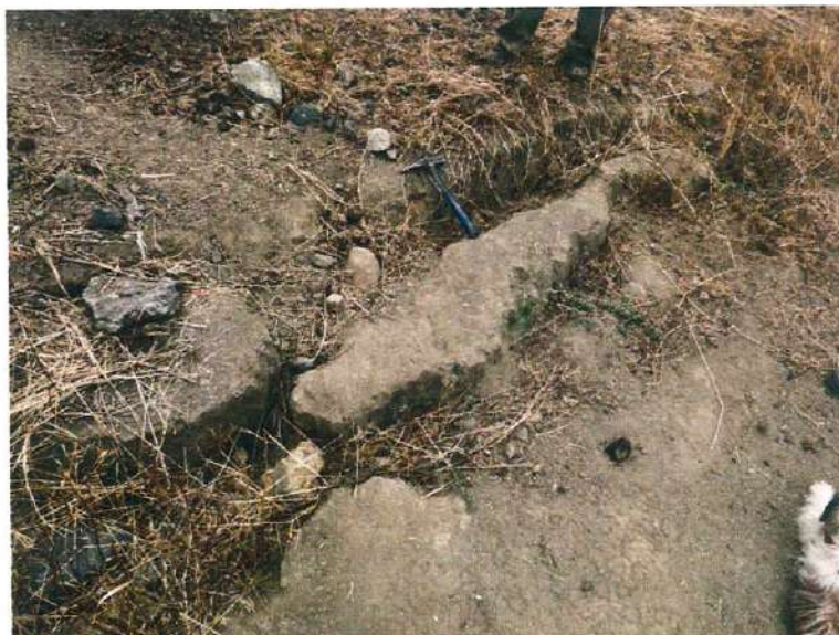
Fotografía 13: Vista en la que se puede observar el agrietamiento y basculamiento del suelo a consecuencia de la ocurrencia de la grieta G3.
