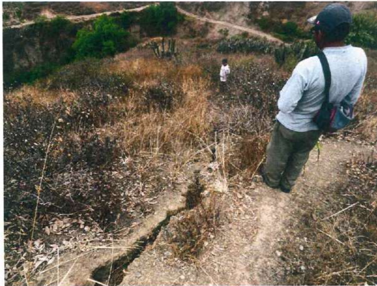
Fotografía 7: Grieta ubicada por detrás de la corona del deslizamiento rotacional D4, presenta una abertura de 0.20 m.
