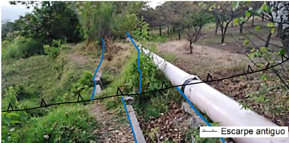
Figura 18. Canal de riego desplazado por el cuerpo del deslizamiento.
