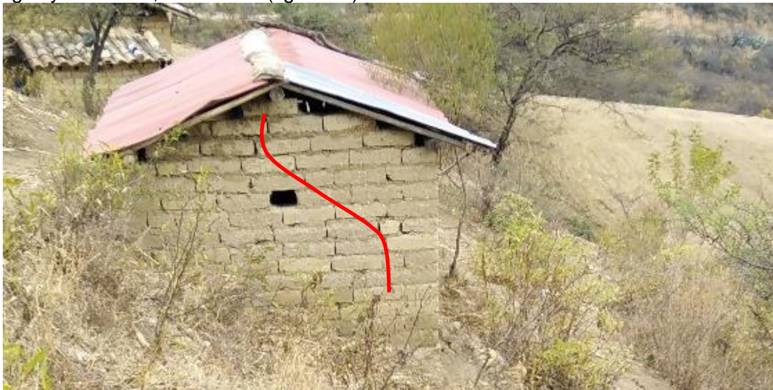
Figura 26. Vivienda ubicada afectada deslizamiento.
