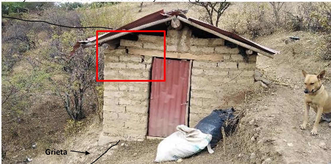
Figura 16. Vivienda de abobe con evidencias de separación de juntas y vigas.
