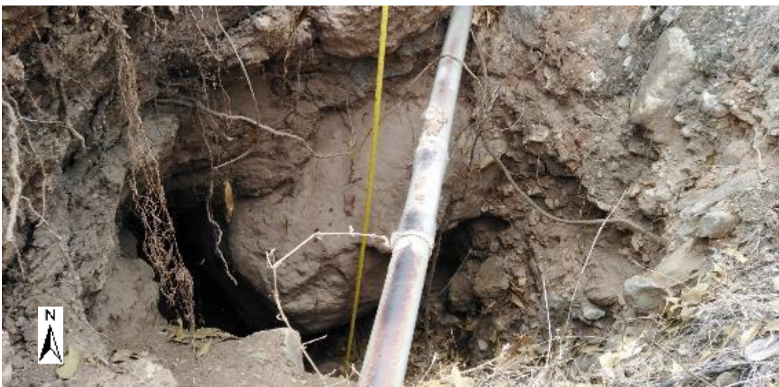
Figura 24. Cárcava que afecta a conexiones de agua.
