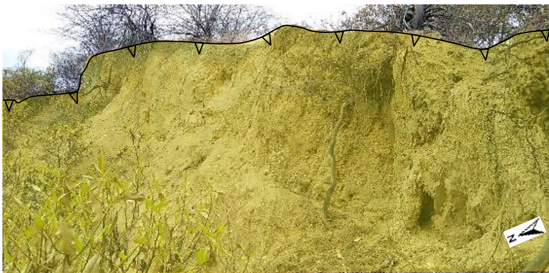
Figura 15. Escarpe principal de deslizamiento de hasta 2 m de alto.
