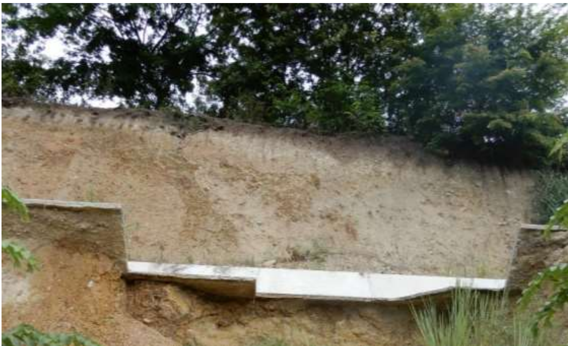
Figura 06. Cortes de talud expuestos debido a los deslizamientos próximas al área urbana.
