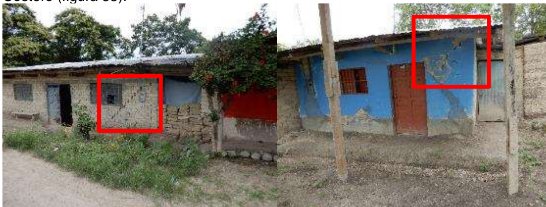
Figura 38. Viviendas afectadas por agrietamientos en paredes.
