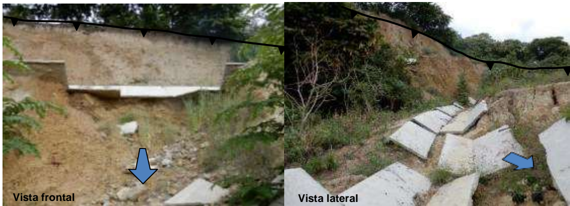
Figura 24. Vistas del escarpe principal y el canal de concreto destruido debido al desplazamiento de los materiales.
