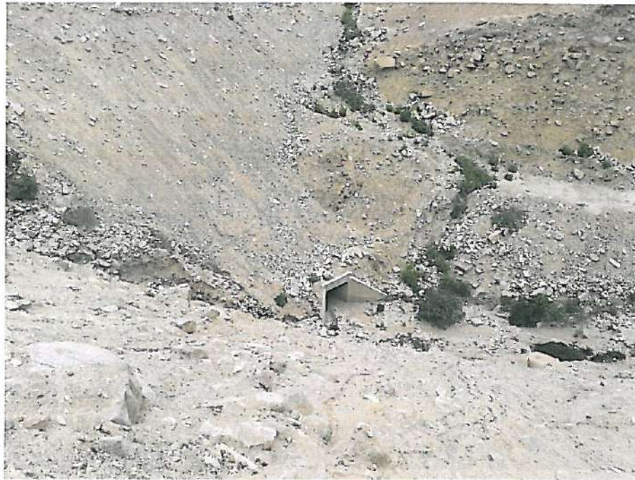
Figura 51: Sistema de drenaje de la quebrada N° 1.
