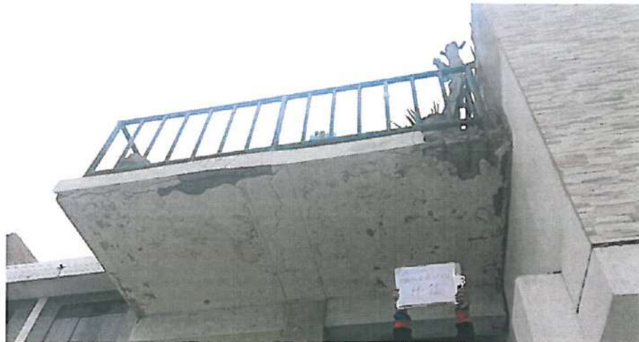
Figura 133: Deficiencias estructurales en la manzana H11.
