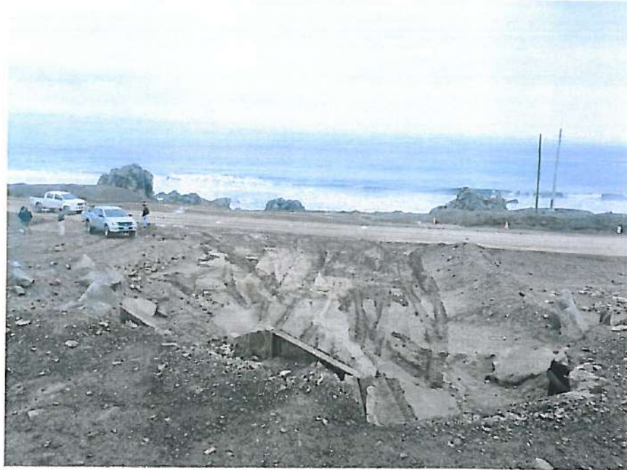
Figura 107: Flujos de lodo que afectan a la carretera Costanera Norte.
