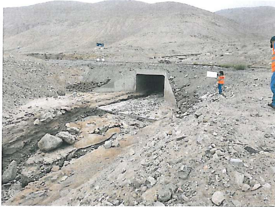
Figura 91: sistema de drenaje con evidencias de socavación
