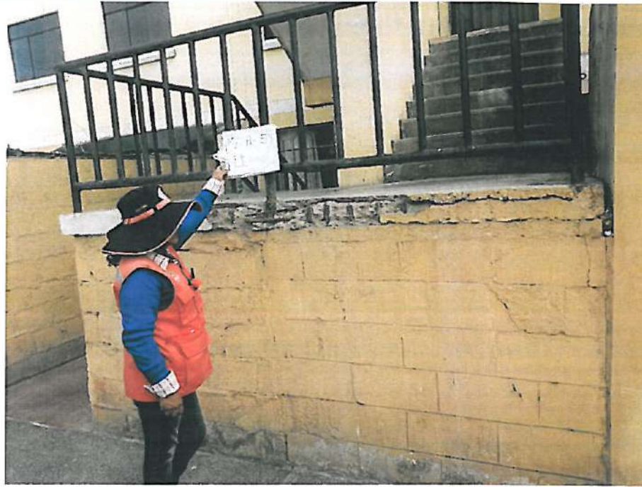
Figura 134: deficiencias estructurales en la manzana H53.
