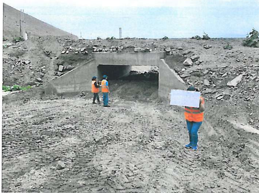
Figura 73: Trabajos de limpieza que es necesario culminar.
