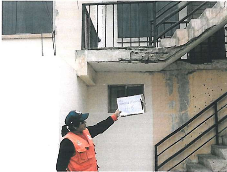
Figura 132: Deficiencias estructurales en la manzana H6.
