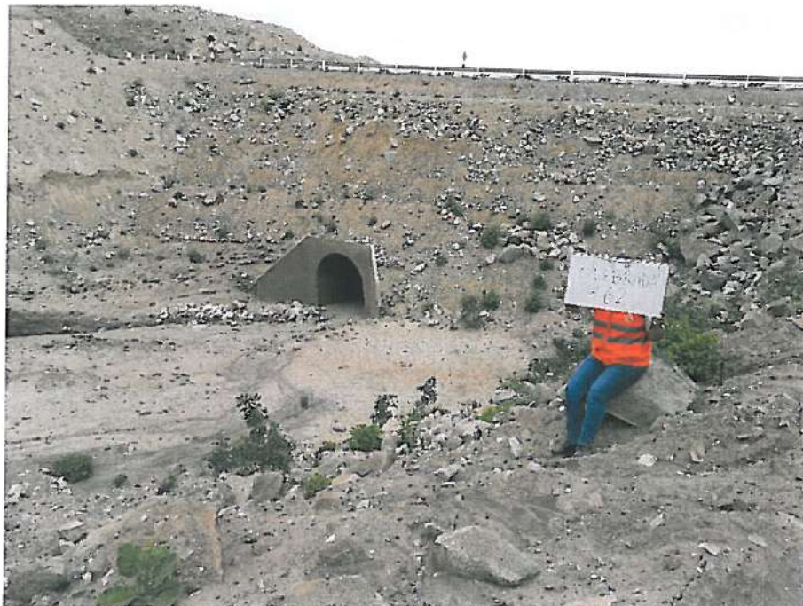
Figura 54: Sistema de drenaje de la quebrada.
