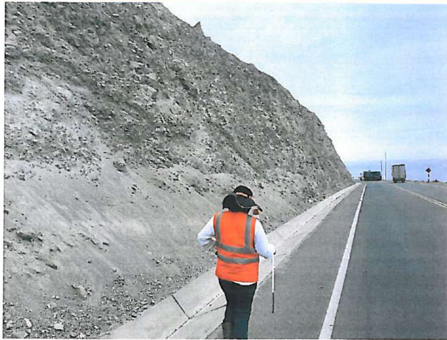
Figura 43: Zona de deslizamiento cerca a la playa Wawaquiqui.
