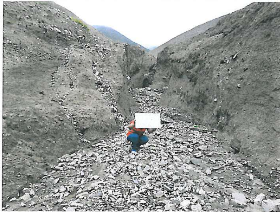
Figura 70: Socavación en el canal principal de la quebrada
