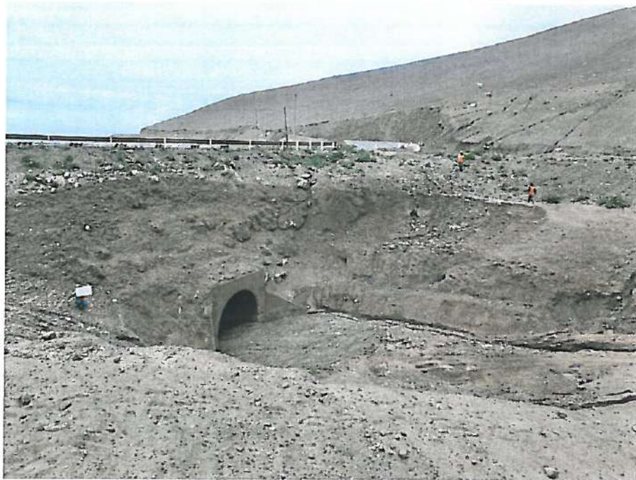
Figura 75: Sistema de drenaje con material de arrastre.
