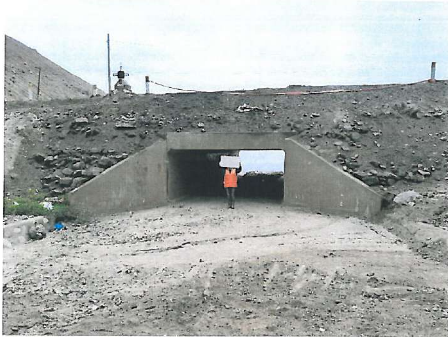
Figura 85: Sistema de drenaje en perfecto estado
