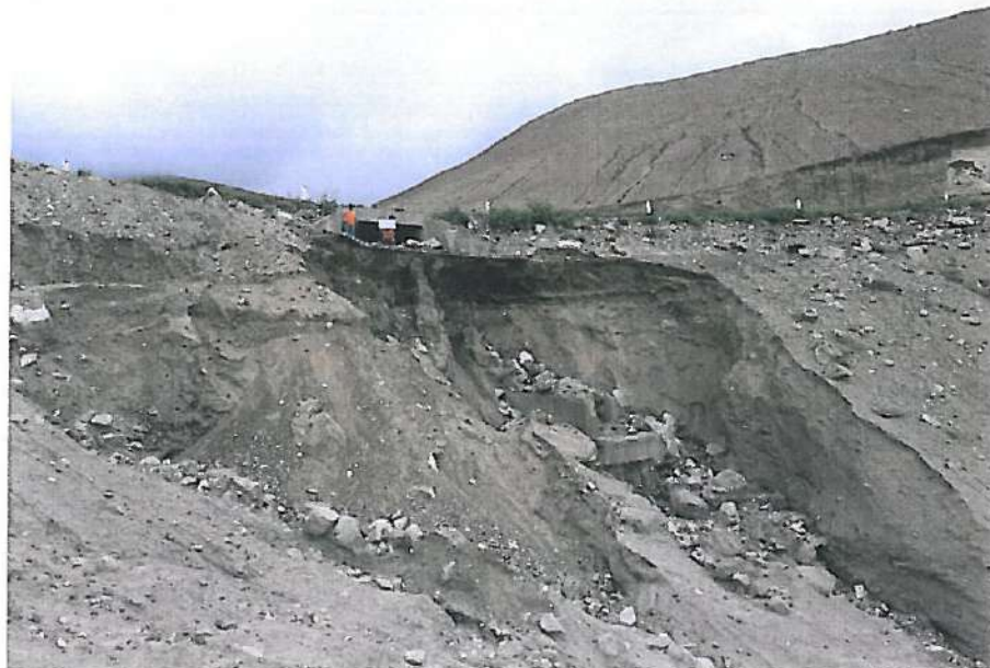
Figura 72: Daños en la sub base del sistema de drenaje.
