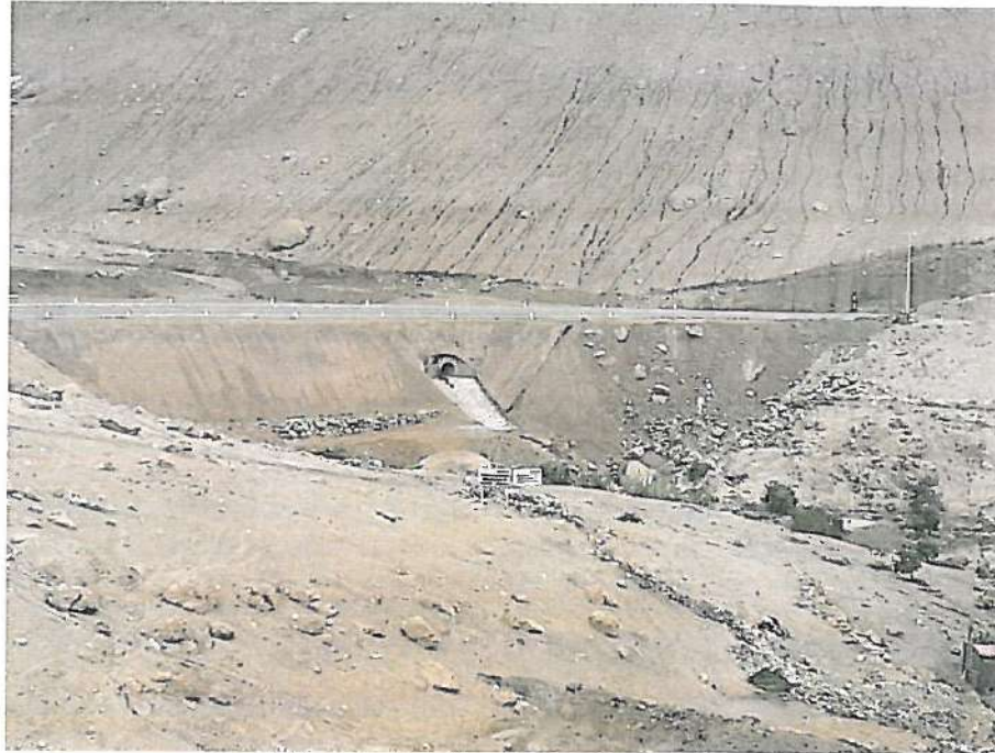
Figura 141: zona de deslizamiento en la playa Platanales.
