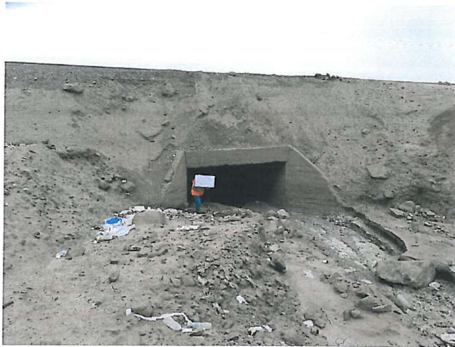
Figura 95: Sistema de drenaje que necesita ser limpiado.
