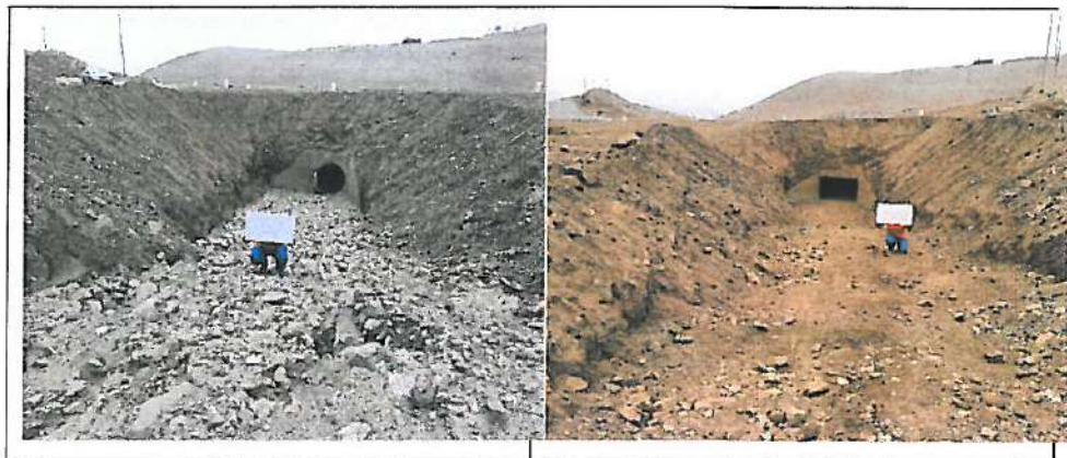
Figura 80: sistema de drenaje, trabajo que necesita ser reforzado.
