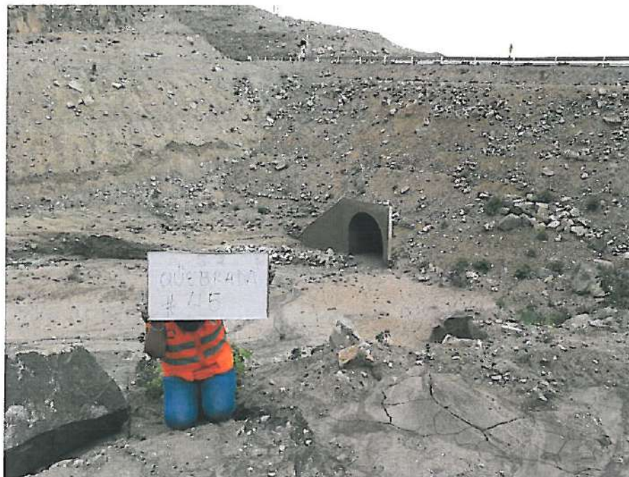
Figura 64: Quebrada N° 8, sistema de drenaje.
