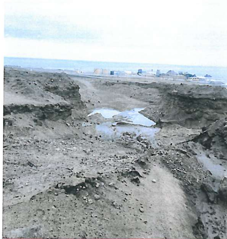
Figura 113: Sistema de drenaje con flujos de lodo.
