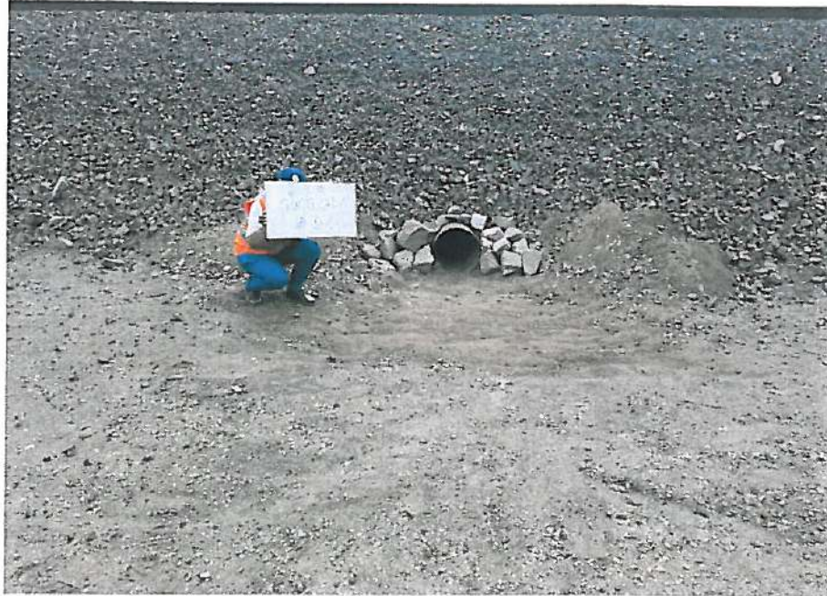
Figura 111: Sistema de drenaje de la quebrada.
