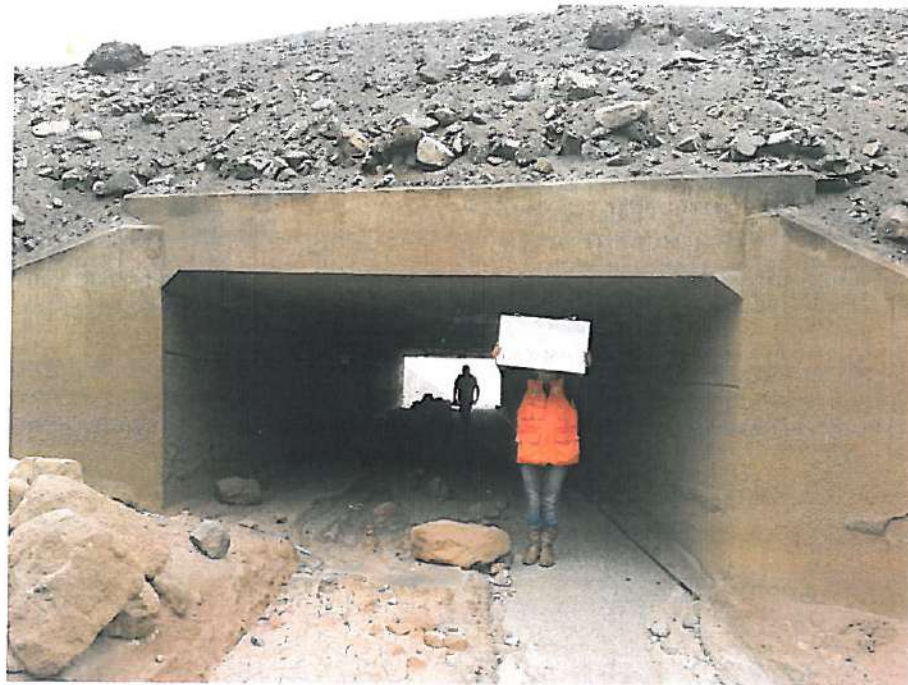
Figura 88: Vista panorámica del sistema de drenaje.
