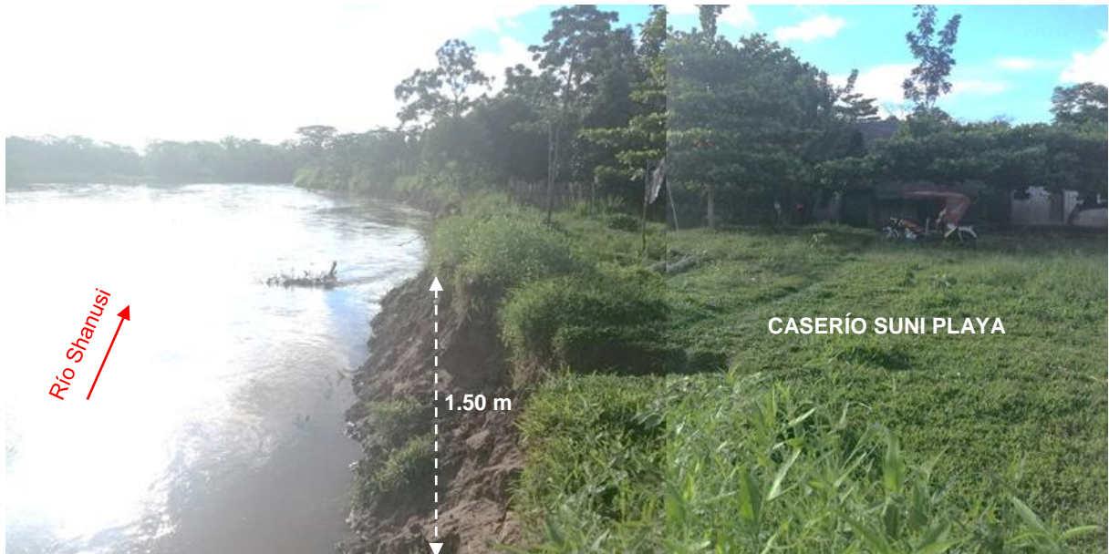
Figura 9: Extremo sur del caserío Suni Playa, en cuya ribera se observa erosión fluvial que ha generado el retroceso de la ribera tierra adentro. La altura del espejo de agua del río respecto a la ribera es de 1.50 m en promedio.
