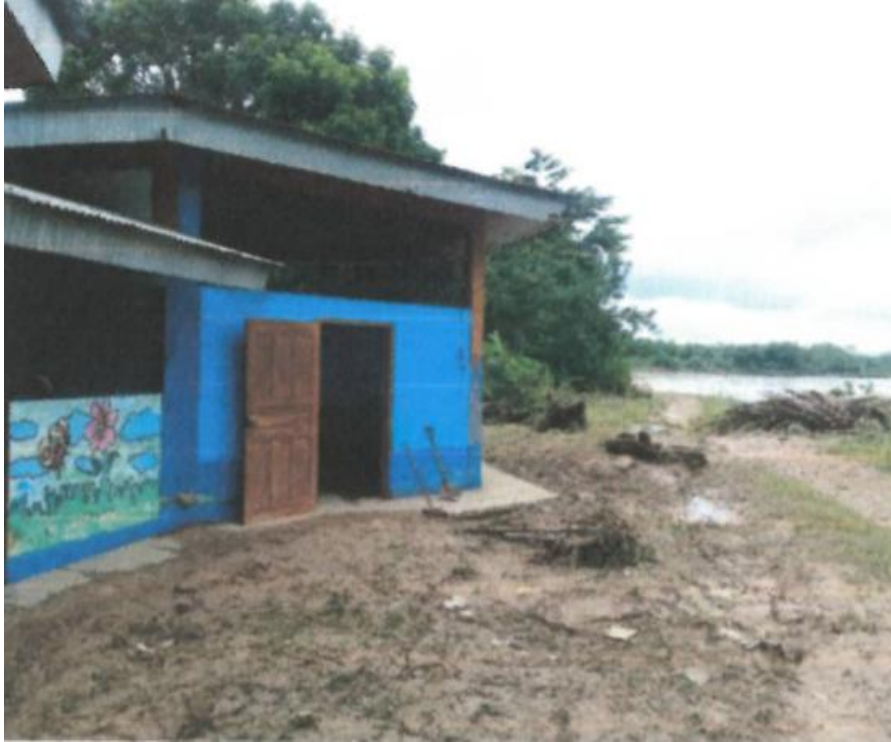
Fotografía 4: Institución educativa inicial N° 78, afectada por inundación. Fuente: Saavedra, 2018.
