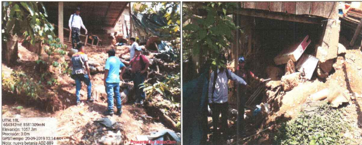
Fuente : Diagnostico de campo donde se visualiza el deslizamiento e la quebrada donde actualmente esta ubicado el C.P. de Betania.
