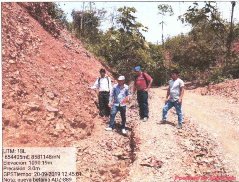
Imagen N° 3.8: Deslizamiento en la Carretera en trayecto de la Carretera- Palestina Alta – palestina Baja- Nueva Betania.
