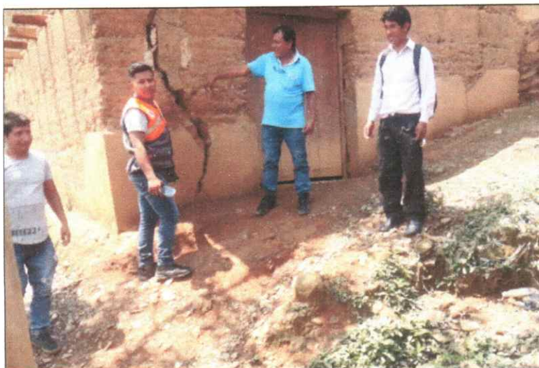
Imagen N° 3.6: Presencia de grietas de corona, con movimiento vertical por encima de la escarpa principal del deslizamiento, y los agrietamientos de las paredes.
