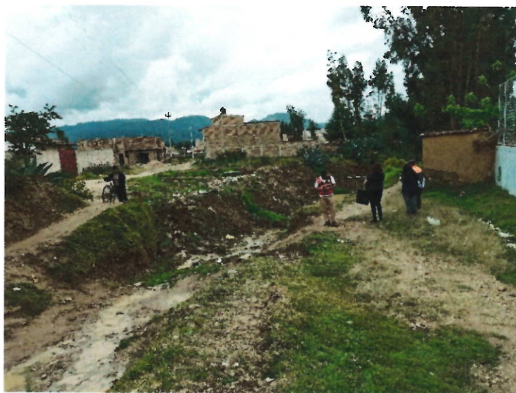
Fotografía 5. Punto de inspección N° 2, parte baja de la I.E. Julio Ramón Riveiro.
