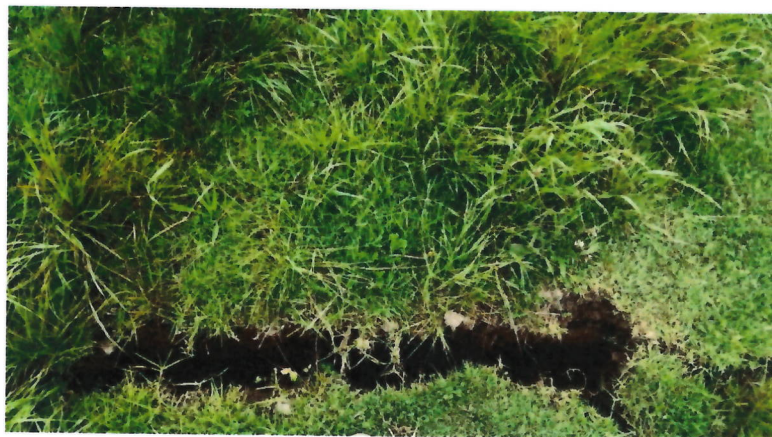
Fotografía 3. Presencia de grietas con mayor pronunciamiento en las partes laterales del escarpe,
