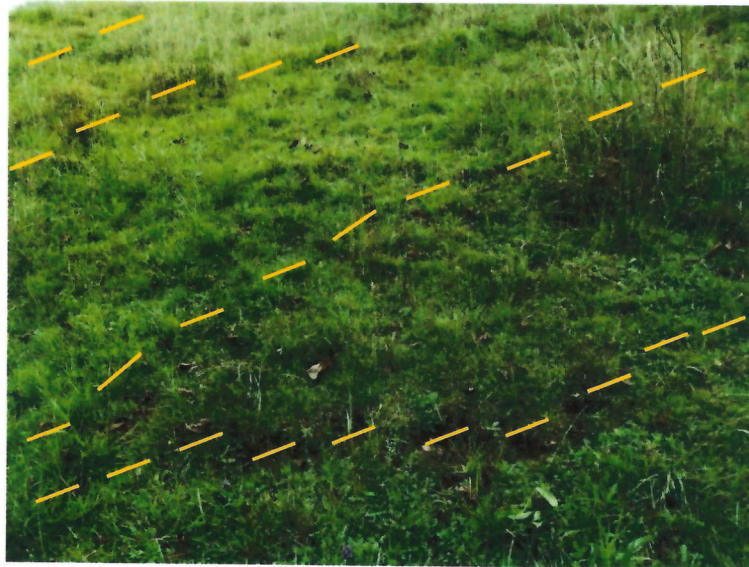
Fotografía 2. Presencia de grietas en el terreno donde se ha originado el deslizamiento.
