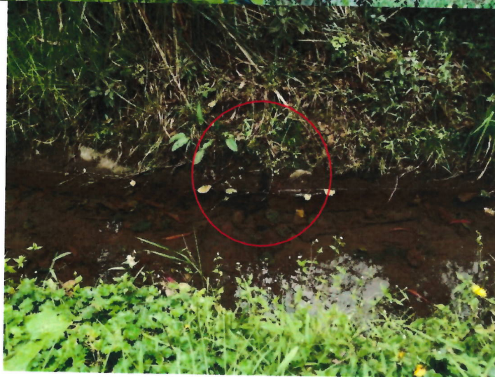
Fotografía 7. Canal de regadío Lirio Cochán Bajo en mal estado.
