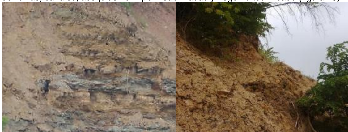
Figura 28 (a). Limoarcillitas, limolitas, areniscas y margas con humedad media a alta. (b) Materiales arcillosos que constituyen los primeros metros de suelos de cimentación.
