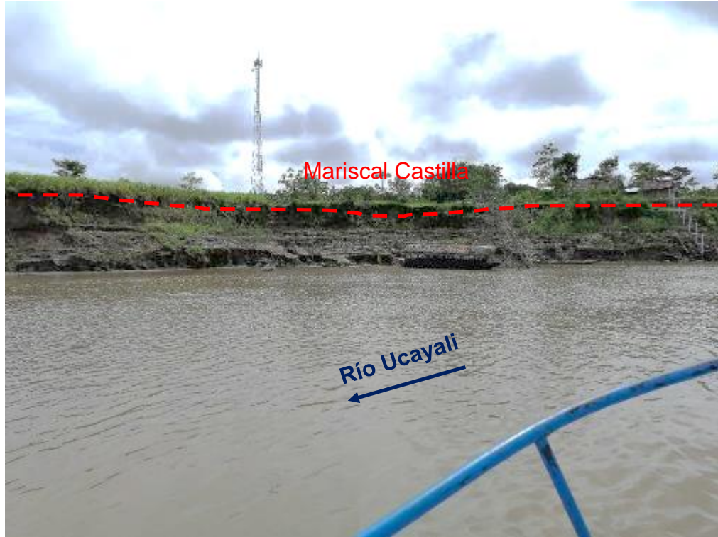
Figura 12: Vista frontal del puerto de acceso a la localidad de Mariscal Castilla. Presenta erosión fluvial.
