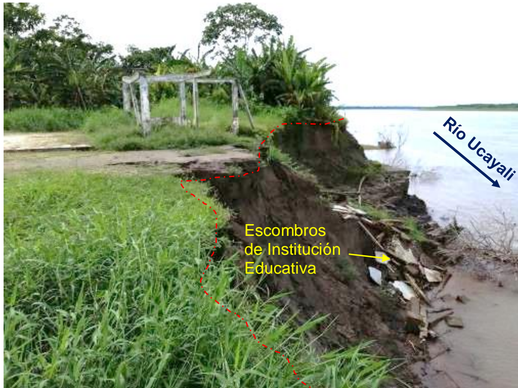
Figura 14: Escombros de institución educativa producto del colapso de la estructura debido a la socavación del terreno.
