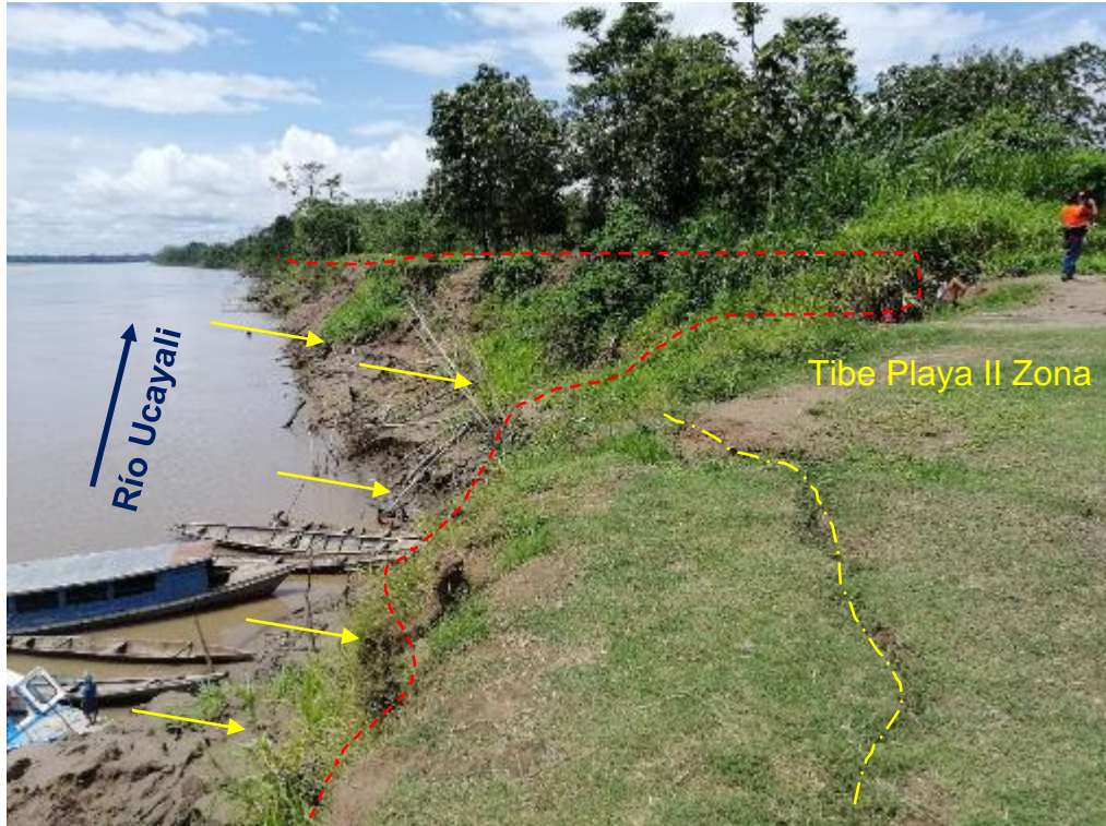
Figura 37: Zona erosiva y grietas de tensión.
