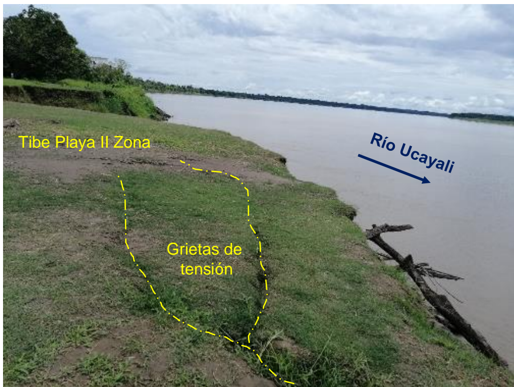
Figura 36: Grietas de tensión producto de la erosión de la base de la ribera.
