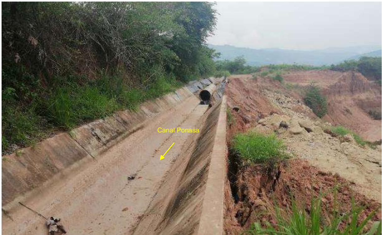
Figura 19: Canal Ponasa colapsado en 30 m de conducción, fecha 13 de febrero del 2020.
