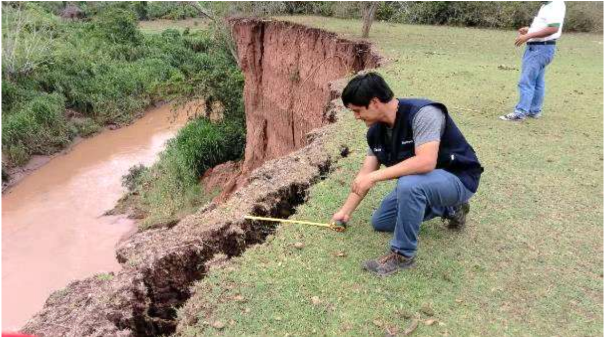
Figura 10: Vista de la parte superior del derrumbe de suelos. Se observan grietas de tensión.
