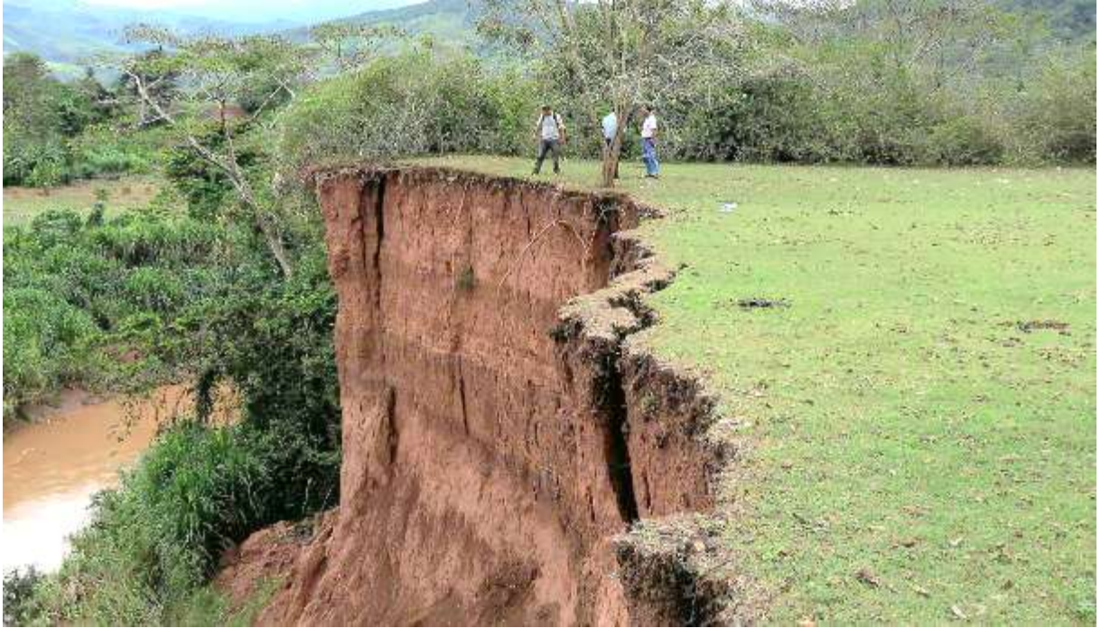
Figura 11: Ribera derecha donde se ha producido derrumbes recurrentes.
