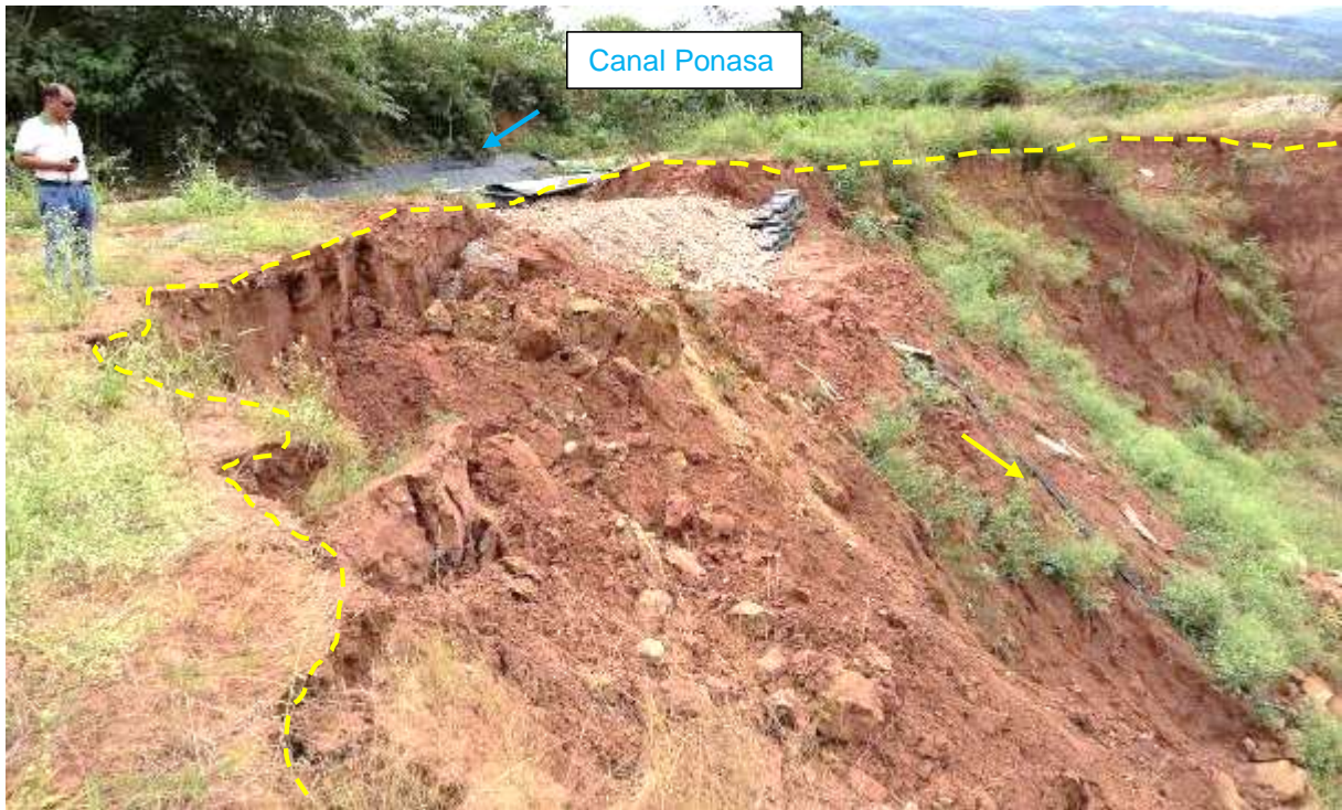
Figura 15: Vista de la zona de arranque del deslizamiento rotacional de suelos, fecha 25 de setiembre del 2019.
