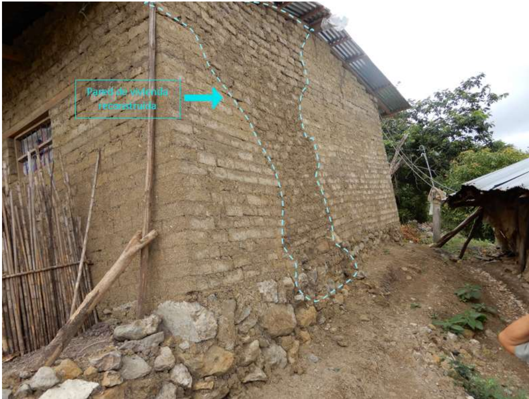
Figura 12. Parte inferior de la vivienda afectada por el deslizamiento, se muestra la reconstrucción de la pared.
