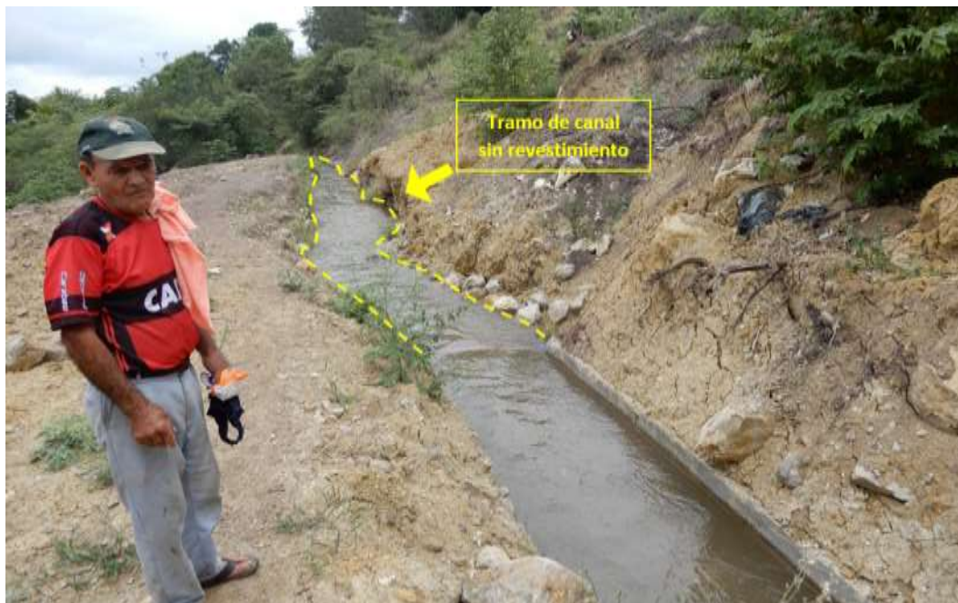
Figura 13. Tramo de Canal La Pascana sin revestimiento ubicado por encima de las viviendas afectadas por el deslizamiento, Vista con dirección al nor oeste.
