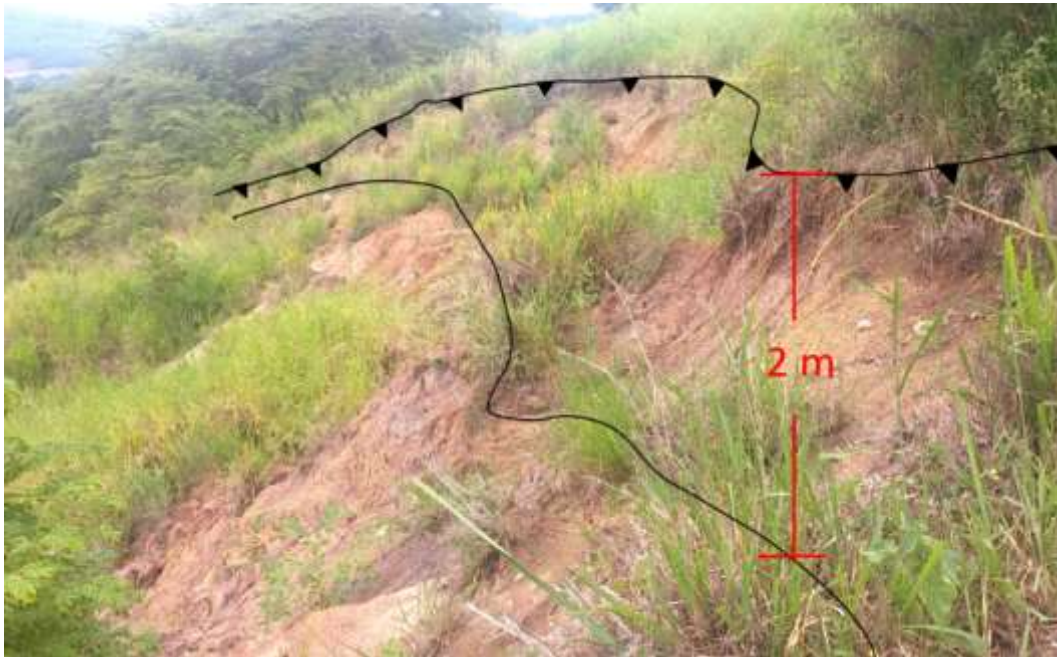
Figura 16. Escarpe de deslizamiento en el sector 2 del caserío Coca Enrique.
