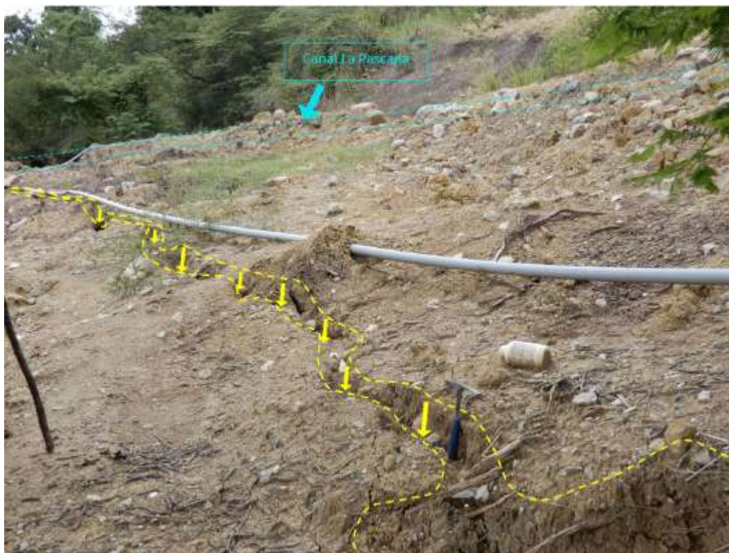
Figura 10. Agrietamiento con desplazamiento vertical, ubicado debajo del canal de riego La Pasca. Vista con dirección al nor este.
