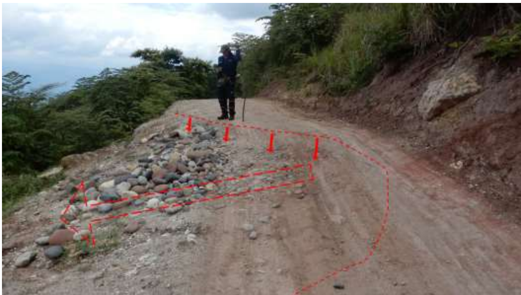
Figura 17. Carretera ubicada dentro del cuerpo deslizado afectada, por desplazamiento vertical.
