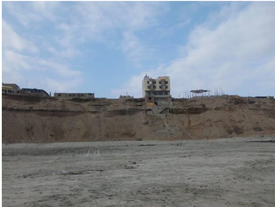
Figura 37: Viviendas ubicadas sobre acantilados verticales constituidos por arenas y limos; por lo tanto, se encuentran expuestos a peligro inminente.
