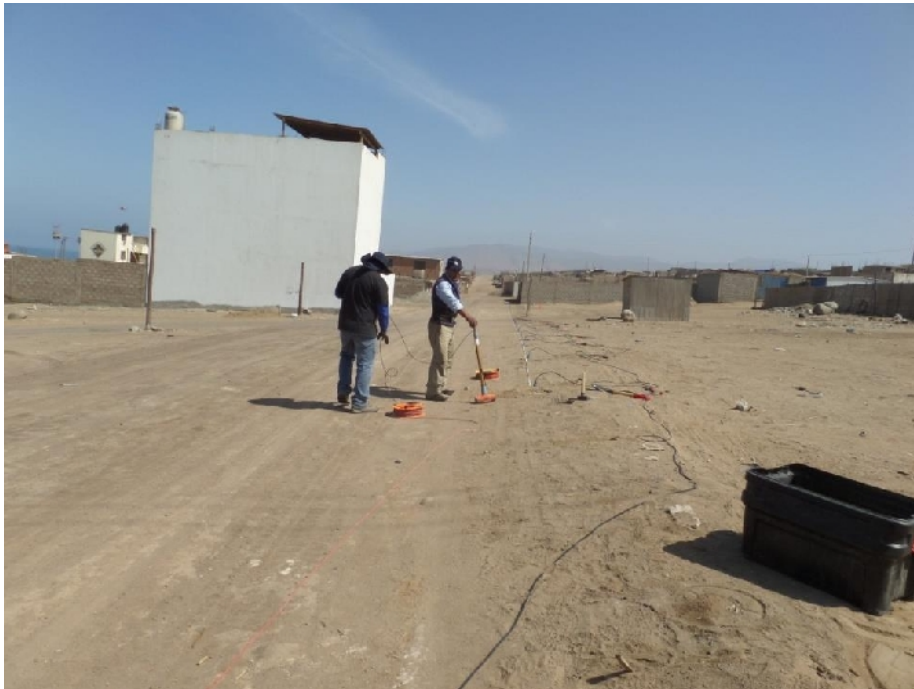
Figura 8: Imagen de la disposición del equipo de refracción sísmica en la ciudad de Chala
