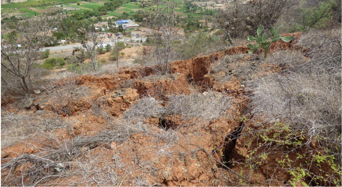
Foto 8. Agrietamientos del terreno, con desplazamiento horizontal y vertical.
