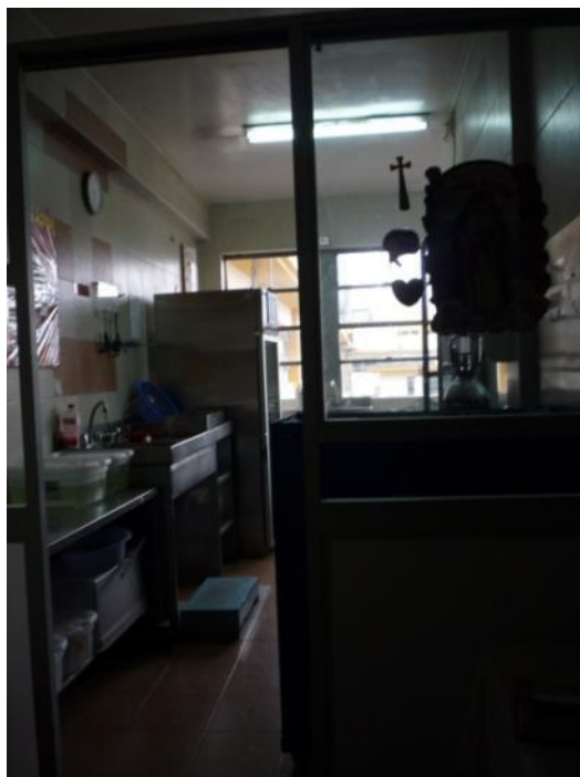
Foto 32: Los paneles divisorios existentes son de material prefabricado, también son elementos importantes a considerar en la vulnerabilidad en casos de sismo. Los existentes se encuentran en regular estado de conservación, con vidrios crudos que pueden afectar las rutas de evacuación.
