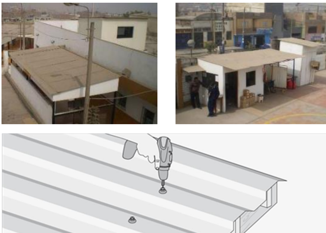
Fig. 4.4 Techos ligeros que deben estar sujetos adecuadamente a fin evitar caídas o desprendimientos
