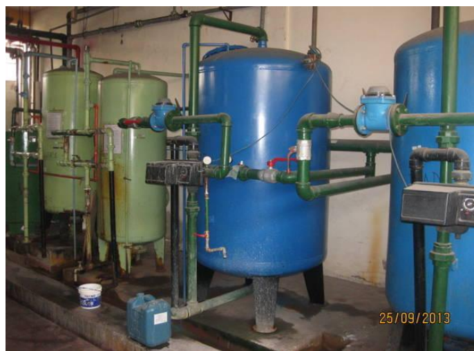
Foto 2 Algunas válvulas requieren reemplazo en la sala de máquinas.
