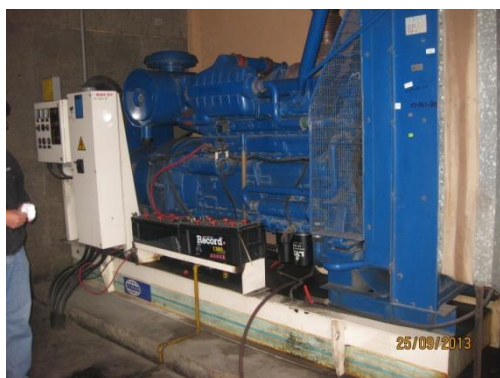
Foto 10. G.E. encapsulado de 750 KVA con tablero eléctrico nuevo.
