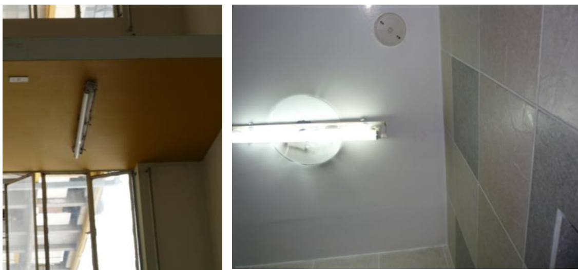
Foto 33: En ambientes y corredores internos no todas las luminarias cuentan con la bandeja de seguridad. En la parte externa, además de la falta de luminarias, en algunos casos, falta colocar los cintillos de seguridad. Existe riesgo de caída de los fluorescentes y podría provocar daños y lastimar a los pacientes, personal médico y técnico ante cualquier caso eventual de sismo.
