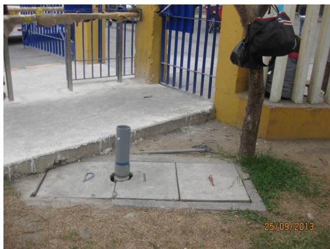
Foto 9 Caja de válvulas que permite recibir agua desde el exterior en caso de corte de suministro de la red pública.
