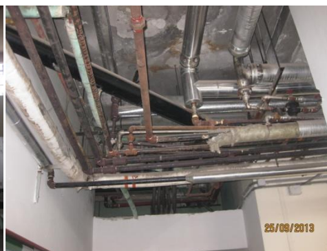
Foto 19. Tuberías en mal estado sin aislamiento térmico.
