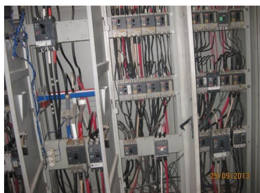
Foto 11. Tablero eléctrico en malas Condiciones.
