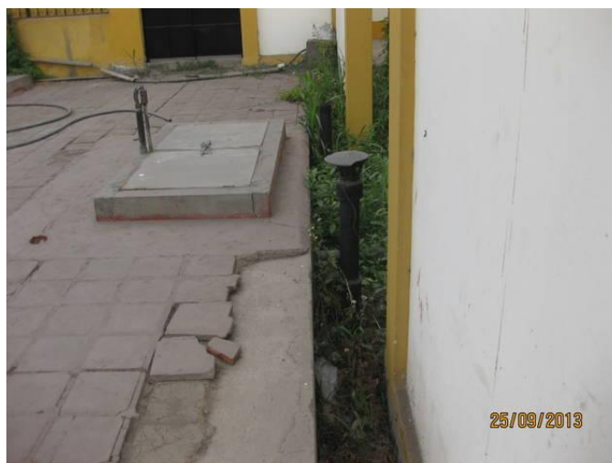
Foto 8 Cobertura de la cisterna deteriorada.
