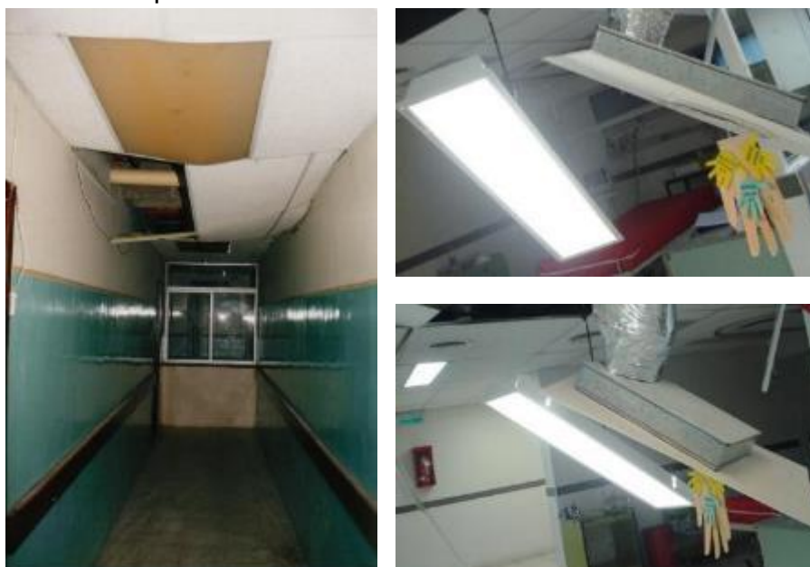
Fig.4.3 Falsos cielos rasos se desprenden por deficiencia en anclajes ante movimientos sísmicos
