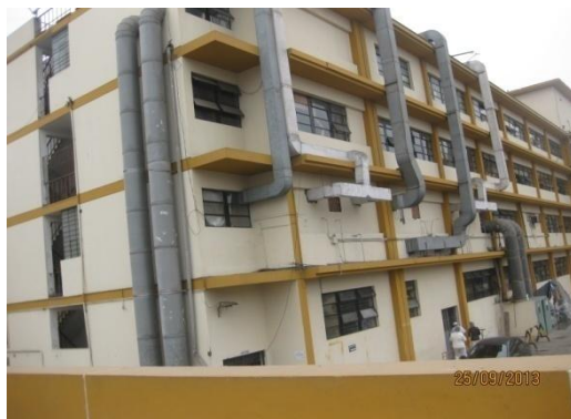
Foto 16. Ductos de ventilación deben ser asegurados.
