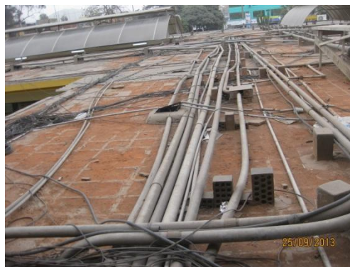
Foto 13. Instalaciones en pésimas condiciones eléctricas.
