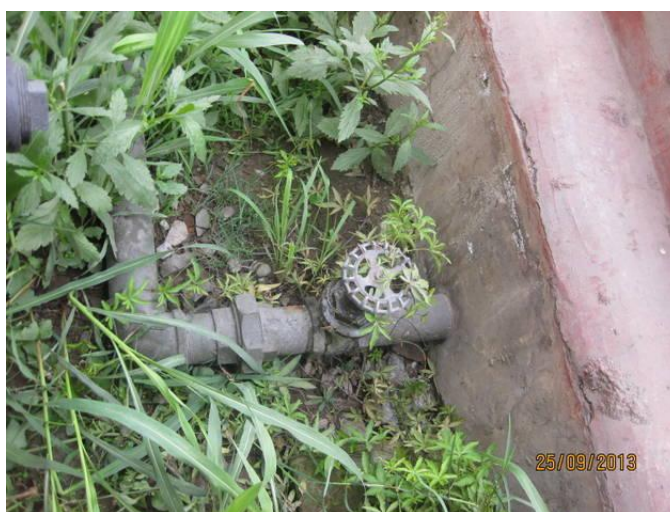
Foto 7 Válvula expuesta a la corrosión por riego de jardines sin caja de protección y sin uniones flexibles.
