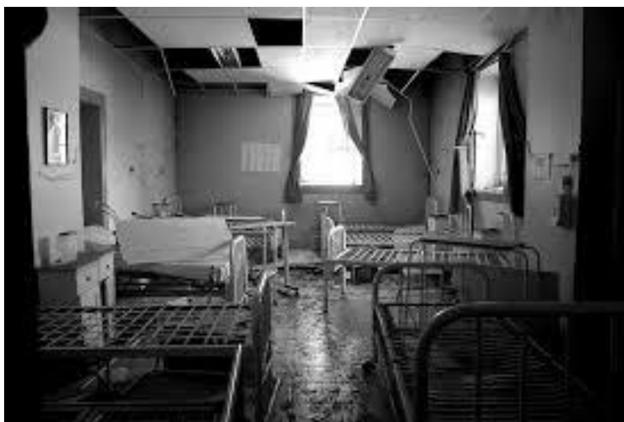
Fig. 4.7 Luminarias no sujetadas adecuadamente en techo ante movimientos sísmicos, se caen e incrementan el peso del falso cielo raso provocando colapso del sistema.
