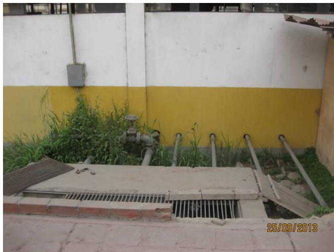
Foto 6 Válvula de interconexión a la intemperie, pases no rigidizados de la succión con la pared de la sala de máquinas.
