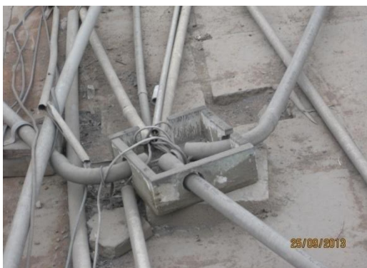
Foto 12. Instalaciones eléctricas en mal estado.
