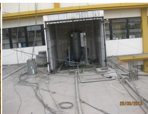
Foto 21. Central de vacío en mal estado.
