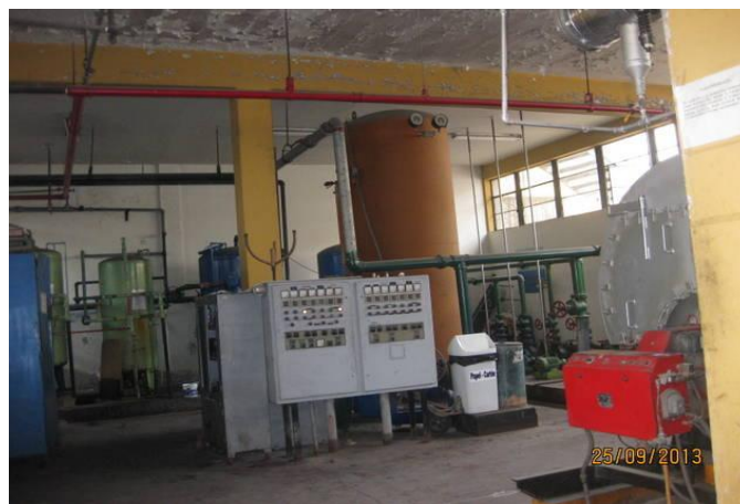
Foto 1 Sala de maquina donde se alojan las bombas y equipos de ablandamiento.
