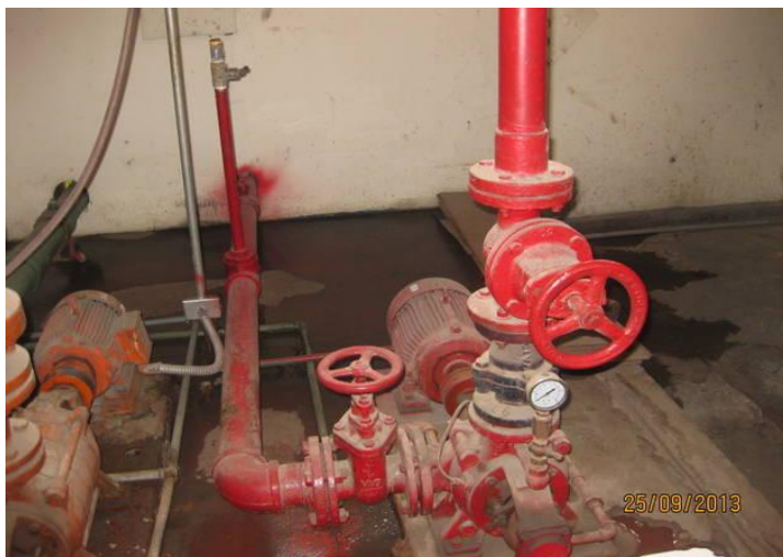
Foto 3 Bombas sin uniones flexibles en la succión. Carencia de bomba Jockey en sistema contra incendio.
