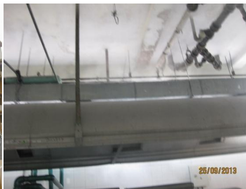
Foto 17. Campana extractora sin funcionar.
