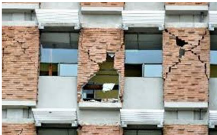
Fig.4.2 Baldosas en fachadas, que se desprenden por efecto de sismos intensos
