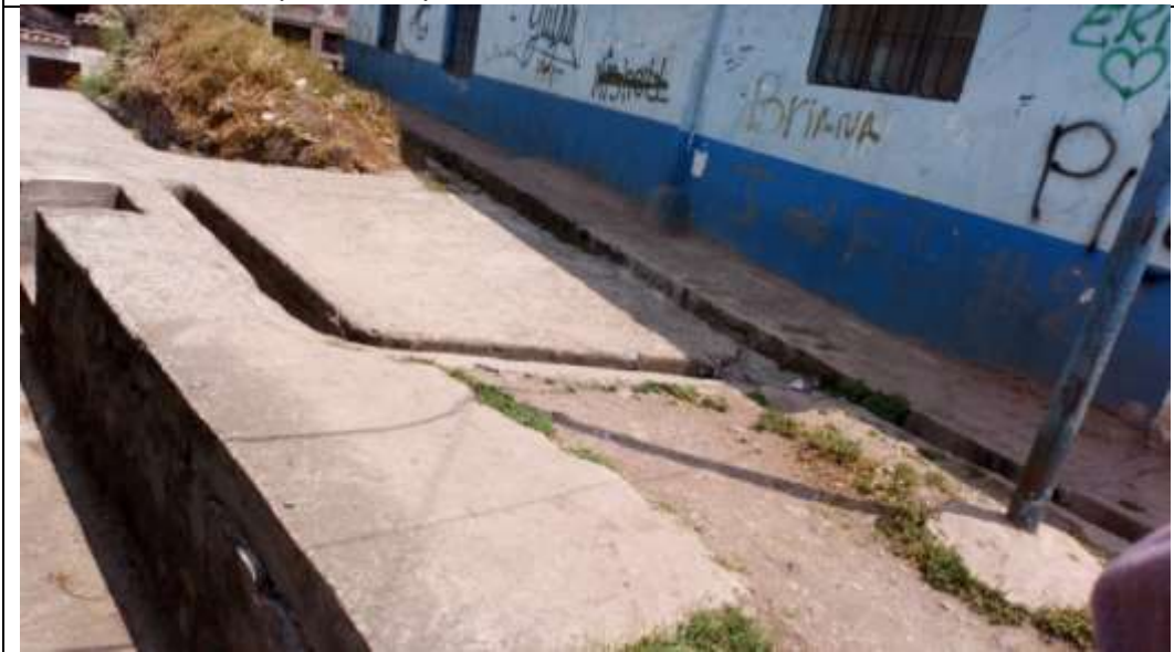
Fotografía 04: Existe un precario sistema de evacuación de aguas pluviales
