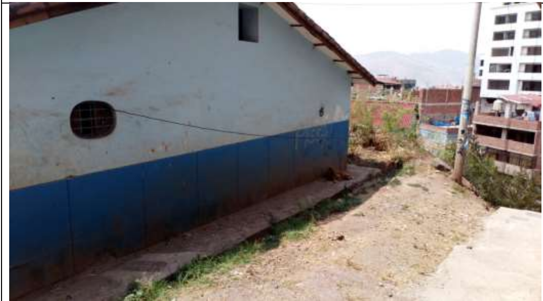
Fotografía 06: Se evidencia la precariedad de servicios, en la toma se observa la conexión insegura de fluido eléctrico.
