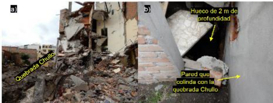
Sector Urbanización Independencia Americana afectada por huaicos. a) Casa destrozada e inhabitable, b) Patio de una vivienda a punto de colapsar, tiene un hueco de 2 m de profundidad. (Informe A7040)
