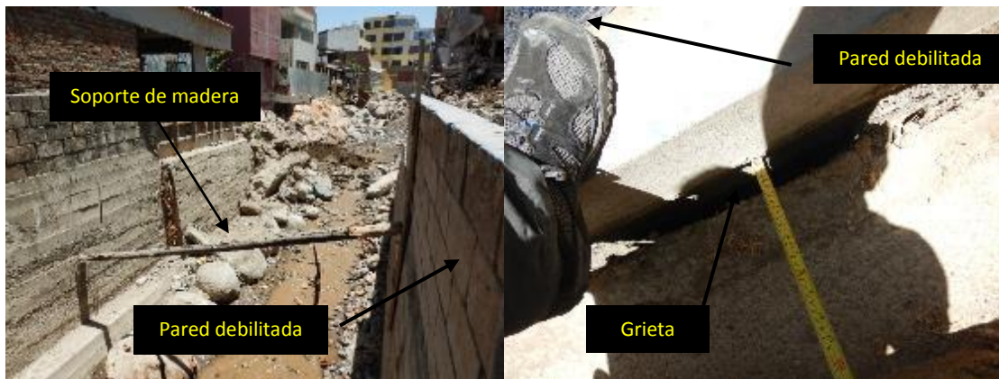
Sector Urbanización Independencia Americana, distrito Yanahuara 29/10/2020. a) Muro de contención debilitado e inclinado soportado por un pilote de madera. b) Grieta de 7 cm de ancho en el muro inclinado a lado del parque de la urbanización.
