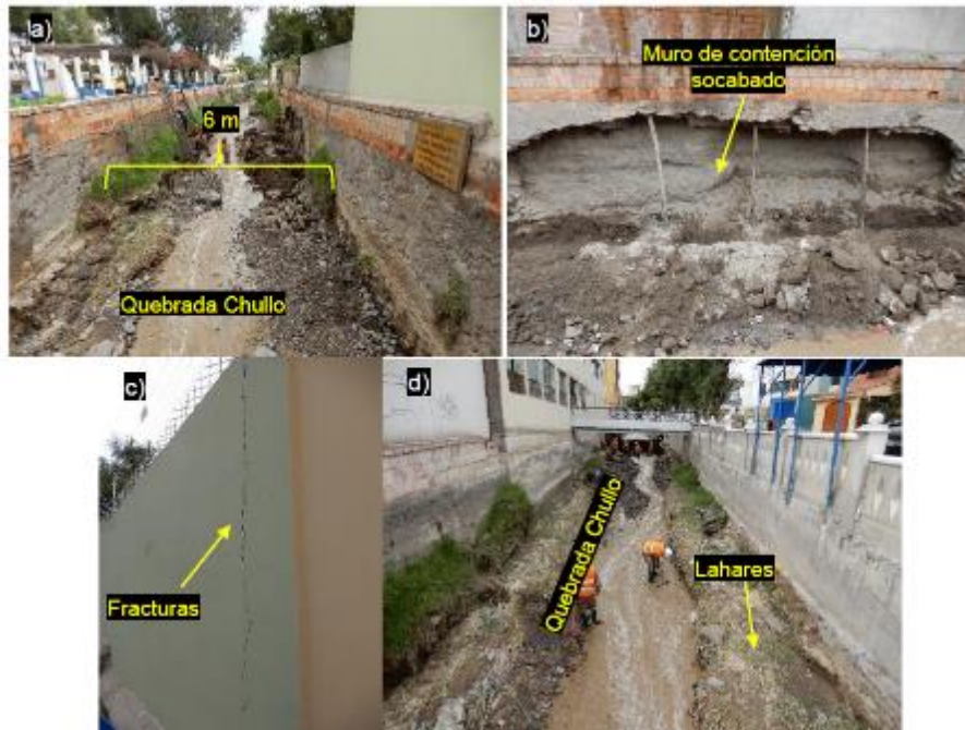
Sector Puente Primavera, distrito Yanahuara. a) muro de contención antiguo y debilitado por la erosión de los huaicos. b) pared socavada por los huaicos. c) fracturas en las
