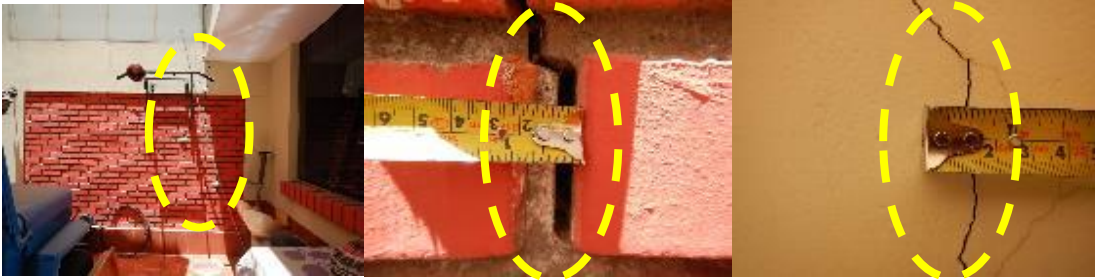
Sector Urbanización Independencia Americana, distrito Yanahuara 29/10/2020. Agrietamiento en las paredes de una vivienda.
