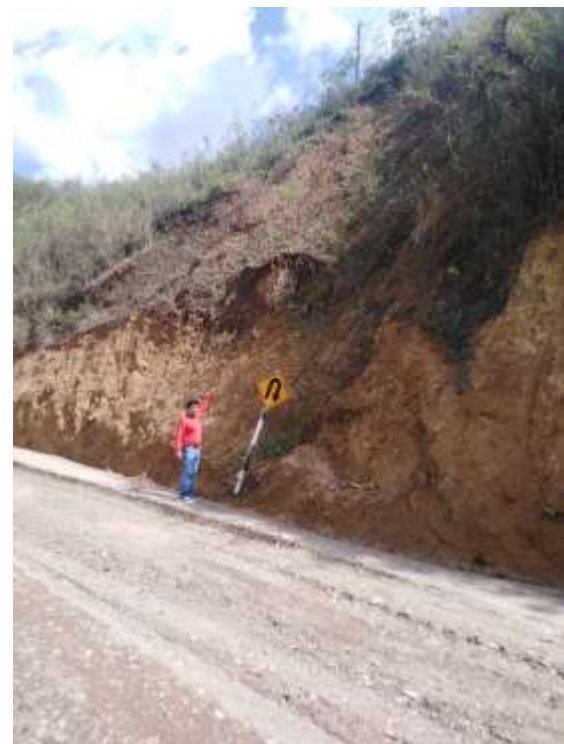
Foto N°06. Amenaza con deslizamiento de sedimentos afectando a carretera, lugar: Monterrico.
