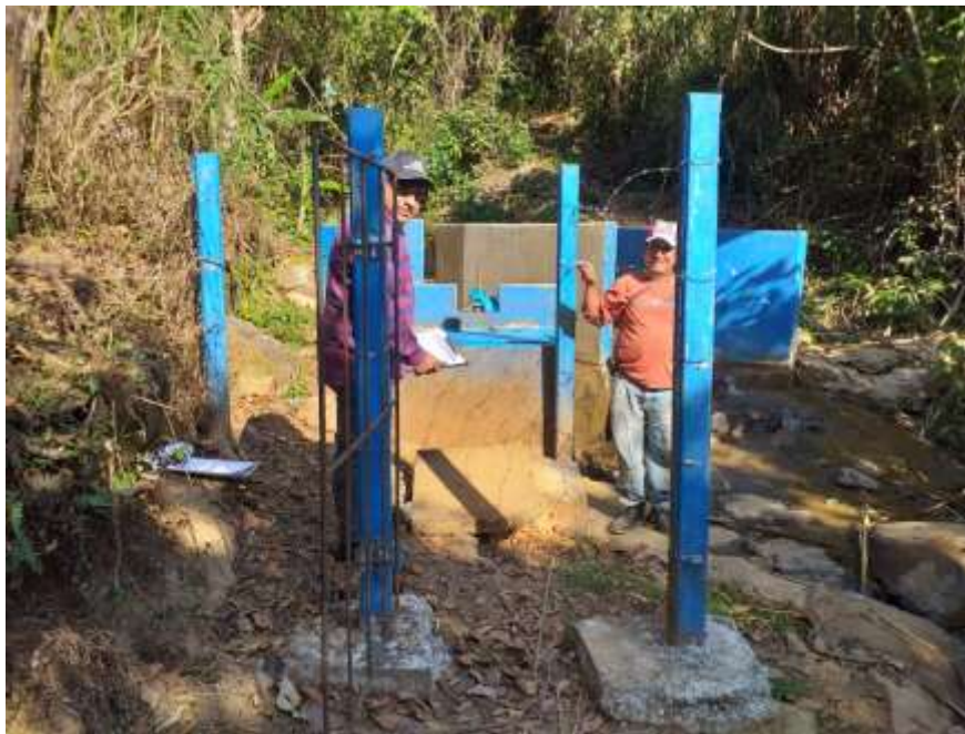
Foto N°10. Amenaza en épocas de lluvias, de afectarse la infraestructura de captación y distribución de agua para consumo humano. Lugar: Sicchez Capital.
