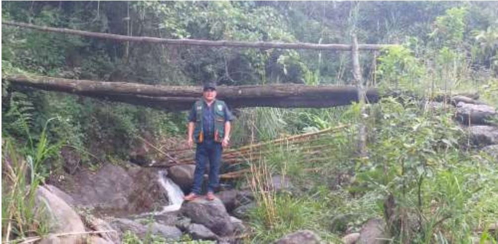
Foto N°09. Amenaza en épocas de lluvias, de afectarse el puente “los chambas”, Lugar: C.P. Monterrico.
