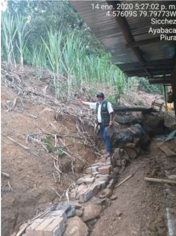
Foto N°05. Amenaza con deslizamiento de sedimentos a viviendas, lugar: Las Vegas.
