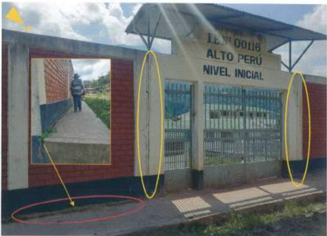
Foto 22: Grietas (elipse amarilla) en las paredes del colegio y asentamientos (elipse roja) de las veredas, posiblemente generadas por la reptación de suelos en las inmediaciones de la institución educativa
