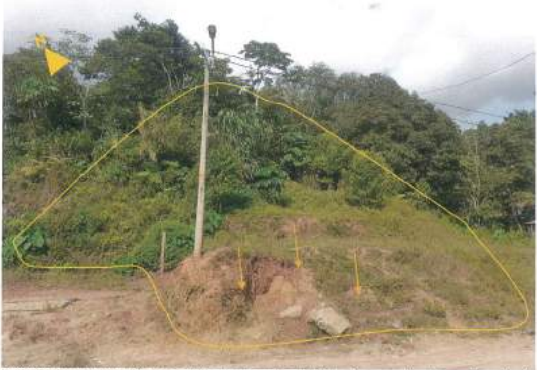
Foto 21: Zonas susceptibles a reptación de suelos debido al incremento de la saturación de los suelos limo - arcillosos sobre las laderas, como evidencia la inclinación de poste
