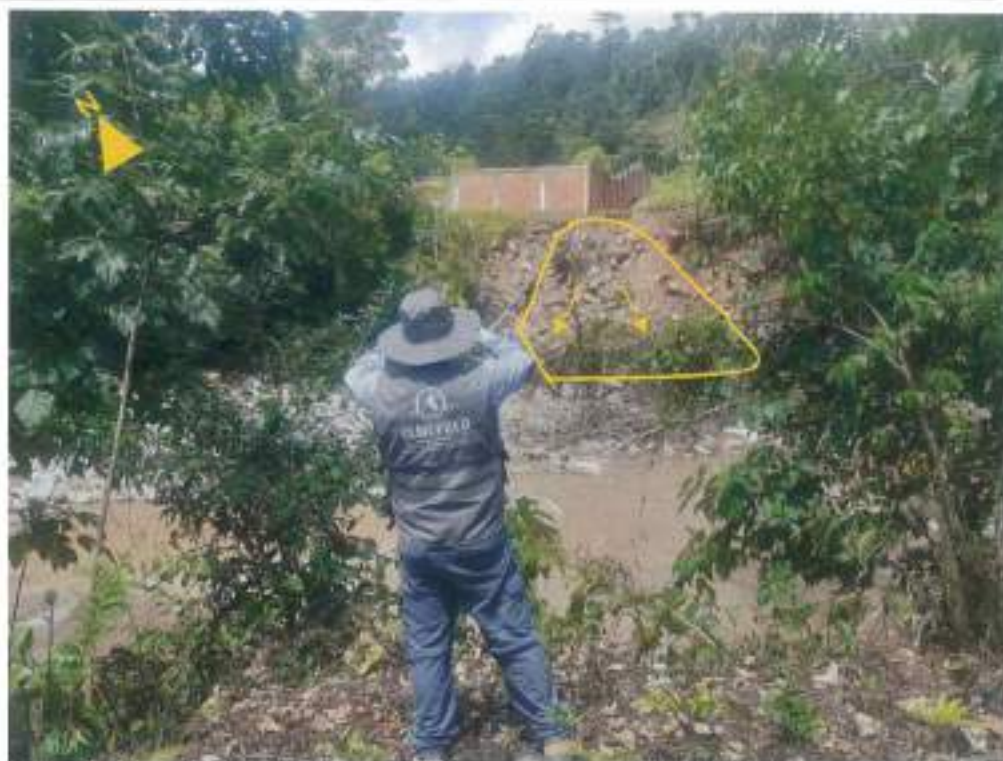
Foto 15: Derrumbe (polígono amarillo) ocurrido en el talud del margen derecho del río Ochque, sobre el cual se asienta parte de la institución educativa N° 00116 – Alto Perú; debido al incremento de la saturación del suelo por la derivación de agua de escorrentía por una acequia sin revestimiento
