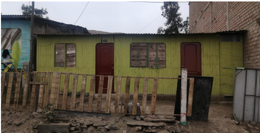
FOTOGRAFÍA N° 11. Vivienda con estructura de triplay, cemento no tan firme, en estado regular de conservación.
