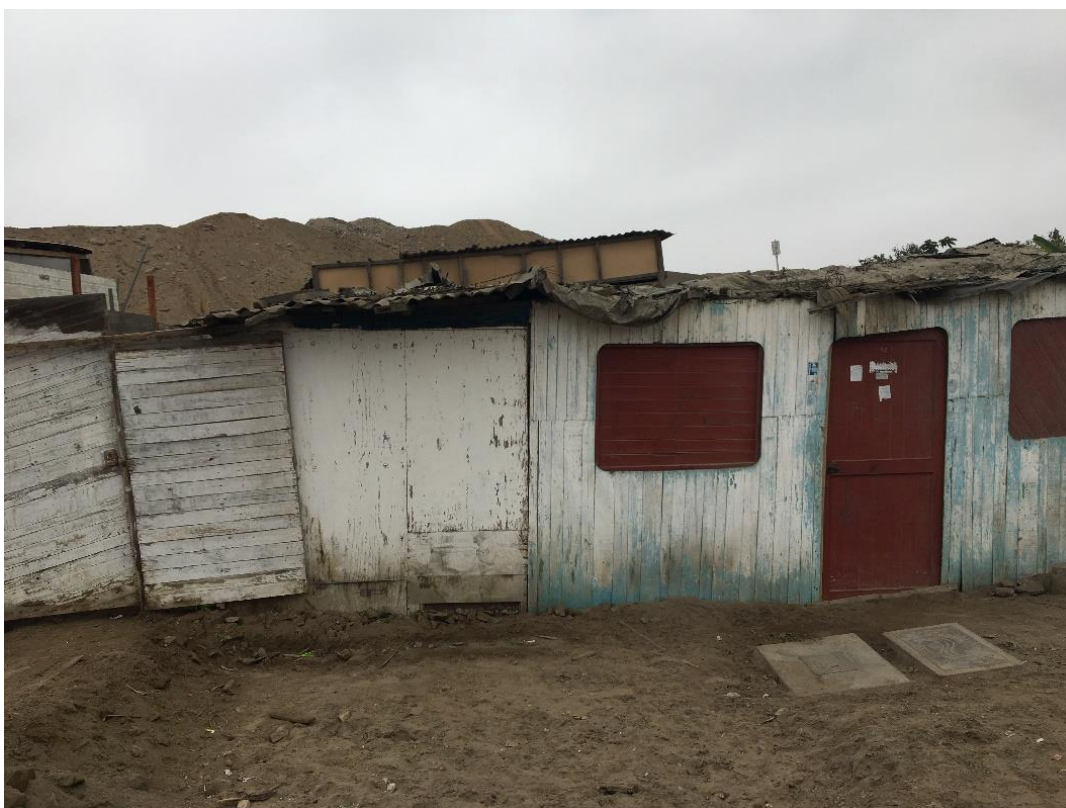
FOTOGRAFÍA N° 12. Vivienda con construcción precaria, no cuenta con cemento firme.
