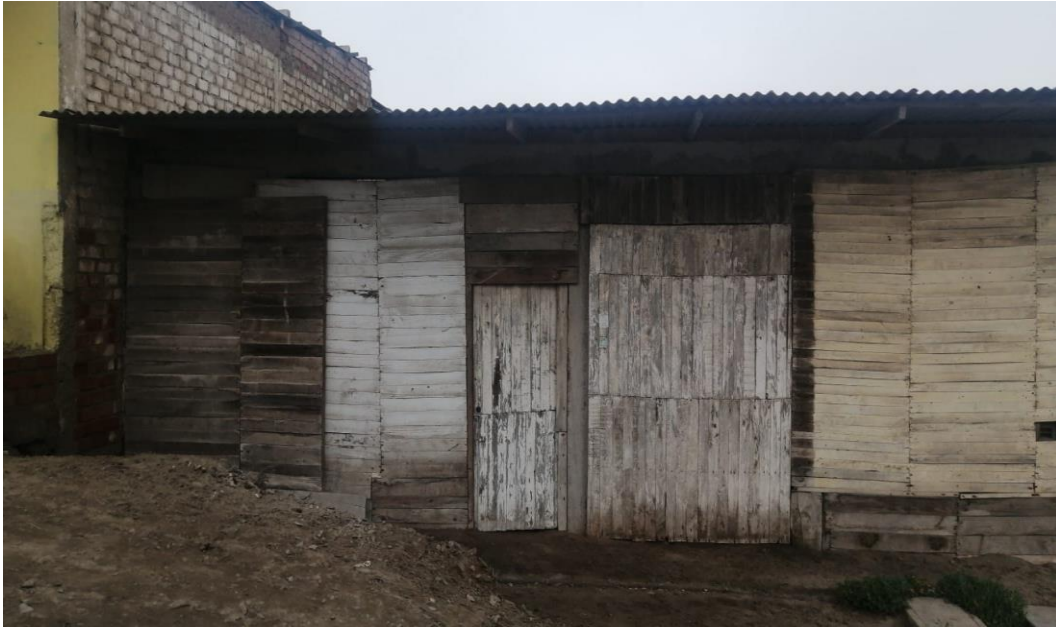
FOTOGRAFÍA N° 13. Vivienda con construcción precaria, no cuenta con cimiento firme.
