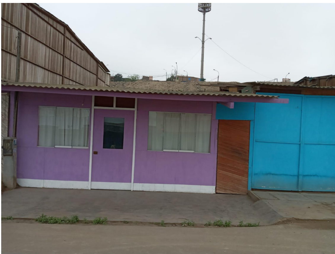
FOTOGRAFÍA N° 4. Viviendas construidas apoyadas sobre bases de concreto sin control técnico, con material de construcción precario sin cemento.
