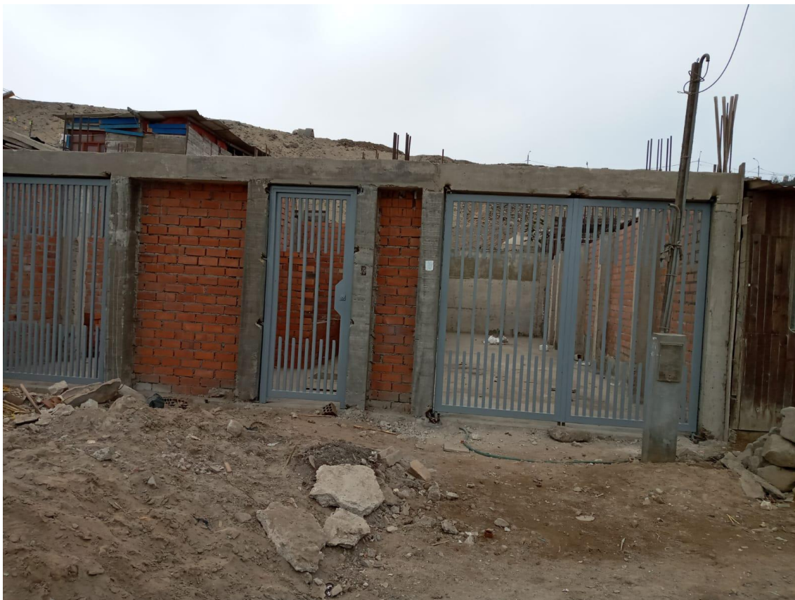
FOTOGRAFÍA N° 5. Vivienda en construcción, con cimiento de cemento y con material de ladrillo y cemento.
