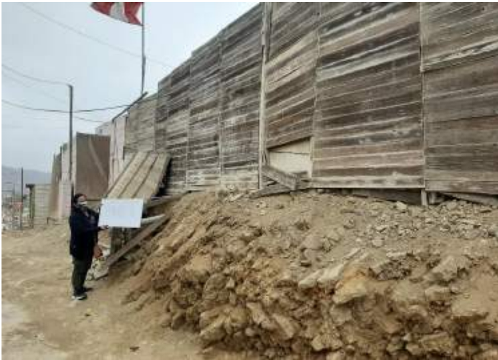
Vivienda de madera ubicada en la Mz. Q' Lote 1 donde se aprecia que puede suceder el posible deslizamiento de su base en la parte lateral de la vivienda.
