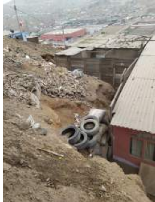
Vista del desnivel del terreno que pone en riesgo a la vivienda Mz. D' Lt. 19.
