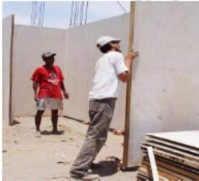
Ilustración 6: Vivienda con paneles superboard
