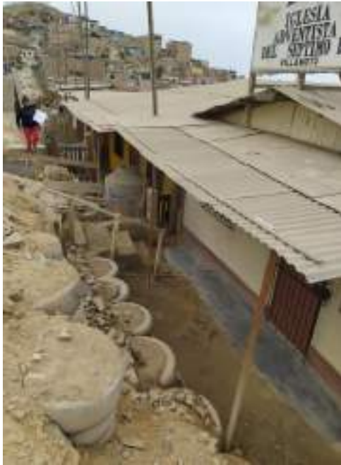
Frente de la vivienda Mz. L' Lt. 4 apoyada sobre neumáticos.
