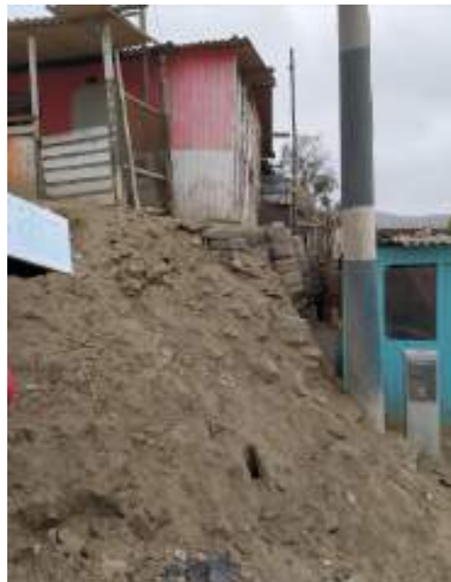
Vivienda de la Mz. T' Lt. 2 que se apoya sobre neumáticos.
