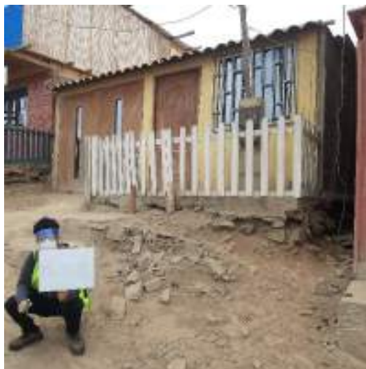
Vivienda de madera ubicada en Mz. K' Lt. 2 con cimentación erosionada en la parte lateral de la vivienda.
