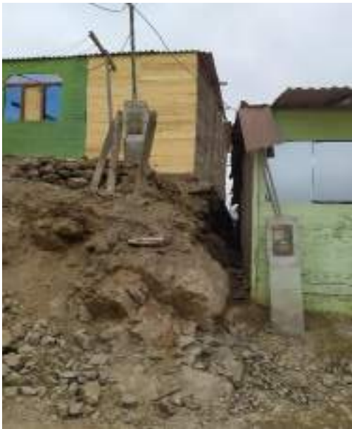
Vivienda de la Mz S' Lt. 7 donde se visualiza que su base de la parte lateral puede ocasionar un deslizamiento de tierra y afectar a la vivienda del lado.
