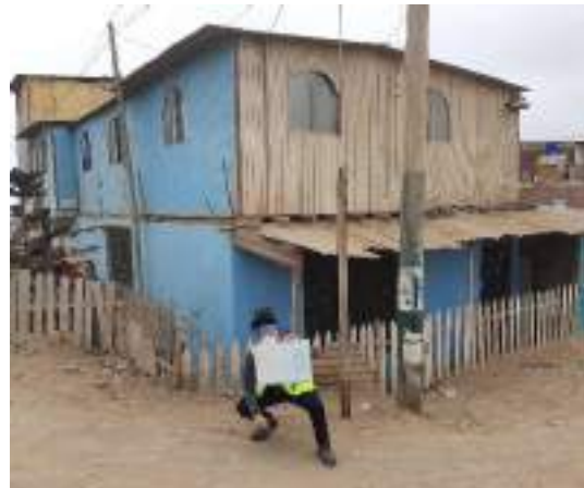
Vivienda ubicada en Mz. K' Lt. 15 de material noble en el primer nivel y con prefabricado de madera en el segundo nivel; esta última tiene posibilidad de colapso ante un sismo por no presentar elementos estructurales.
