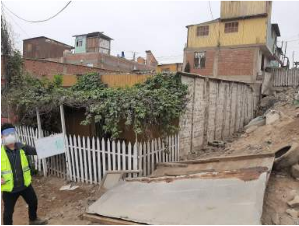
Vista de vivienda de madera con parte lateral expuesta a deslizamiento de tierra.
