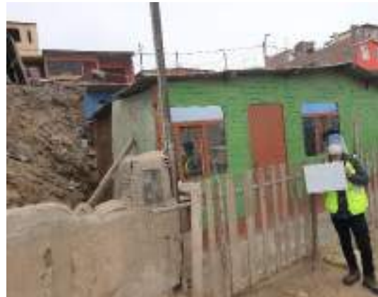
Vivienda de la Mz. G' Lt. 3 prefabricada de madera con posibilidad de sufrir deslizamiento de tierra.
