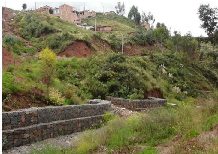
Fotografía 15: Cauce aluvial relleno de escombros y aguas residuales
