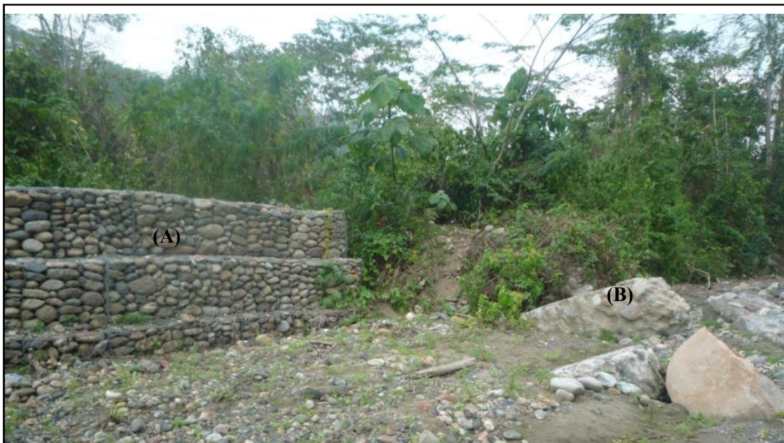
Foto N° 12.- Defensas ribereñas (gaviones) (A) recientemente construidas, se aprecia también muros destruidos (B).
