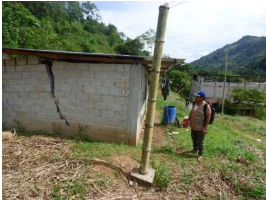
Fotografía 8. Conexiones eléctricas que podrían ser afectadas debido al movimiento de los deslizamientos. Vista al sur
