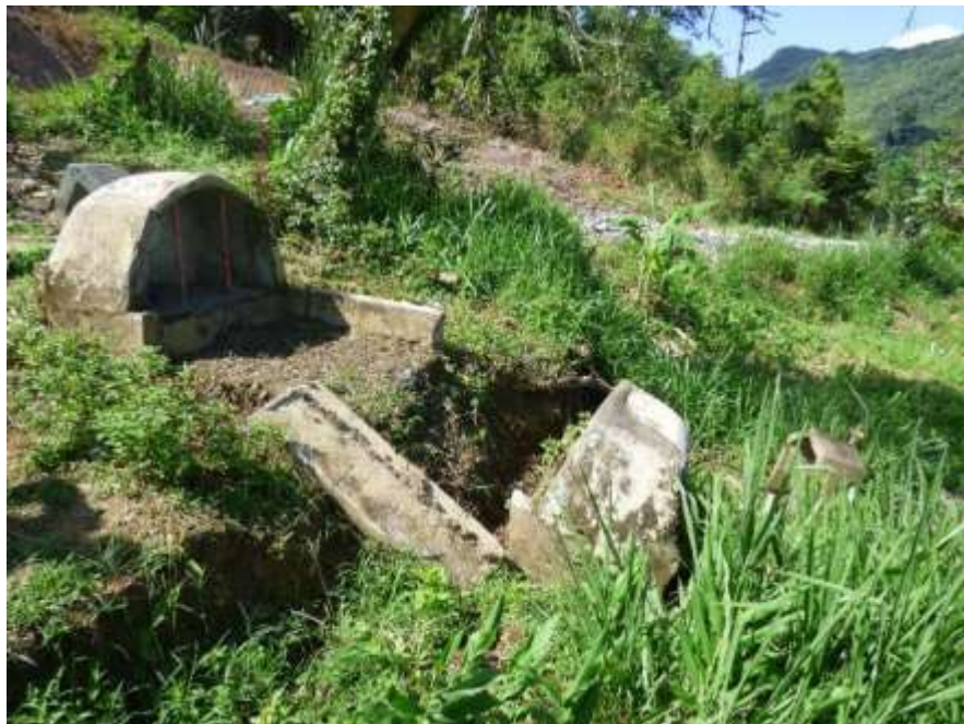
Fotografía 9. Cementerio del caserío de Incari afectado agrietamientos y asentamientos en el terreno durante las lluvias ocurridas el mes de febrero de 2019. Vista al sureste
