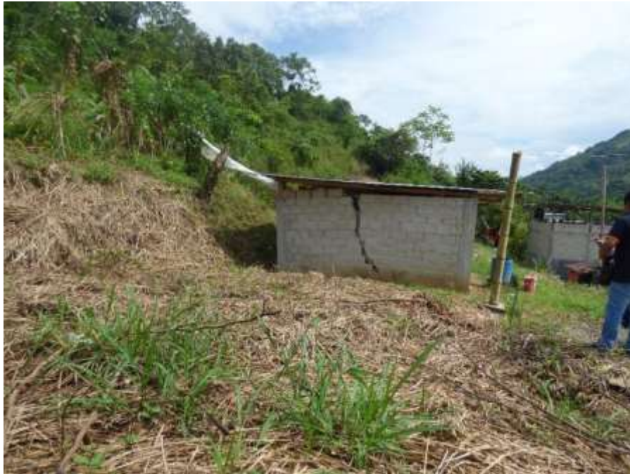
Fotografía 6. Vivienda afectada y considerada inhabitable debido al movimiento ladera hacia abajo de los deslizamientos. Vista al sur
