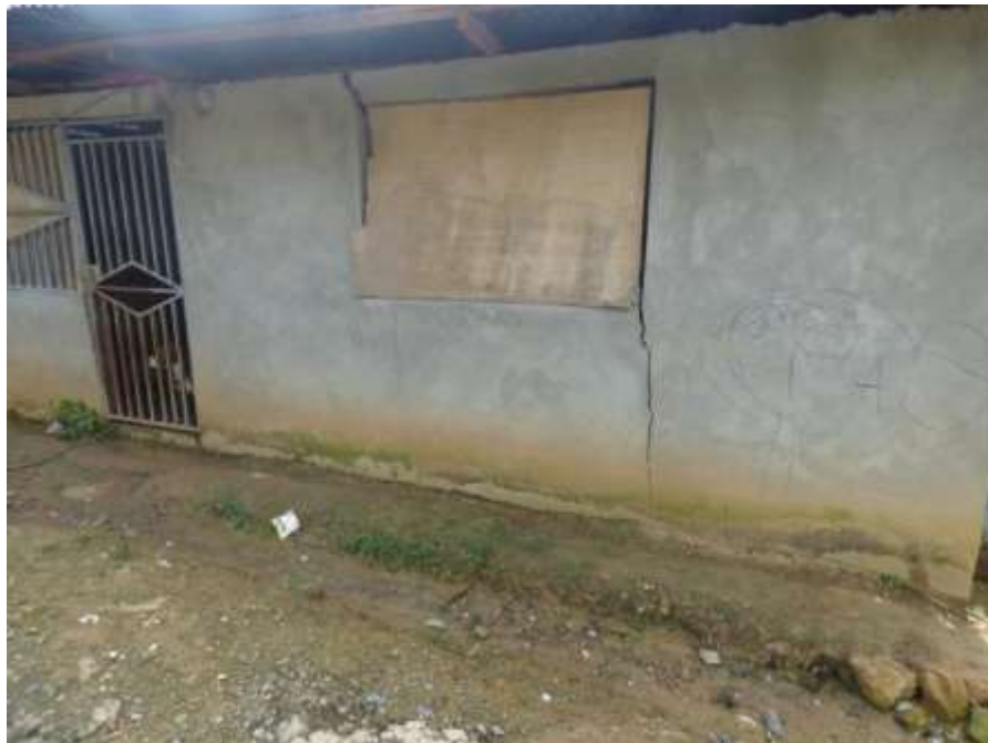
Fotografía 7. Vivienda que se encuentra muy cerca a los deslizamientos y que presenta agrietamientos en las paredes. Vista al este
