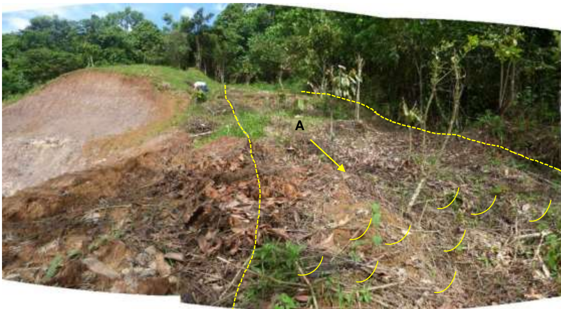
Figura 18. Deslizamiento A identificado en la zona de estudio y que afectó la vía de acceso al sector 27 de Julio. La ocurrencia de estos movimientos en masa se favoreció por la pendiente del terreno y el tipo de suelo que es de fácil remoción por acción hídrica. Vista al noreste
