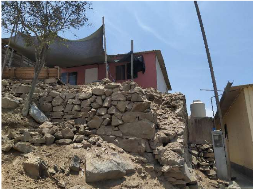
Vista de la vivienda Mz. Y5 Lt. 10, donde se encuentra asentado en pirca y cercana a gran desnivel.
