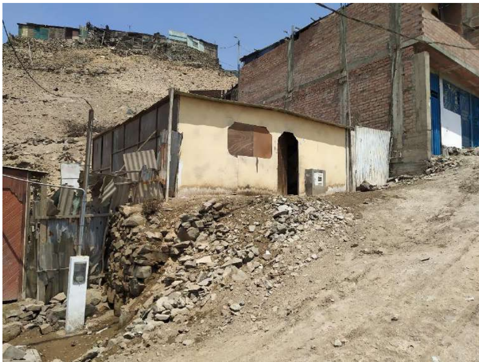
Vista de la vivienda Mz. Y13 Lt. 1, donde se encuentra asentado en pirca. Y con riesgo de sufrir deslizamiento de tierra en la parte posterior de la vivienda.
