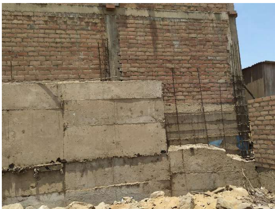
Vista del muro de concreto en la vivienda Mz. Y8 Lt. 20, en el cual están expuesto los fieros de refuerzo.
