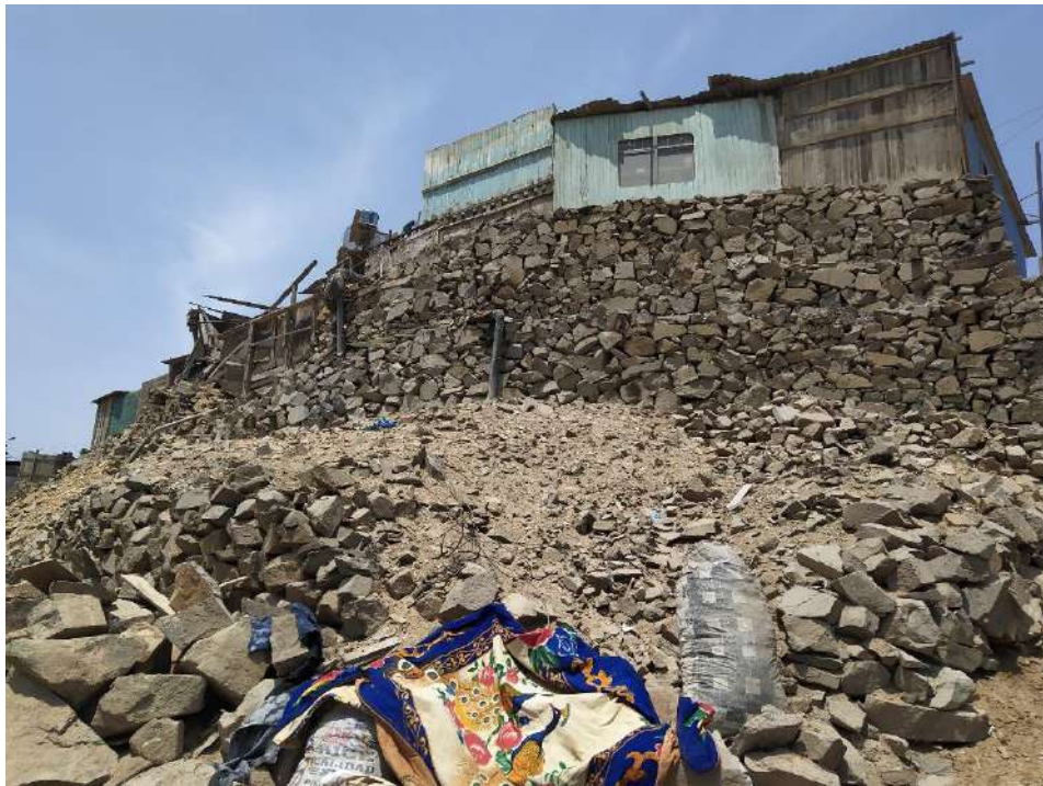
Vista de la parte posterior a la vivienda Mz. Y13 Lt. 16 B, donde se encuentra asentado en pirca y cercana a desnivel. Terreno con gran pendiente
