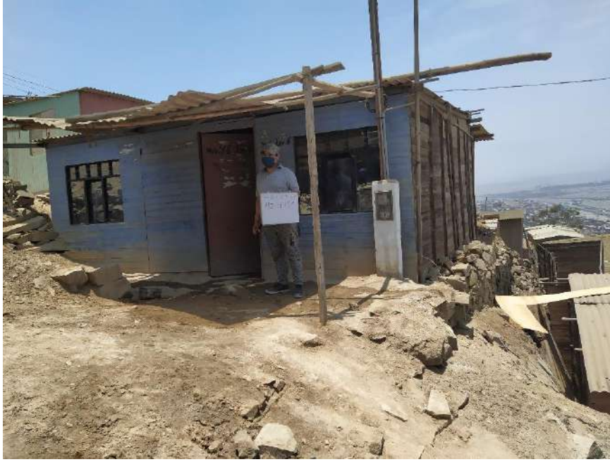
Vista de la vivienda Mz Y6 Lt. 1, donde se asienta en pirca y se encuentra cerca de gran desnivel.
