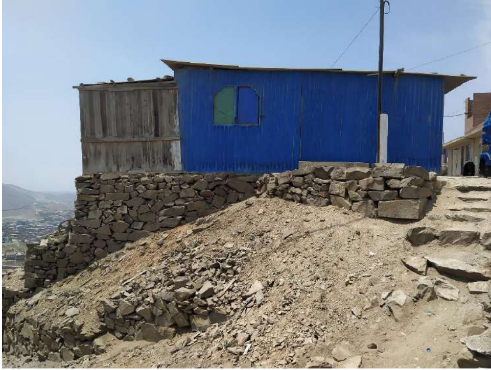
Vista de la vivienda Mz. Y13 Lt. 16B, donde se encuentra asentado en pirca y cercana a gran desnivel.
