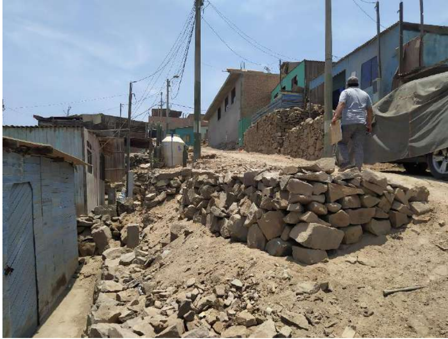
Vista de la Calle Los Quinulales, donde se aprecia desnivel entre las Mz. Y5 (derecha) y Y6 (izquierda)
