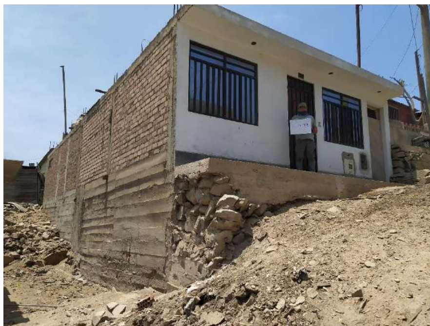
Vista de la vivienda de la Mz. Y9 Lt. 11, el cual presenta gran desnivel.
