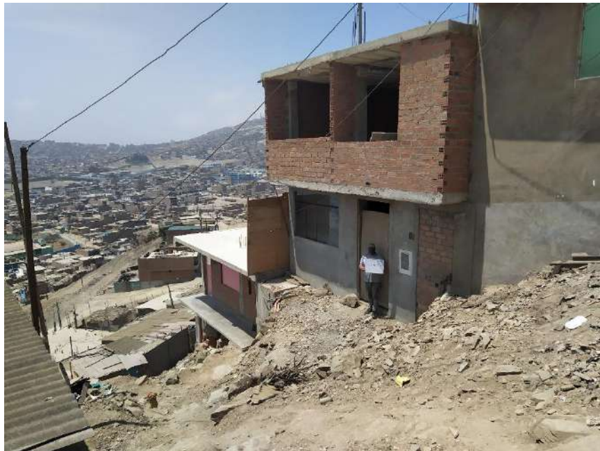
Vivienda de la vivienda Mz. Y14 Lt. 7, tomada desde el Pasaje Pino.
