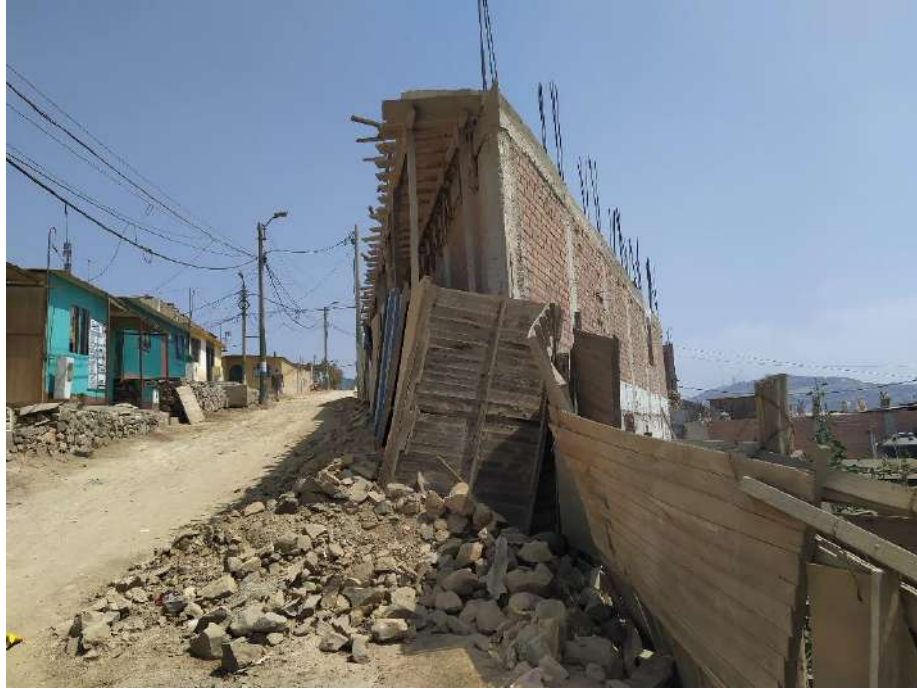
Vista de la vivienda de la Mz. Y11 Lt 7, donde no se cumple regularidad en planta según norma E 030 “Diseño Sismorresistente”.
