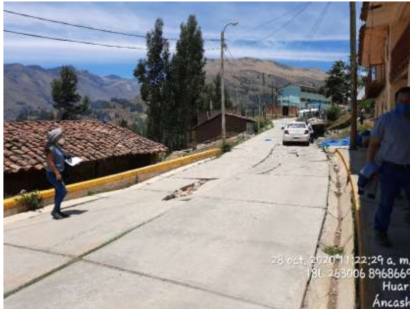
Fotografía 9. Carretera de acceso al centro poblado Cajay afectada a causa de los asentamientos y movimientos en el terreno.
