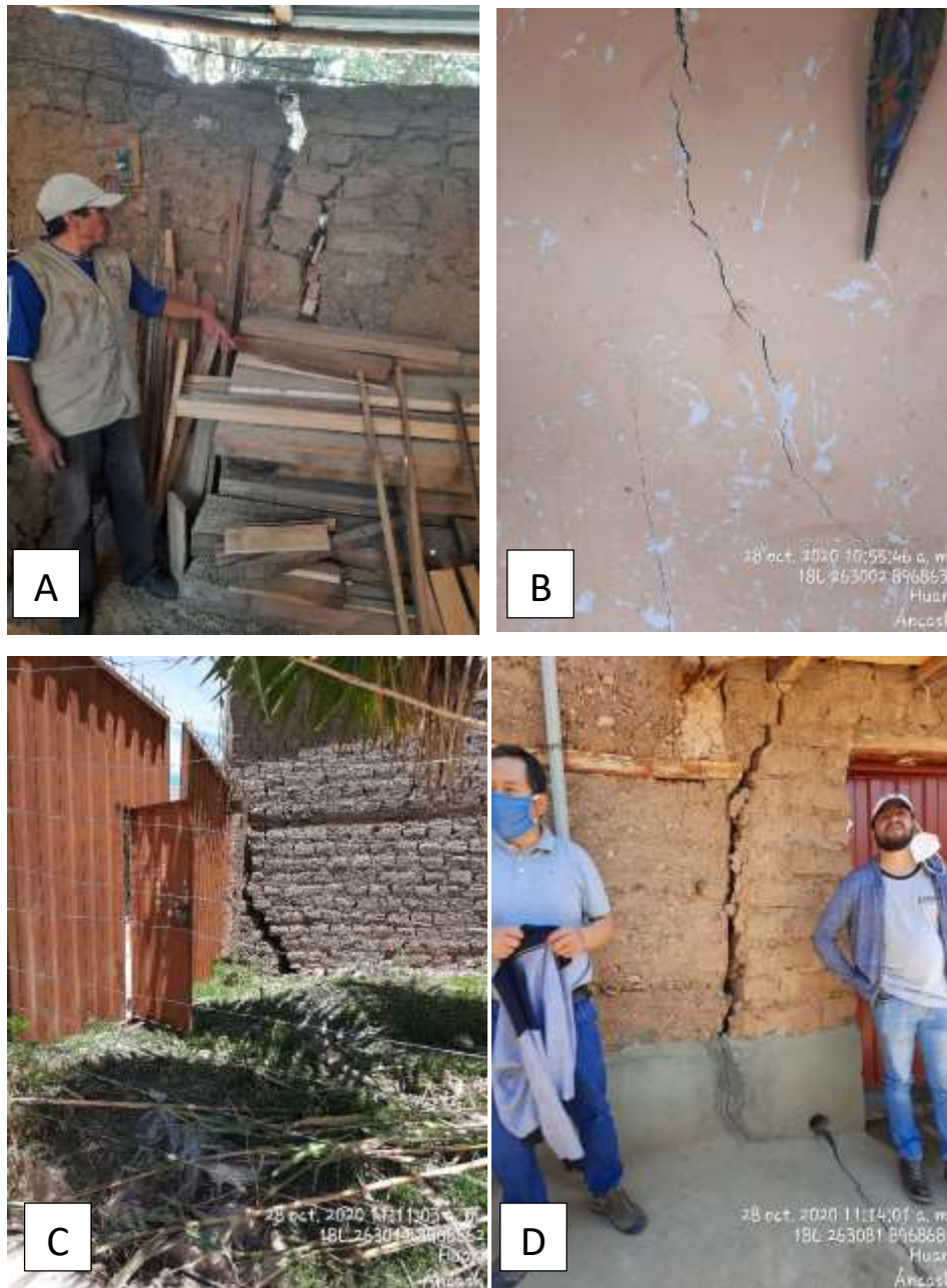
Figura 4. Estado actual de las viviendas de adobe en el centro poblado Cajay. A) Presencia de aberturas de hasta 10 cm. B) Agrietamientos en la pared. C) Aberturas de 20 cm en las paredes de adobe. D) Separación con aberturas de hasta 13 cm, por asentamientos.
