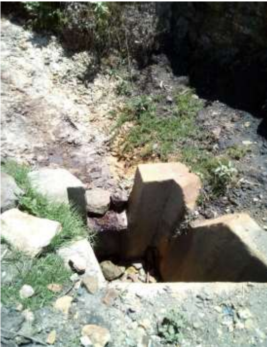
Fotografía 7. Sistema de drenaje sin revestimiento lo que genera la filtración del agua y posterior saturación del suelo.
