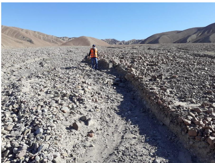
Figura 33: Nivel de socavación del canal principal.
