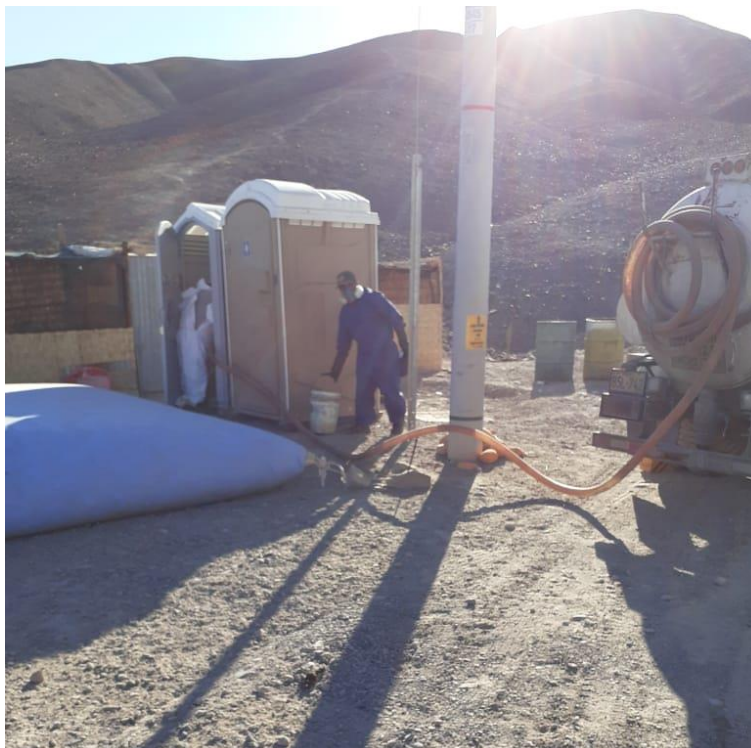
Figura 13: Punto de abastecimiento de agua y baños químicos existentes en Alto Mirave.
