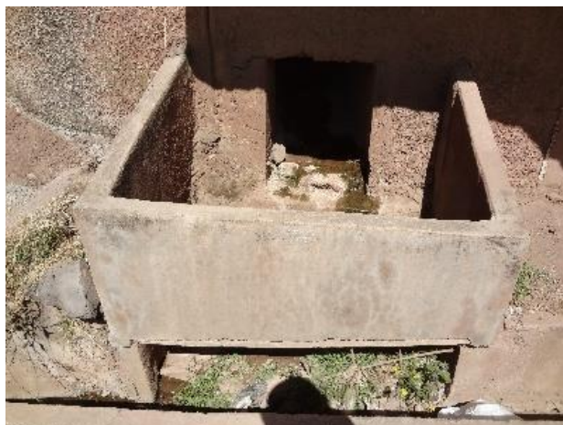
Fotografía 8: Cauce impactado por viviendas, parte alta quebrada Camino Real, APV Camino Inca Fuente: Equipo Técnico SGOT/PM41ZRE
