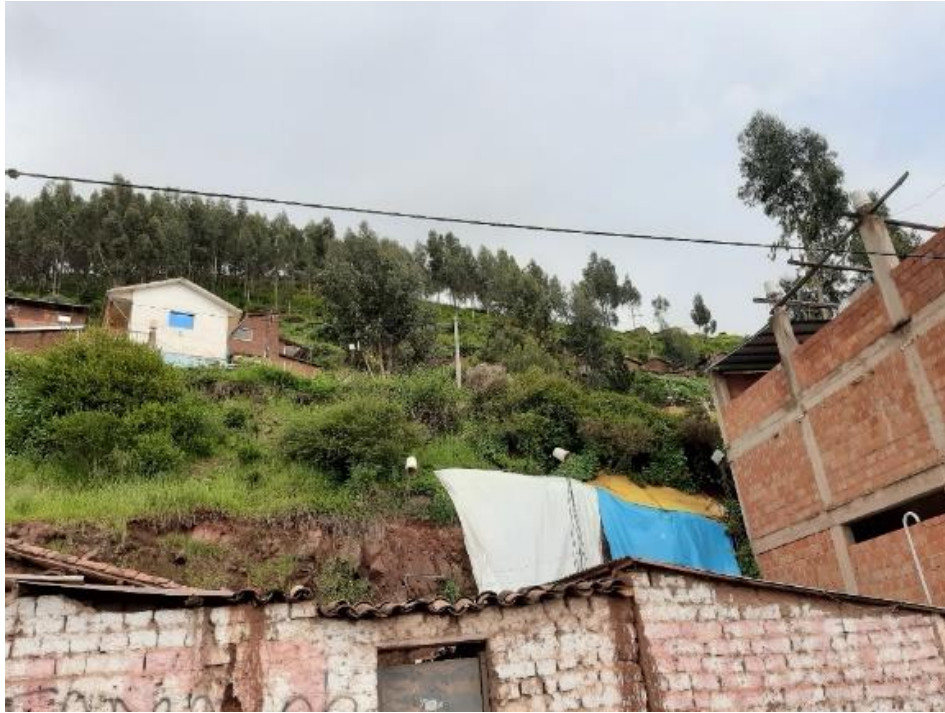
Fotografía 7: Arenisca fracturada en la zona de viviendas al costado de la vía principal
