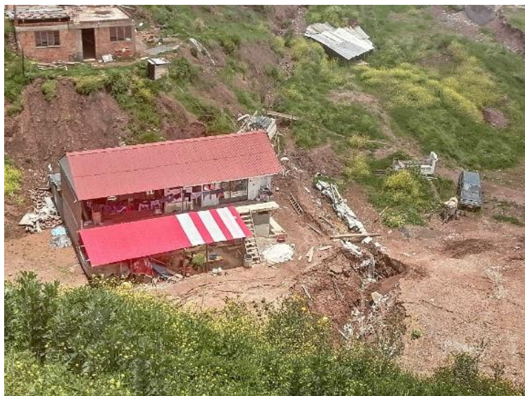
Fotografía 18: Pendiente llana a inclinada en el fondo de la quebrada donde se ve una edificación, zona de materia proluvial con ciertos indicios de asentamiento.
