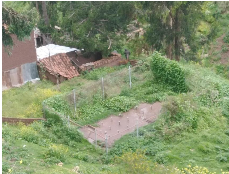
Fotografía 1: Pozo séptico que recibe las aguas servidas de la APV. Virgen Concepción. Fuente: Equipo Técnico PM41ZRE
