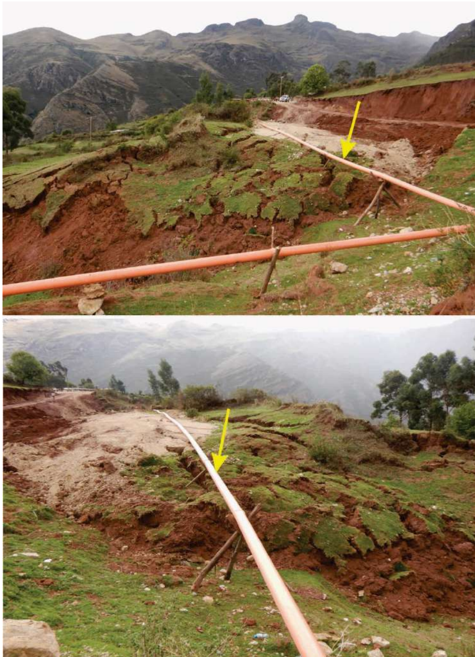
Figura 11. Vista donde se observa tubería de desagüe repuesto y variado, se visualiza que estas se asientan en troncos, los cuales deberían estar fijos sobre estructuras estables, ubicado en las coordenadas UTM 8431541 N, 705267 E, con una altitud de 3607 m s.n.m.
