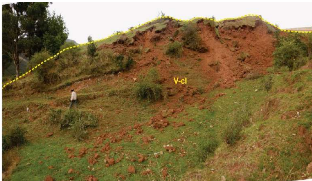
Figura 6. Se observa la subunidad vertiente coluvio deluvial, presente en la zona del deslizamiento reciente del centro poblado de Tiaparo, en las coordenadas UTM 8431578 N, 705227 con una altitud de 3602 m s.n.m.
