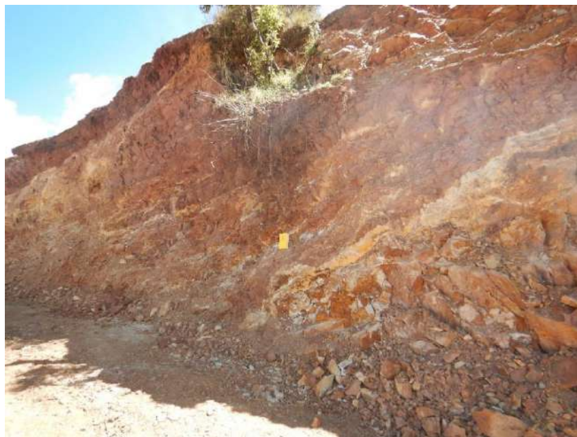
Fotografía 1. Vista con dirección al noreste, donde se observa el grado de fracturamiento en los niveles de areniscas de grano fino a medio, de coloración blanquecina, muy fracturado. Se encuentra en las coordenadas UTM 8431540 N, 705331 E con una altitud 3535 m s.n..m
