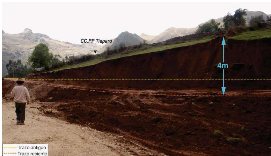
Figura 9. Se visualiza que la plataforma se asentó en 1m, como se muestra en la figura: línea amarilla trazo antiguo y trazo actual con línea naranja.
