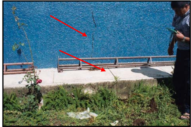
Foto 12.- Fractura en la pared y piso del centro de salud.
