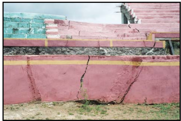
Foto 9.- Tribuna sur cerca de la entrada al coso taurino, muestra fracturamientos en sus paredes.
