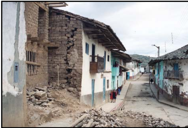
Foto 17.- Vivienda de la calle Miguel Grau, se aprecia la pared completamente asentada, que en cualquier momento podría colapsar.
