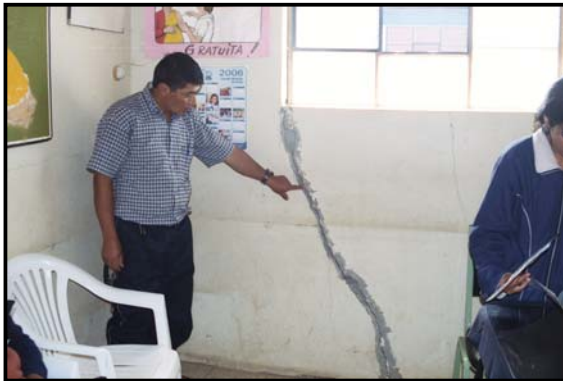
Foto 13.- Sala de Admisión del centro de salud, muestra la pared fisurada.
