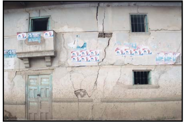
Foto 16.- Vivienda de la calle 24 de Junio, muestra los fracturamientos de sus paredes.
