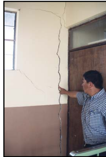
Foto 14.- Sala de hospitalización del centro de salud, se aprecia los fisuramientos en las paredes.
