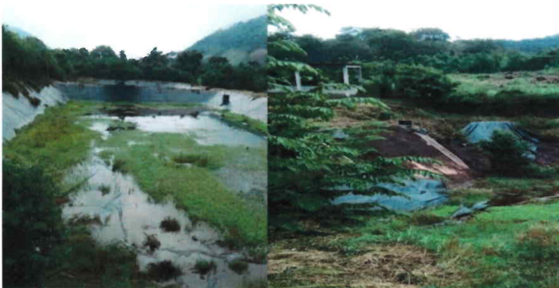
Fotografía 16. Redes de aguas servidas deterioradas en la ciudad de San Ignacio.
