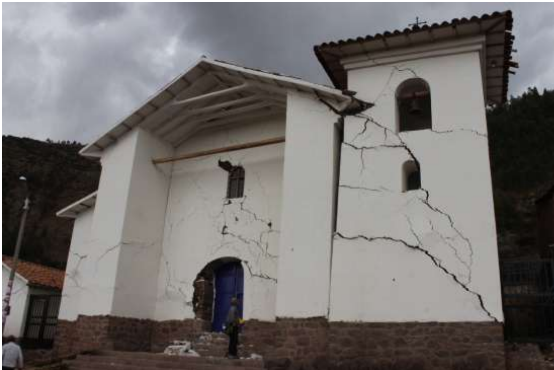
Fotos mostrando los daños en las viviendas y templo en Misca.
