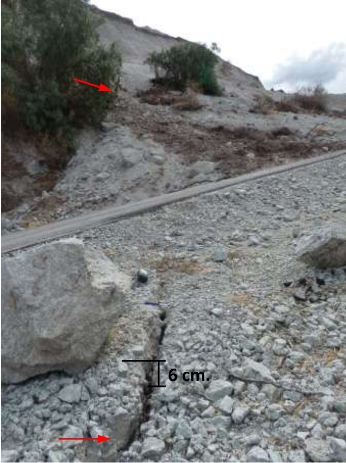
Foto 11: Grieta en la carretera Paruro – Accha, margen izquierda del río Apurímac, presenta una dirección N85°, una abertura máxima de 10cm y presenta un desnivel de 6cm hacia el norte. Se observa que la prolongación de la grieta termina en un deslizamiento.
