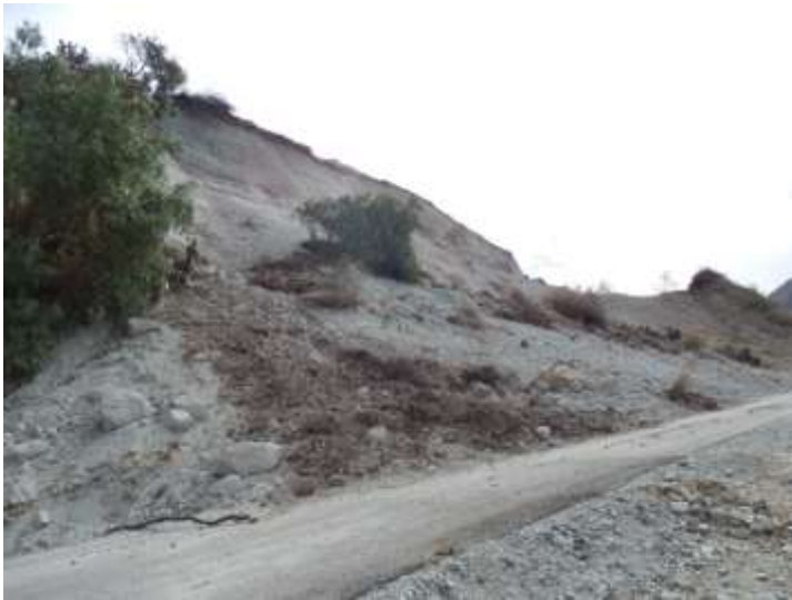
Foto 1: Deslizamiento en la carretera Paruro – Accha, margen derecha del río Apurímac.
