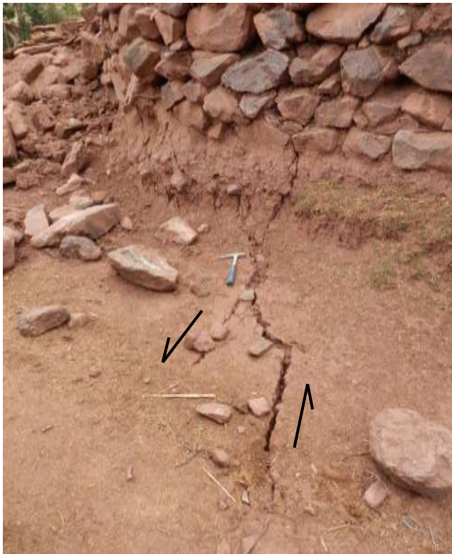
Foto 6: Grieta en el poblado de Miskas afectando el camino, un muro y una vivienda, presenta una dirección N65° y una abertura máxima de 10cm.
