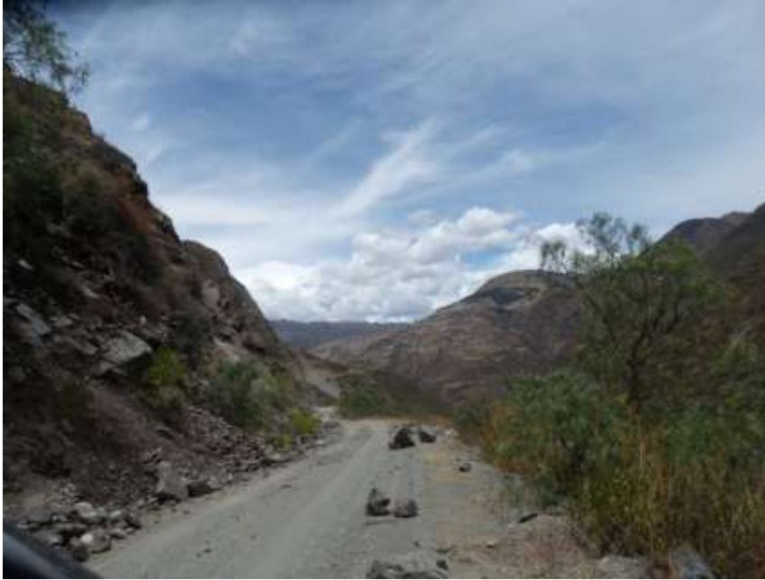
Foto 5: Caída de rocas en tramos de la carretera Cusibamba-Tincoc.
