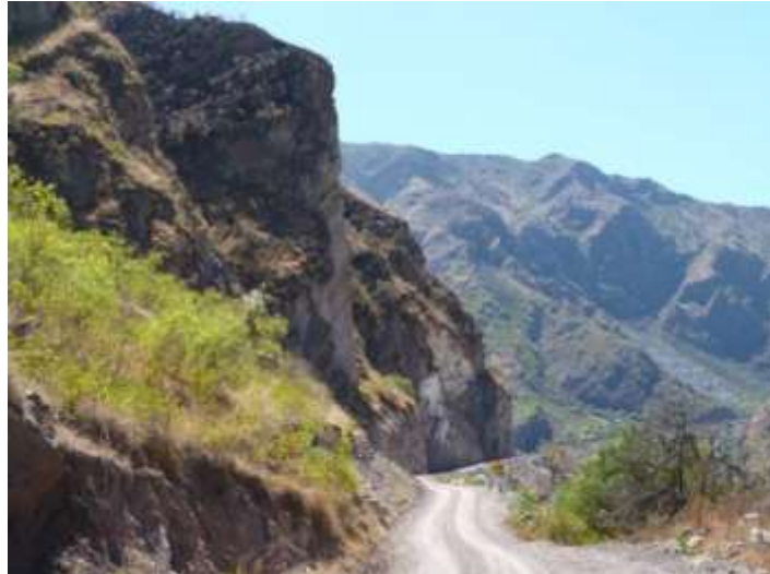
Foto 4: Talud de corte vertical de casi 40 m de altura, muy inestable, desde donde se produce la caída de bloques de roca y suelo.
