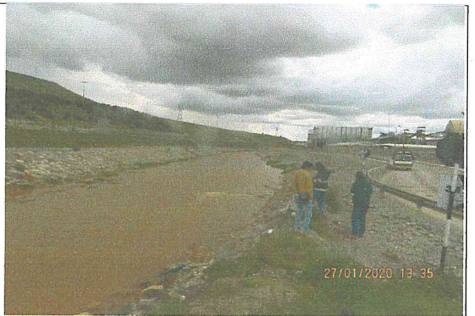
Fotografía 4: Erosion plataforma de carretera, margen izquierda del rio San Juan, sector Huaraucaca.
