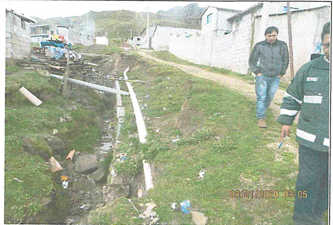
Fotografía 2: Exposición de tuberías de saneamiento en el cauce Cuyoc
