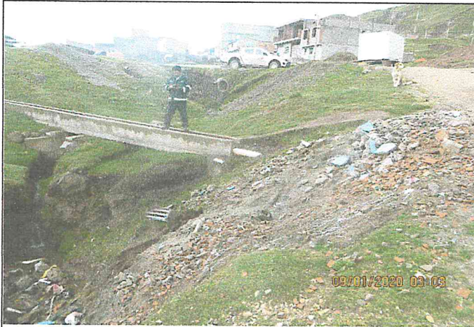
Fotografía 1: Quebrada Cuyoc, con residuos de material de construcción
