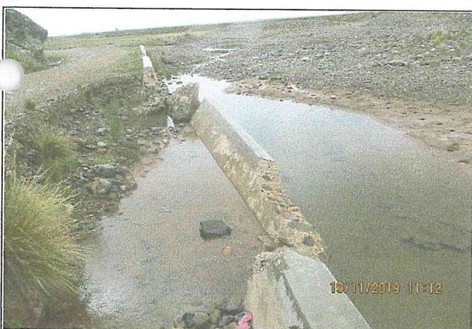
Fotografía 3: Daños del muro de contención y erosión de la plataforma de la carretera afirmada hacia Rumichaca, margen derecha del río Colorado - Sector Canchacucho
