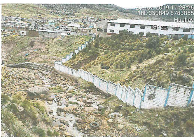
Fotografía 4: Colmatación, exposición a la socavación y deslizamiento del talud del río San Jose en el sector Huayllay
