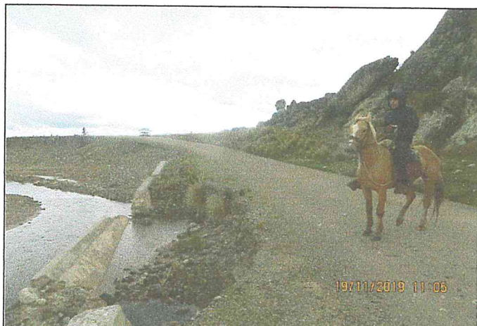
Fotografía 1: Daños del muro de contención y erosión de la plataforma de la carretera hacia Rumichaca, margen derecha del río Colorado - Sector Canchacucho
