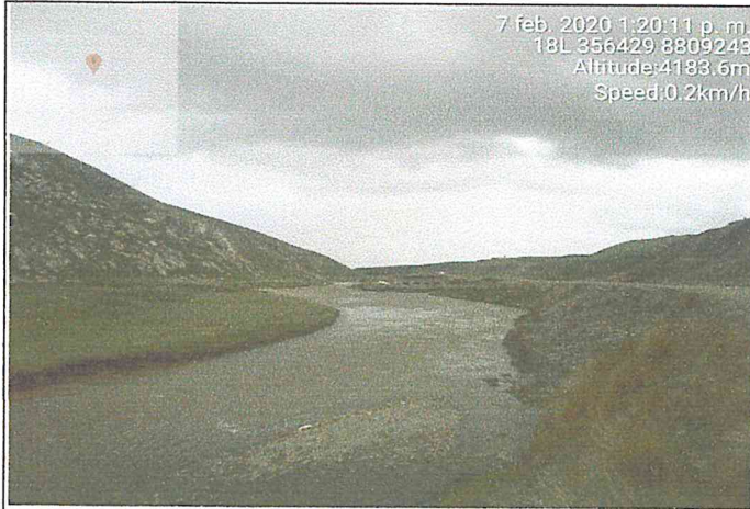
Fotografía 1: Rio San Juan colmatado en un 60%, erosion base plataforma carretera Huaraucaca Pasco.
