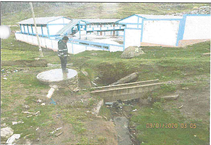
Fotografía 3: Exposición de buzón de desagüe, puente peatonal de la población del sector 14 de setiembre expuesta al peligro.
