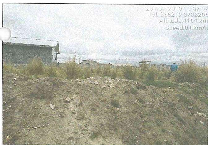
Fotografía 3: Peligro de deslizamiento del talud del río Anticona, en el sector Canchacucho.
