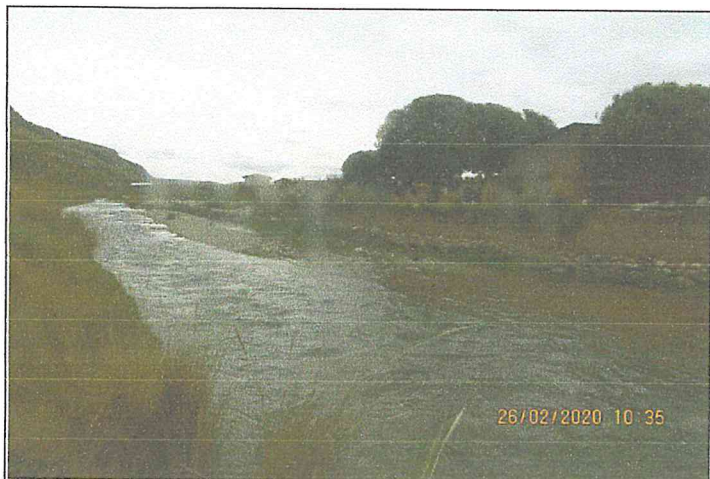
Fotografía 1: Rio Seco colmatado en un 70%, erosion base de construcciones, sector Ninacaca.
