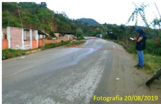
Figura 11: Asentamiento de la plataforma de la carretera en el sector Las Palmeras, con líneas rojas punteadas se muestran las grietas principales.
