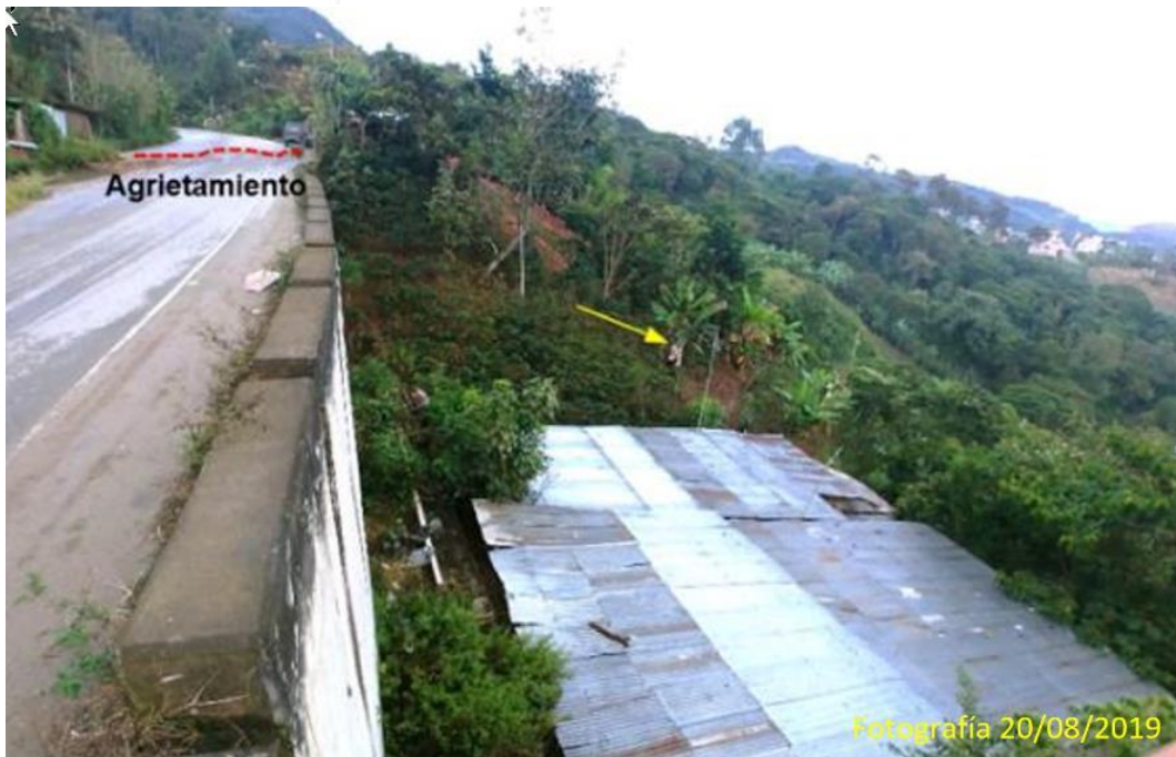
Figura 22: Vista del talud inferior de la carretera San Ignacio - Namballe, en el sector afectado por asentamiento de la plataforma.
