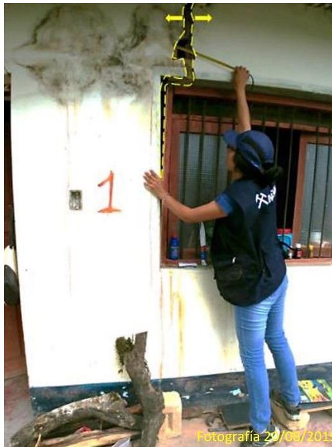
Figura 19: Agrietamiento en vivienda ubicada cerca al escarpe principal del deslizamiento. El grosor de las grietas varía entre 8 - 10 cm.
