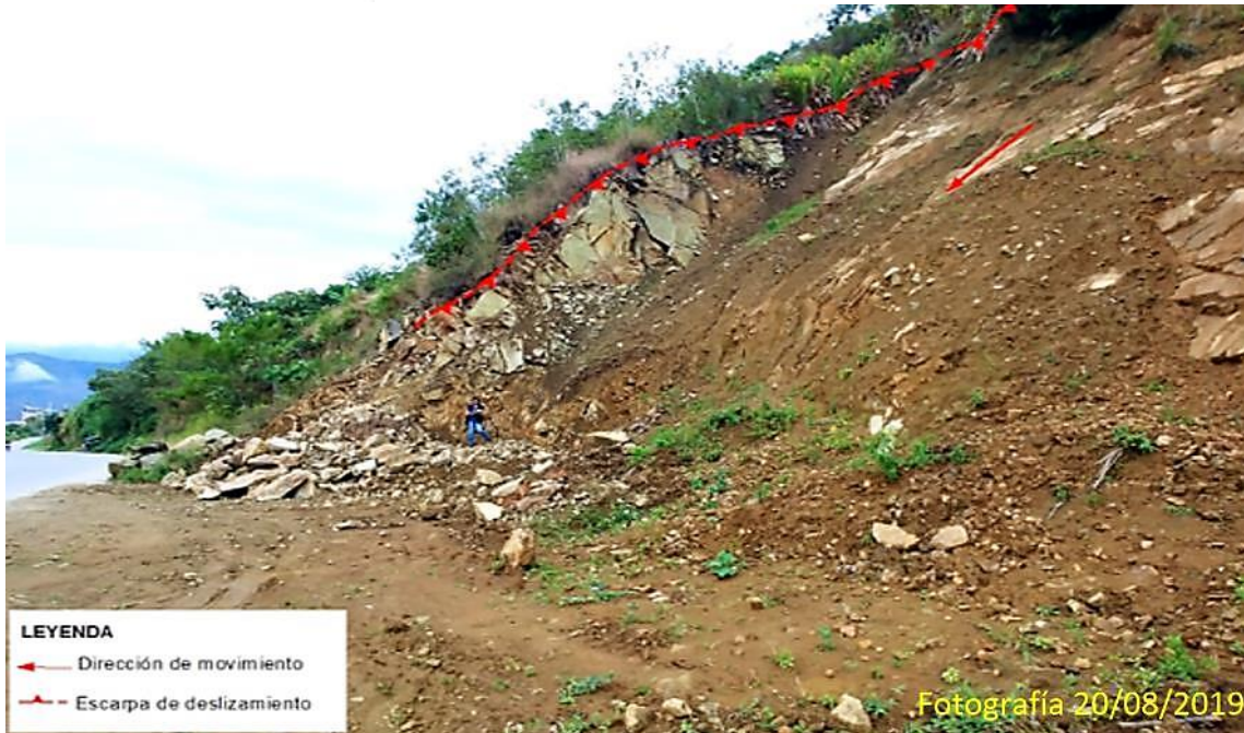
Figura 23: Vista del deslizamiento traslacional que se ha producido a lo largo del contacto entre suelo y roca, adviértase que existe una familia de juntas a favor del talud.
