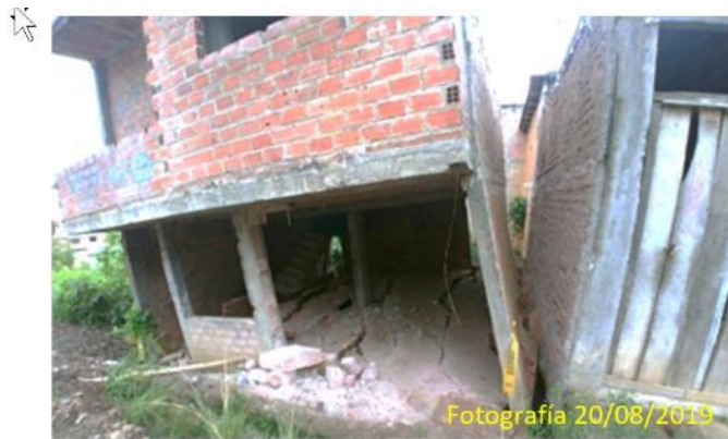
Figura 14: Vivienda en evidente colapso, las paredes están inclinadas y existen amplias grietas longitudinales y transversales. El terreno se encuentra saturado.
