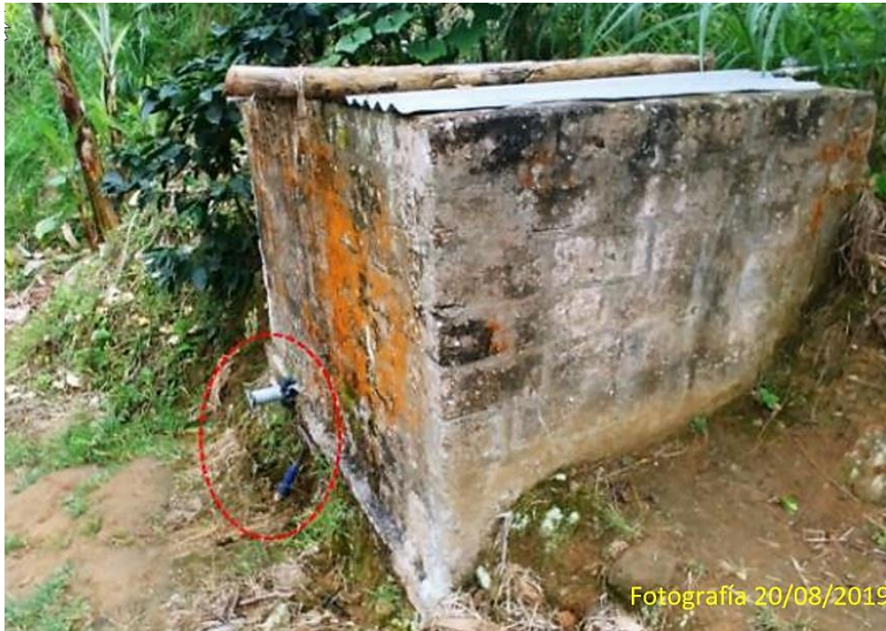
Figura 17: Tanque de almacenamiento de agua ubicado aguas arriba al deslizamiento. El rebose del mismo discurre libremente en el talud.
