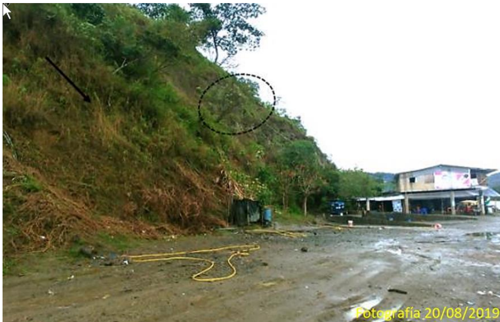
Figura 18: Zona destinada para el lavado de vehículos que no cuenta con sistema de drenaje, recubrimiento, ni pendiente adecuada para evacuar el agua utilizada durante la actividad, ocasionando anegamiento y saturación del terreno. Nótese el talud superior inestable.
