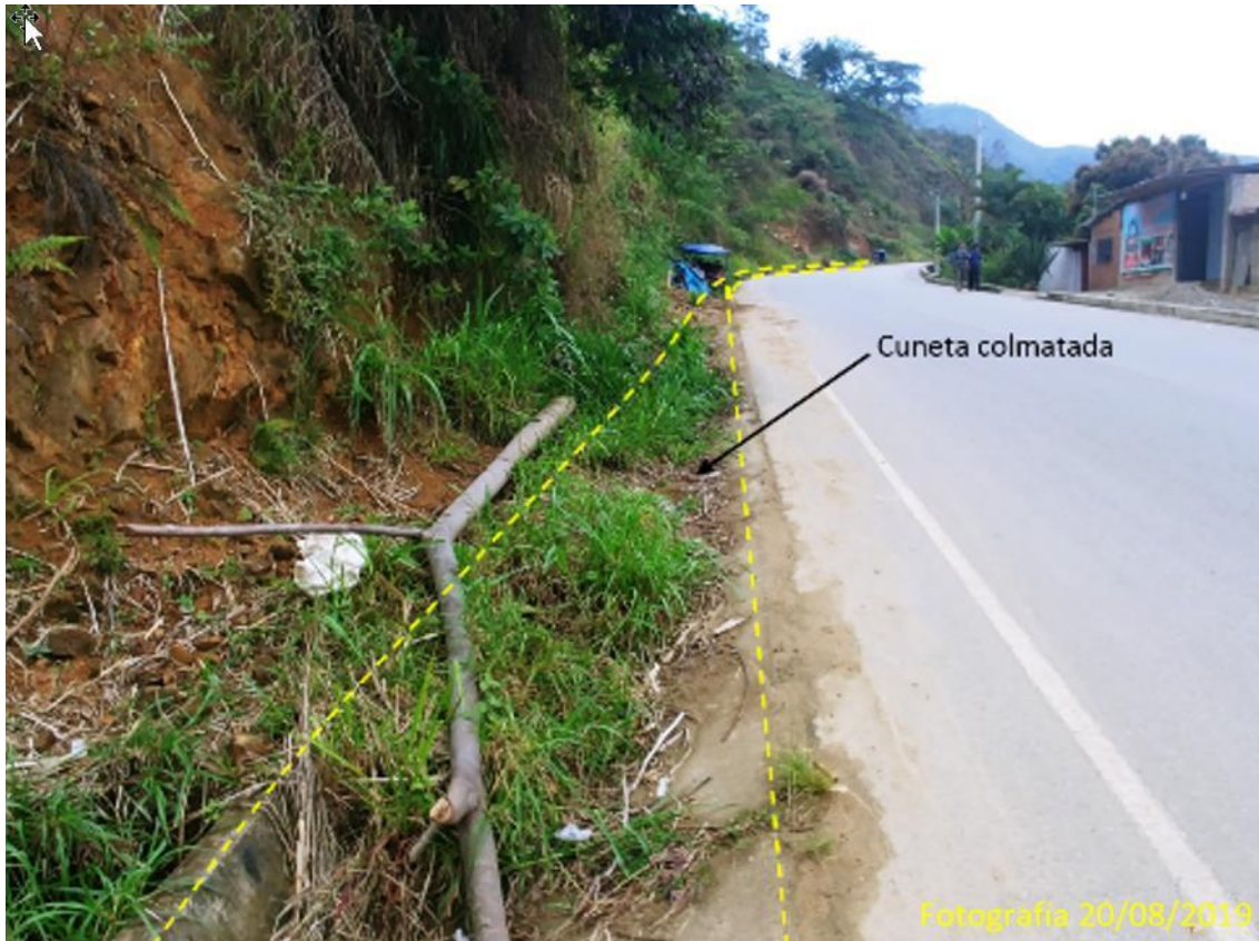
Figura 24: Cunetas colmatadas debido a la falta de mantenimiento, el agua de escorrentía discurre por la carpeta asfáltica.
