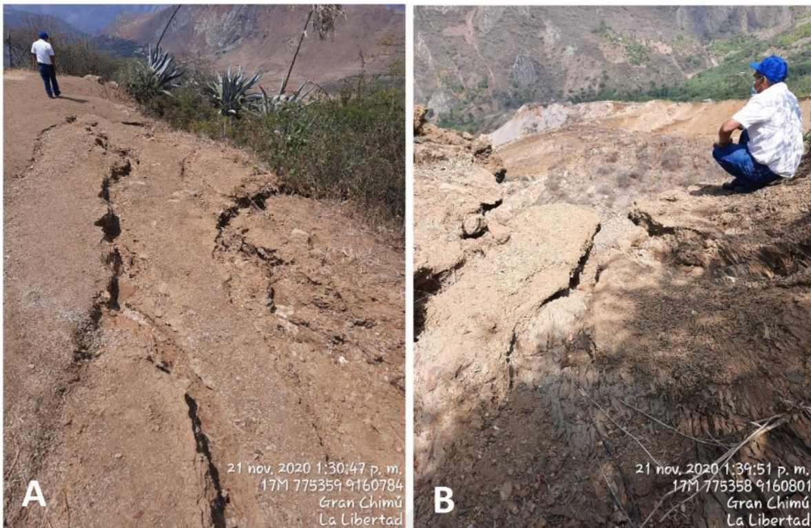
Figura 18. Los flujos de agua han generado socavamiento / cárcavas sobre las lutitas calcáreas sobre la cual se asienta el caserío de Sogón. Ya sean estas naturales o antrópicas (elaboradas como canales no revestidos para el riesgo de terrenos de cultivo). A) a 10 m de la escarpa principal del deslizamiento. B) flanco izquierdo del deslizamiento
