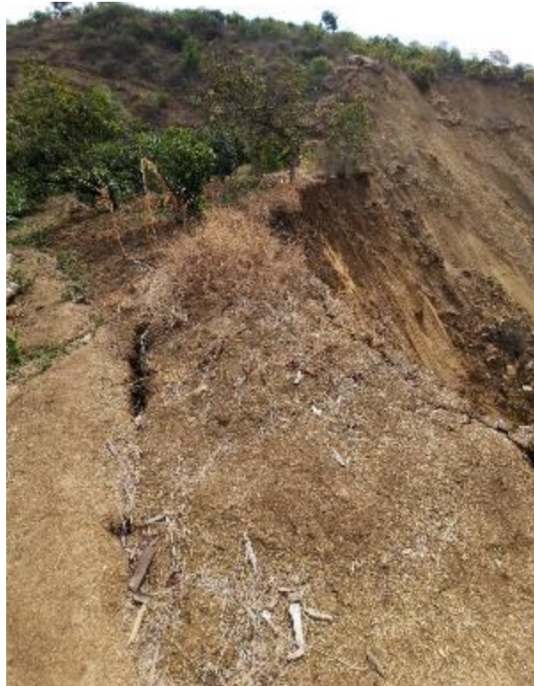
Fotografía 4. Agrietamientos con saltos de 20 cm en el flanco derecho del deslizamiento.
