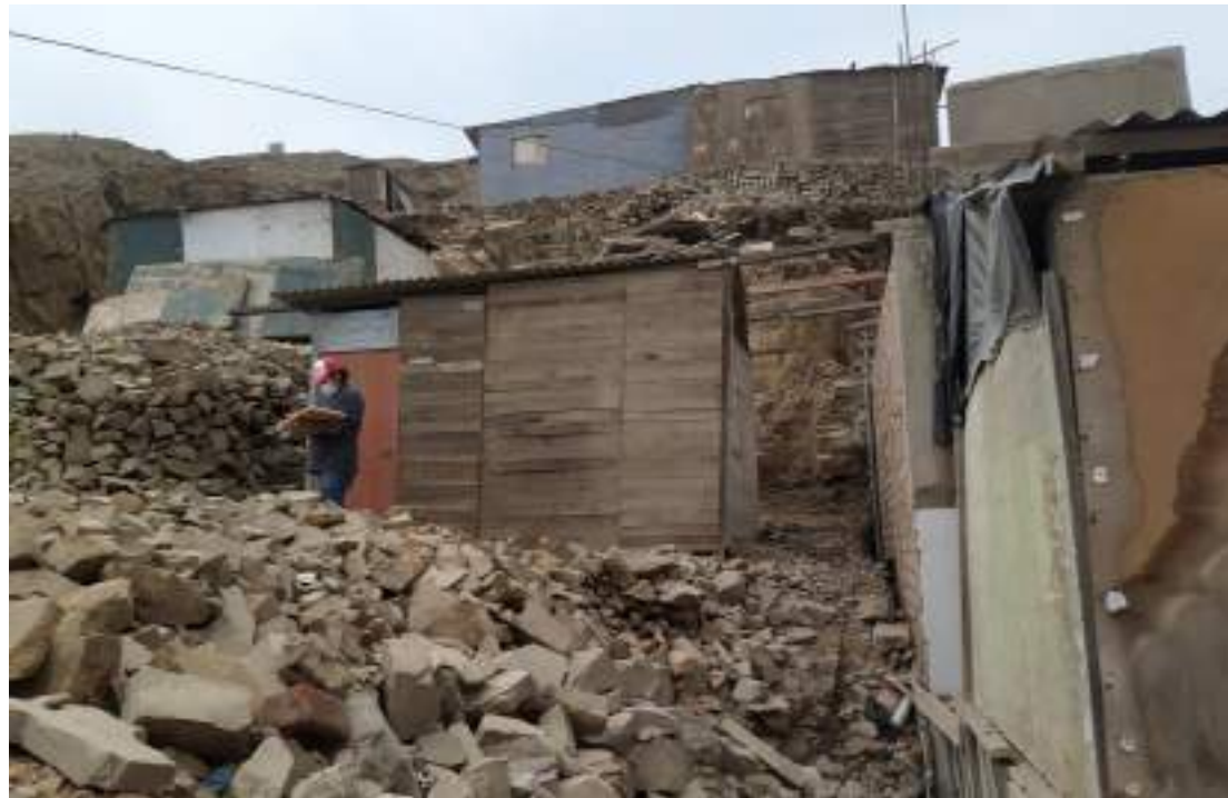
Vivienda de la Mz A' Lt 5 expuesta a deslizamiento de terreno lateral y posterior.
