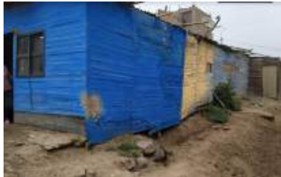
Vivienda de la Mz. A Lt. 15 donde se aprecia la base inestable.
