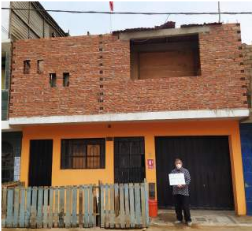
Vivienda de la Mz. D Lt. 16 donde se recomienda mejorar el confinamiento del muro del segundo piso. Imagen tomada desde la Calle 6.
