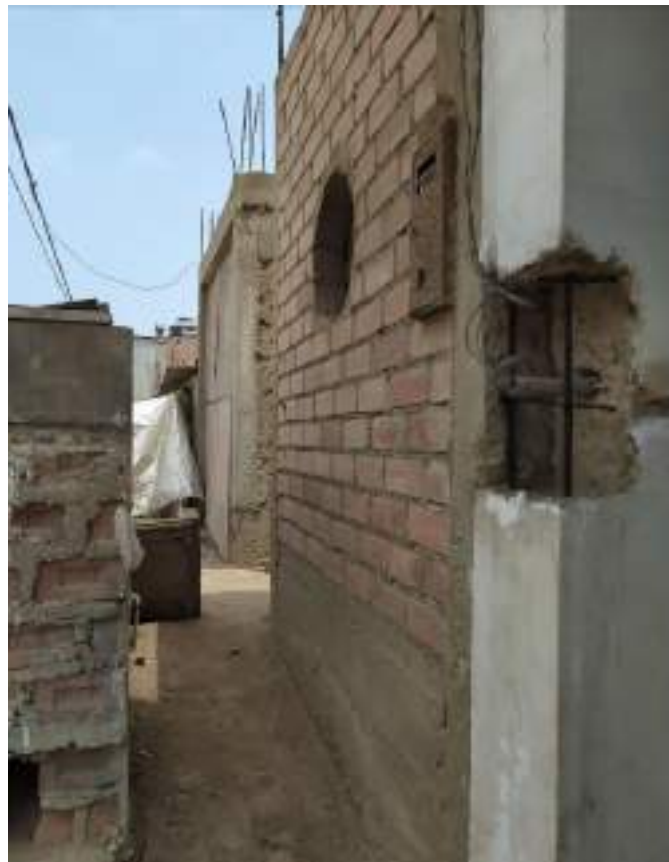
Vivienda de la Mz. E Lt. 20 donde se evidencia columna perforada.
