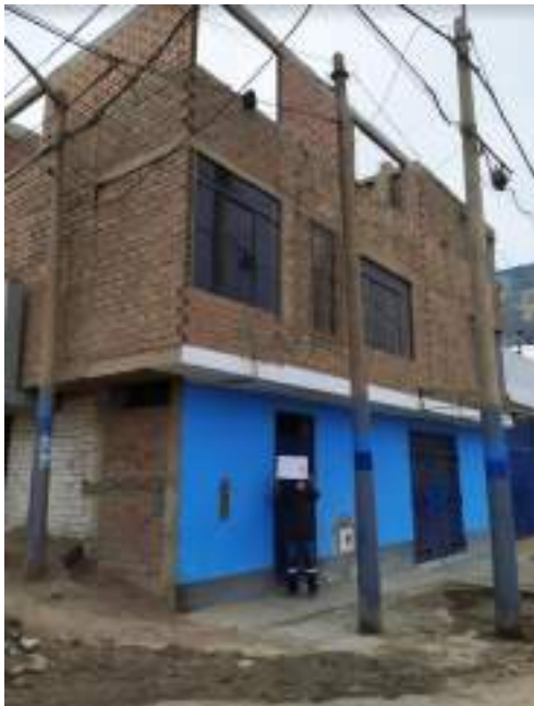
Vivienda de la Mz. A Lt. 4 donde se recomienda mejorar el confinamiento del muro del segundo piso.
