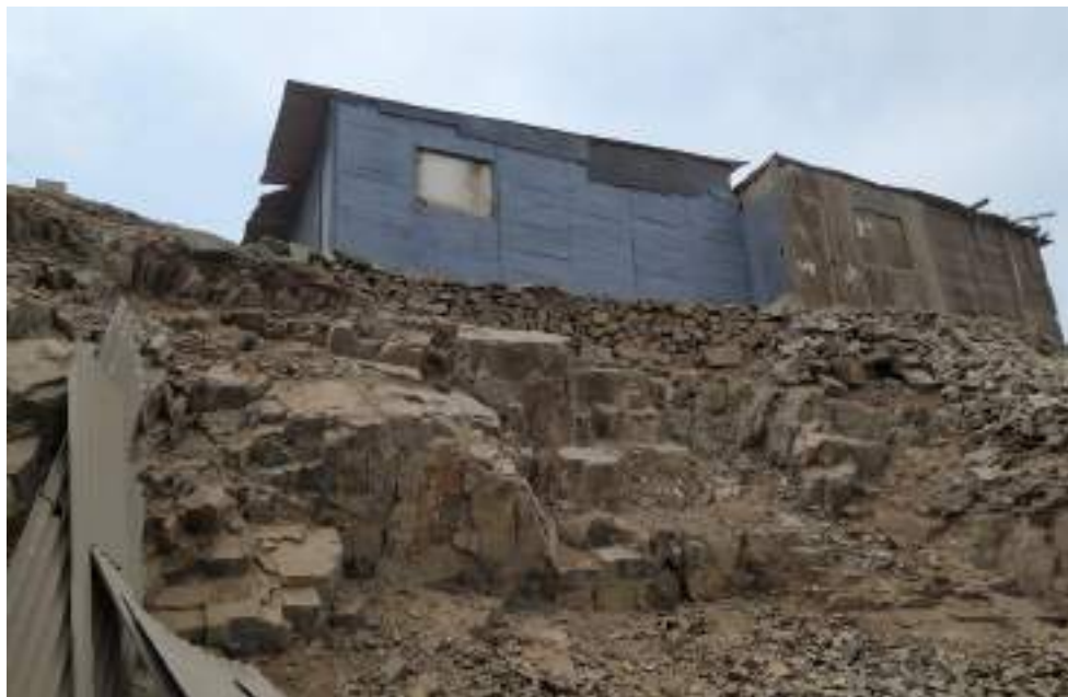
Vivienda de la Mz A' Lt 7 cerca a desnivel de terreno, imagen tomada desde parte baja.
