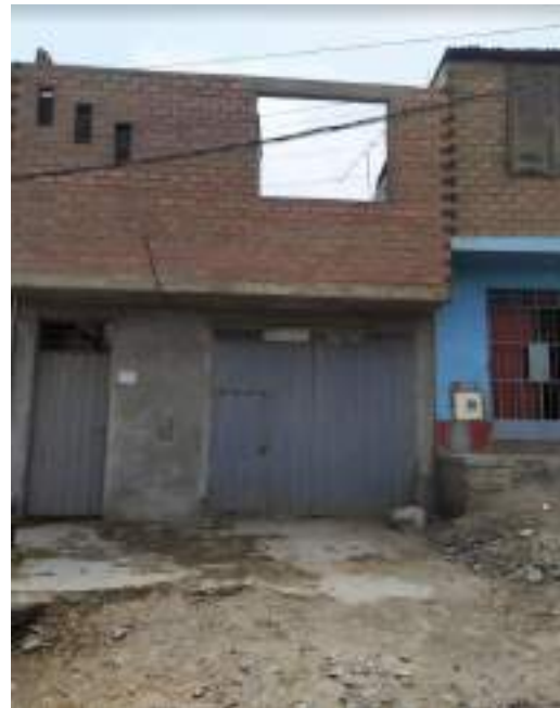
Vivienda de la Mz. A Lt. 31 donde se recomienda reforzar los muros del segundo nivel.
