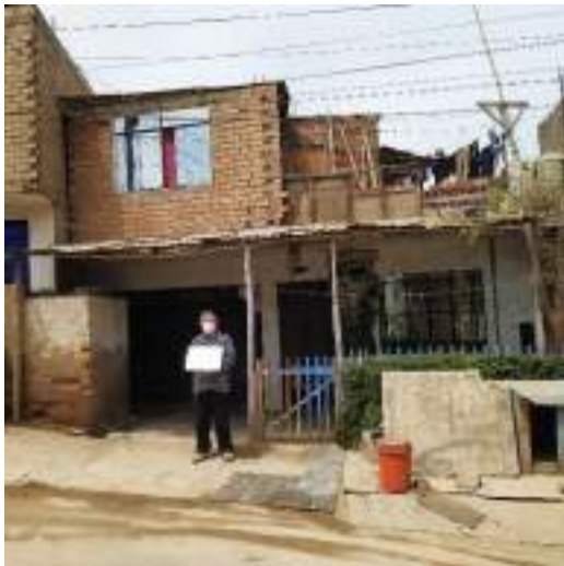
Vivienda de la Mz. D Lt. 4 donde se recomienda mejorar el confinamiento del muro del segundo piso. Imagen tomada desde la Calle 5.
