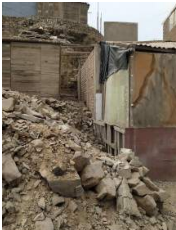
Mz ' It 4 con riesgo de derrumbe de tierra en la parte posterior de la vivienda.
