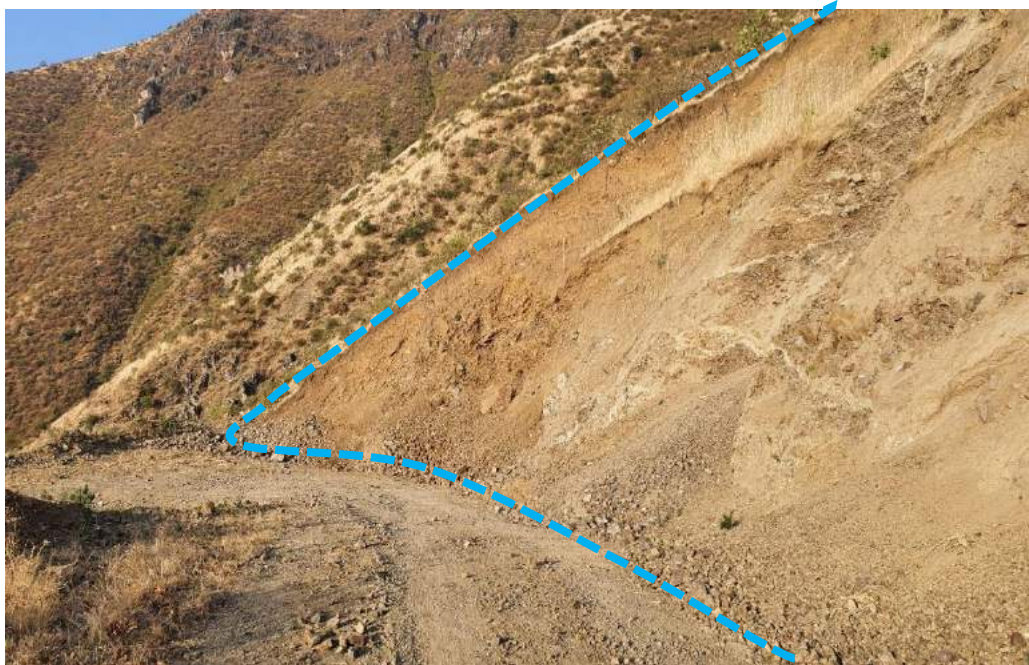
Imagen N° 21: Deslizamiento de rocas sobre la vía afectada.
