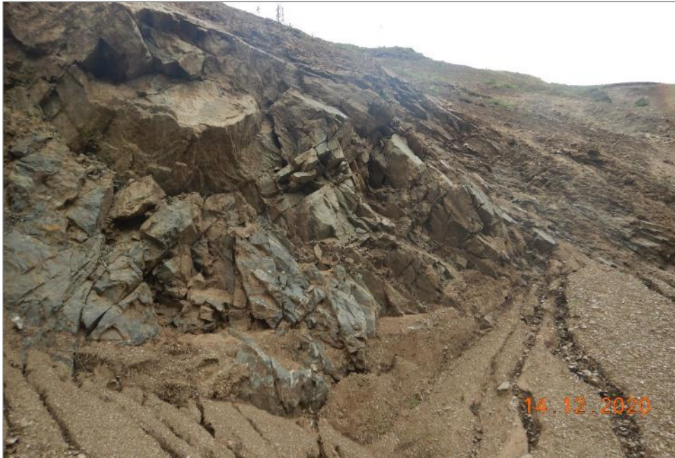
Fotografía 1. Vista de esquistos muy fracturados y moderadamente meteorizado en el nuevo trazo carretero (Sahuintuyoc) que conduce al sector Sahuayaco.
