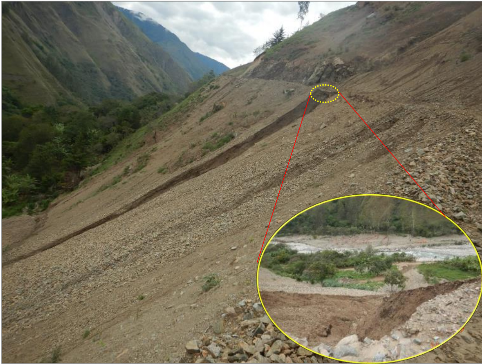
Figura 17. Zona de derrumbes debido al corte de talud realizado para el nuevo trazo del camino carrozable que conduce al sector Sahuayaco y pueblos aledaños. Con coordenadas UTM (WGS84): 759791 E, 8545143 N a 1687 m s.n.m.
