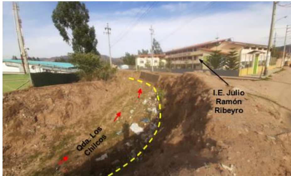
Figura 30. Cambio de dirección en el curso de la quebrada Los Chilcos, a la altura de la I.E. Julio Ramón Ribeyro (777235.99 E / 9204875.07 N), que podría inundarse en un evento extraordinario de lluvias. Nótese la construcción de un pequeño muro como barrera de protección ante la erosión fluvial.
