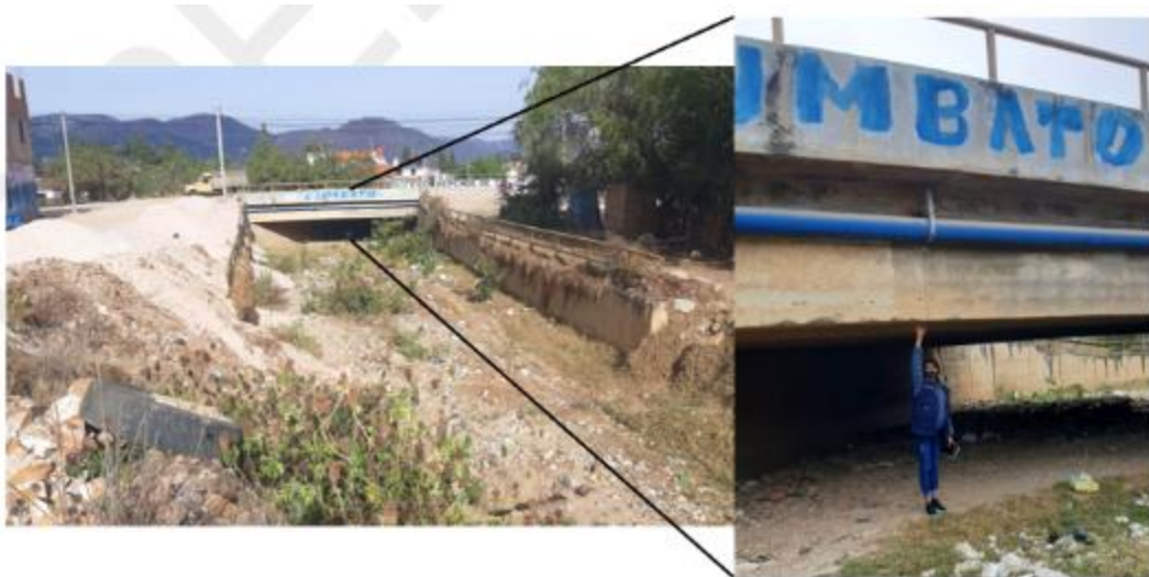
Figura 29. Intersección entre en la Avenida San Martín de Porres y la quebrada Los Chilcos (777060.57 E / 9205030.70 N), nótese la diferencia de altura, de tan sólo 2 metros, entre el cauce de la quebrada y el puente. Bajo estas condiciones, es probable que la estructura se obstruya con abundantes escombros o que el flujo rebasa la estructura, provocando inundación de las zonas aledañas.
