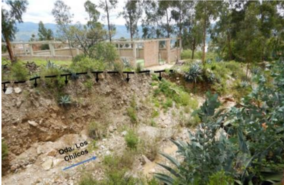
Figura 20: Derrumbe de suelos poco consolidados en la margen derecha de la quebrada Los Chilcos (775000.27 E / 9204668.91 N).
