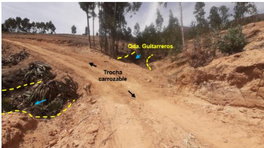
Figura 35. Obstrucción del cauce de la quebrada Guitarreros en su curso inferior (775550.55 E / 9203980.77 N). Nótese, la barrera cortando el cauce para la construcción de trocha carrozable.
