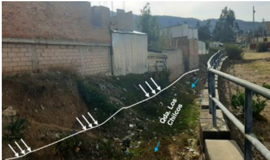
Figura 27. Peligro por erosión fluvial la quebrada Los Chilcos, margen derecha, se evidencia viviendas construidas al borde de la quebrada. Cauce colmatado por residuos sólidos (776819.11 / 9204910.99).
