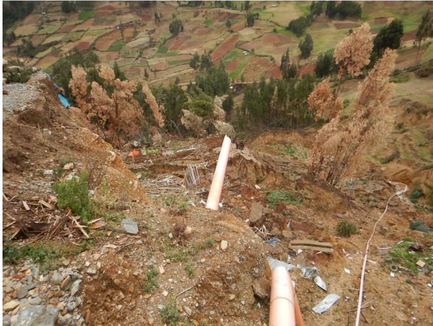
Fotografía 03. En las urbanizaciones Ortecho y California se identificaron vertimientos de desagües, los cuales generan el humedecimiento del terreno (margen izquierda de la quebrada Río Blanco).
