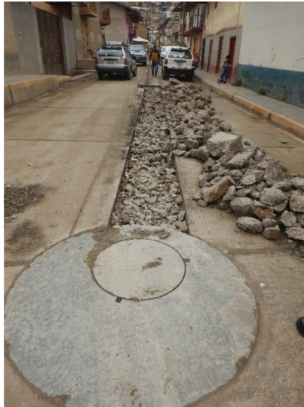
Fotografía 05. Vista de buzón de aguas residuales ubicado en la Av. César Vallejo, el cual posiblemente presenta problemas en el drenaje que genera infiltración en el terreno. Coordenadas UTM WGS84: 246787.9E; 9084785.3N.
