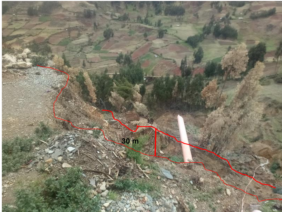
Figura 19. Vista actual de la zona de deslizamiento donde se observa la pérdida de aprox. 30 m de terreno en línea horizontal, dejando tuberías de drenaje expuestas. Coordenadas UTM WGS84: 246882E; 9084818N.
