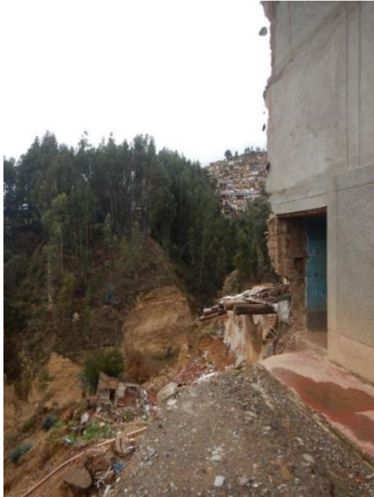
Fotografía 07. Vista de vivienda afectada e inhabitable por daños en su estructura, debido al deslizamiento activo en la margen izquierda de la quebrada Río Blanco. Coordenadas UTM WGS84: 246908.6E; 9084871.7N.
