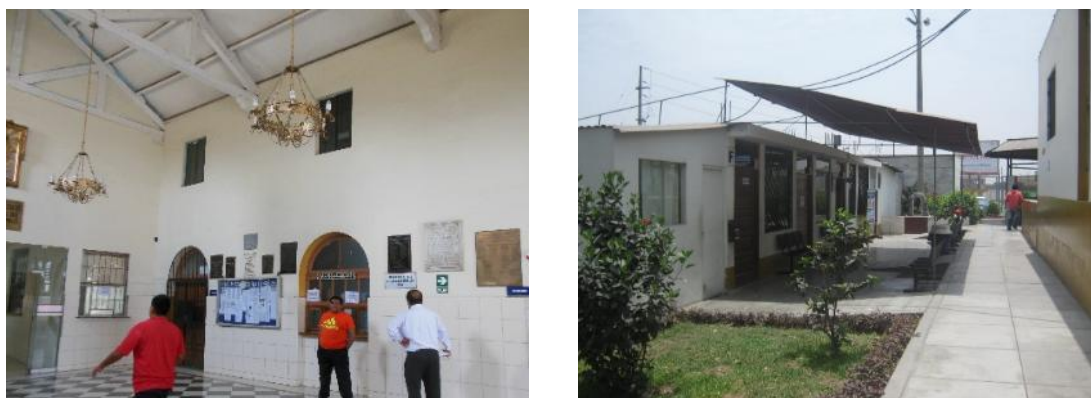
Figura 41. Los techos de material prefabricado se encuentran en regular estado de conservación, estos requieren de mayor mantenimiento y de un soporte estructural eficiente.
