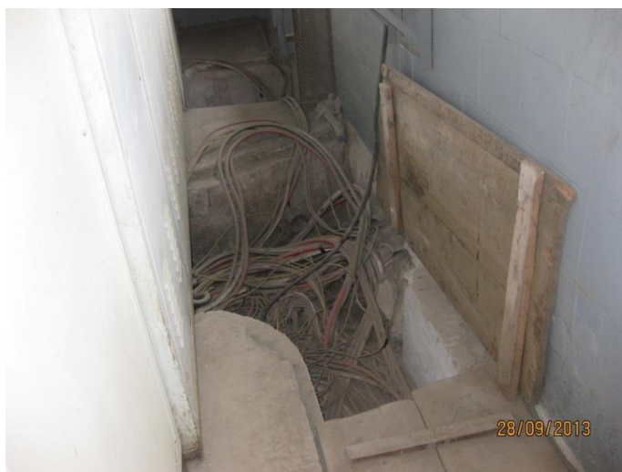
Figura 62. Instalaciones eléctricas desordenadas pueden producir cortocircuitos
