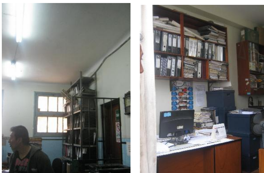
Figura 58. Mobiliario no asegurado adecuadamente, reja de salida en sentido contrario a la ruta de evacuación.
