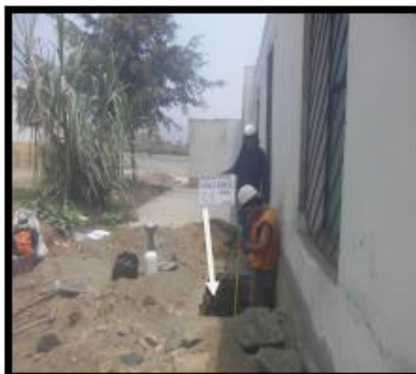
FOTO N° 2 OTRA VISTA DE UBICACIÓN DE AUSCULTACION DE LA CIMENTACION POR MEDIO DE CALICATA C-1
