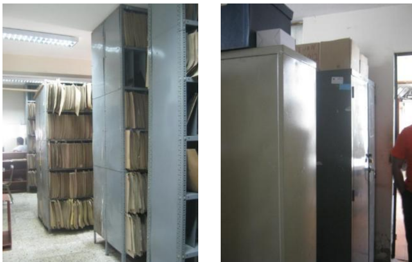
Figura 30. Armario y estanterías no fijados a pared, piso o techo, tienden al volcamiento en casos eventuales. Otro factor, es el desplazamiento de los contenidos por no estar asegurados. Asimismo, se aprecia sobrecarga por apilamiento adicional de objetos sobre las estanterías o por cargas que sobrepasan la capacidad máxima del elemento.
