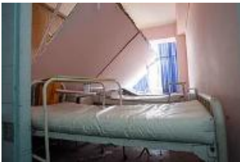
Figura 3. Tabiques no asegurados adecuadamente, corren el riesgo de deformaciones o caídas ante eventos adversos.
