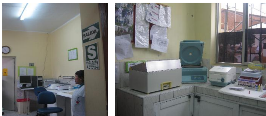
Figura 53. En laboratorio los equipos biomédicos e informáticos se encuentran colocados sobre la mesa y no están asegurados, asimismo las ventanas son de vidrios crudo, riesgo de rotura en caso de movimiento sísmico.
