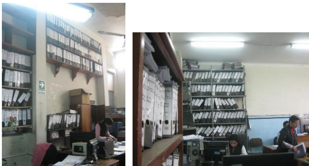
Figura 57. En Contabilidad estanterías con contenido que no están asegurados, por el movimiento sísmico pueden caer.
