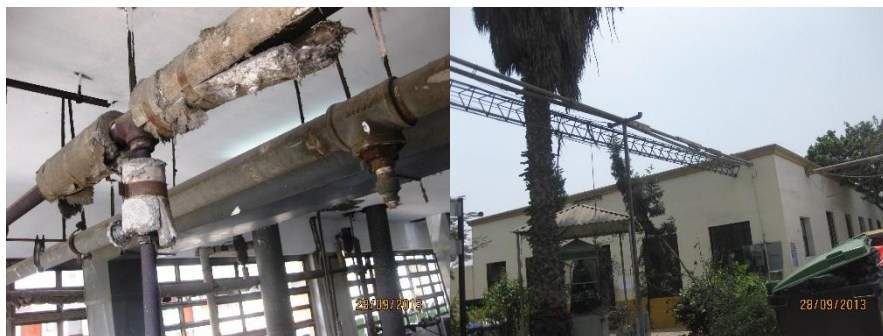
Figura 65.- Tuberías de vapor expuestas sin aislamiento térmico
