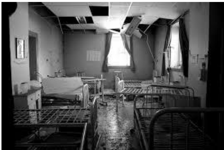
Figura 9. Luminarias no sujetadas adecuadamente en techo ante movimientos sísmos, se caen e incrementan el peso del falso cielo raso provocando colapso del sistema.
