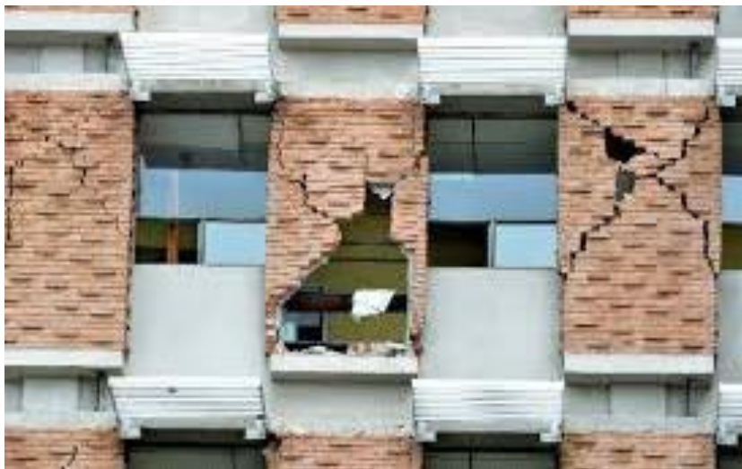
Figura 4. Baldosas en fachadas, que se desprenden por efecto de sismos intensos
