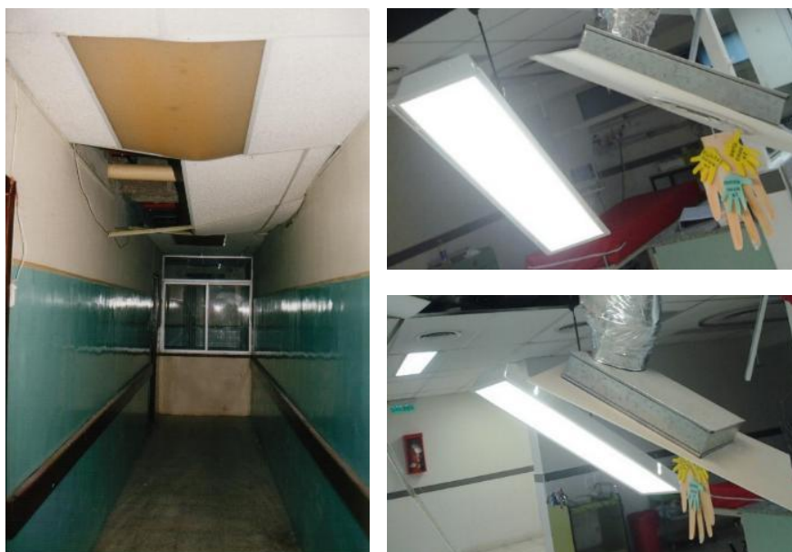
Figura 5. Falsos cielos rasos se desprenden por deficiencia en anclajes ante movimientos sísmicos
