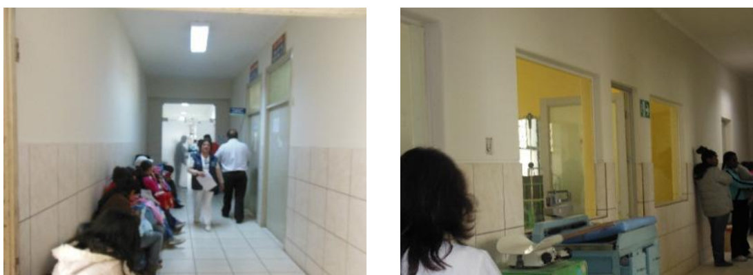
Figura 43. Las circulaciones internas no cuenta con señalética debidamente exhibida, a ello se suma, la presencia de mobiliario o equipamiento ubicado en la circulación obstruyendo el paso y salidas en casos imprevistos.
