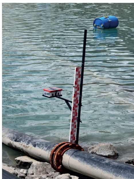
Foto 3. Sensor de medición de nivel de agua instalado
