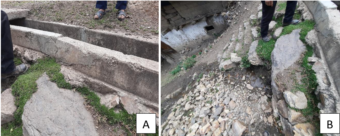
Fotografía 12 A) Agrietamientos en un tramo del canal de irrigación. B) Las aperturas de las grietas del canal de irrigación generan filtración de agua y unos nuevos flujos de agua sobre el poblado de Cajas.
