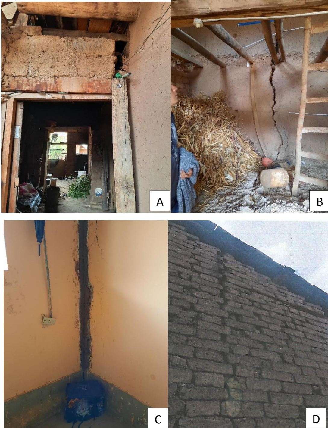
Fotografía 15. Estado actual de las viviendas de adobe en el centro poblado de Cajas. A) Presencia de aperturas de 30 cm. B) Agrietamientos longitudinales en la pared. C) Aperturas de 20 cm en las juntas del adobe. D) Separación de adobes, con aperturas de 10 cm, por asentamientos en el pueblo de Cajas.
