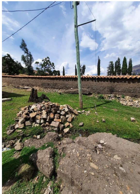
Fotografía 13. Inclinación del poste de alumbrado público por asentamientos.
