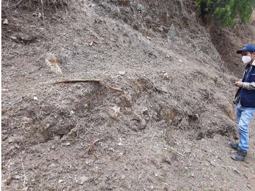
Fotografía 9. Presencia de saltos y grietas en la parte alta de Cajas.
