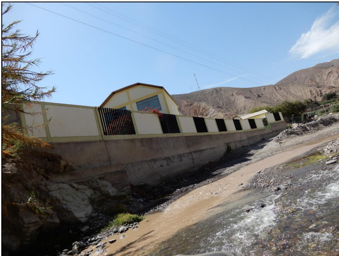
Figura 25. Punto crítico afectado por las aguas del río Ilabaya (coordenadas UTM E: 339435, N: 8073319).
