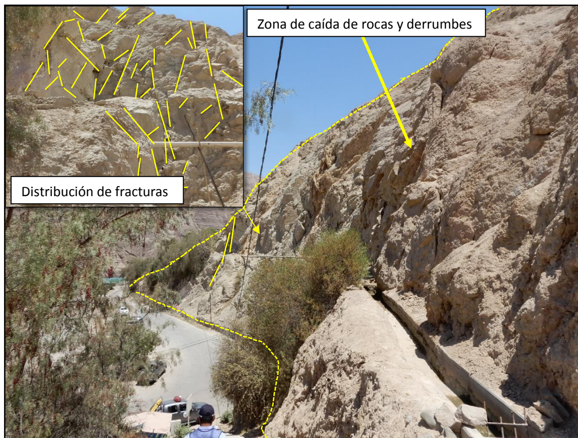
Figura 14. Caída de rocas en la margen derecha del río Colocaya, en la entrada a Ilabaya Capital (coordenadas UTM E: 339304, N: 8073129).
