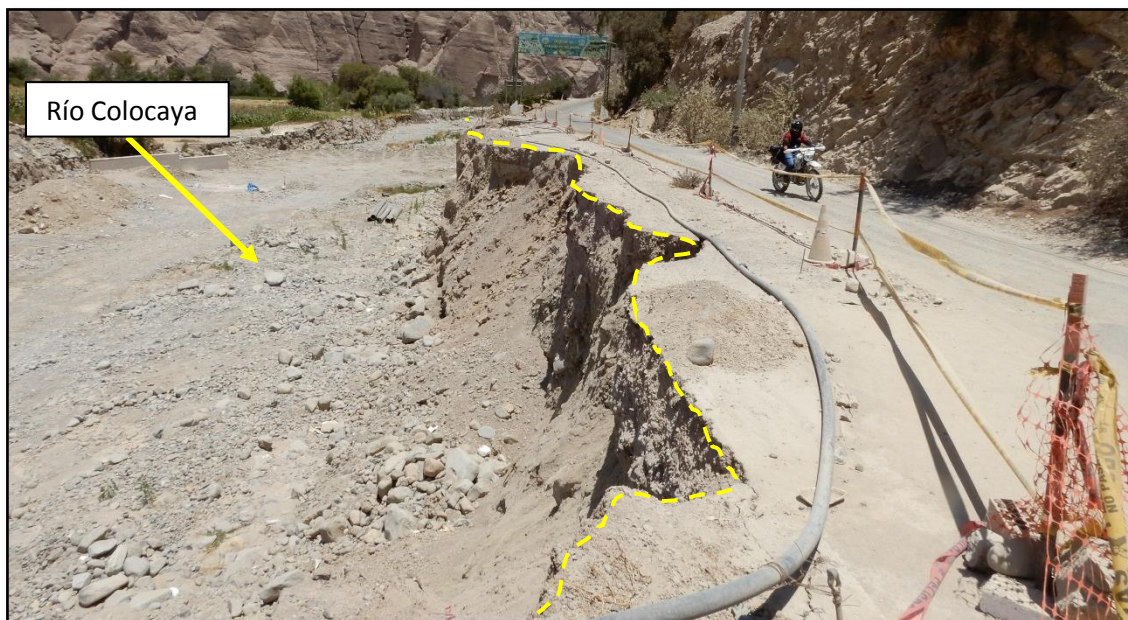
Figura 9. Vía afectada en Ilabaya por la erosión fluvial del río Colocaya en el 2020 (coordenadas UTM E: 339354, N: 8073135).
