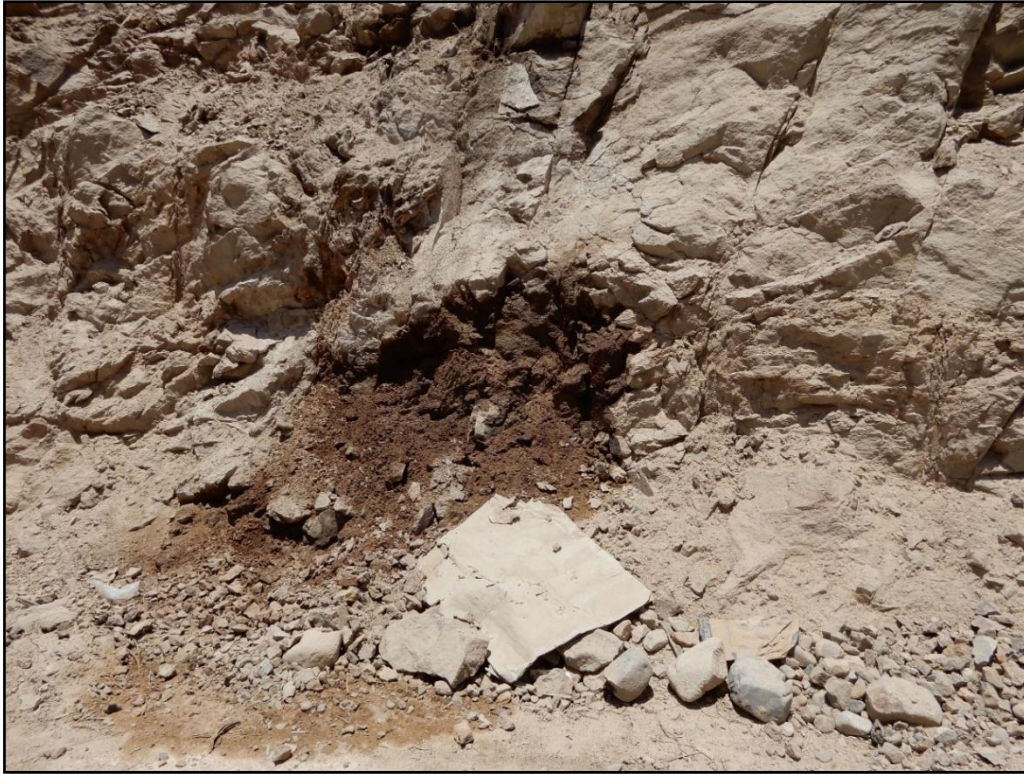
Figura 24. Surgencias de aguas en los cortes de la carretera en el sector Alto Ilabaya (coordenadas UTM E: 339297, N: 8072693).
