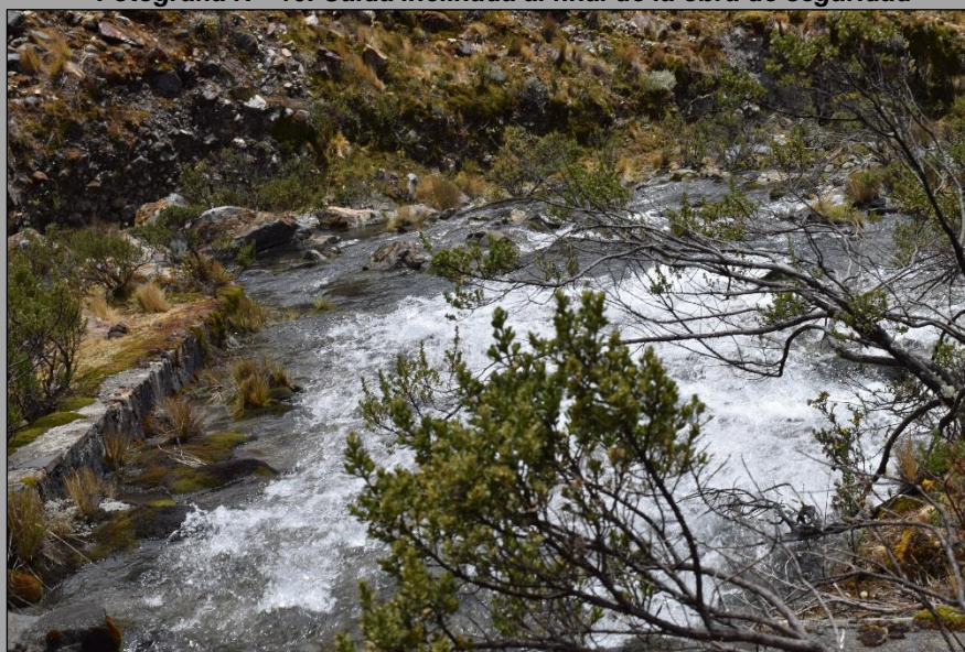
Fotografía N° 10. Caída inclinada al final de la obra de seguridad
