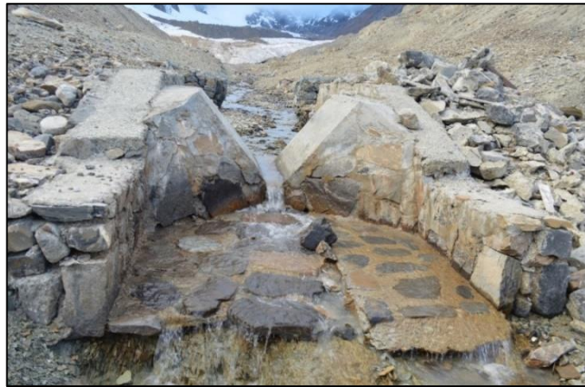
Fotografía N° 01.- Vista de las condiciones actuales del vertedero ubicado en el lado de la cuenca del río Rímac.
